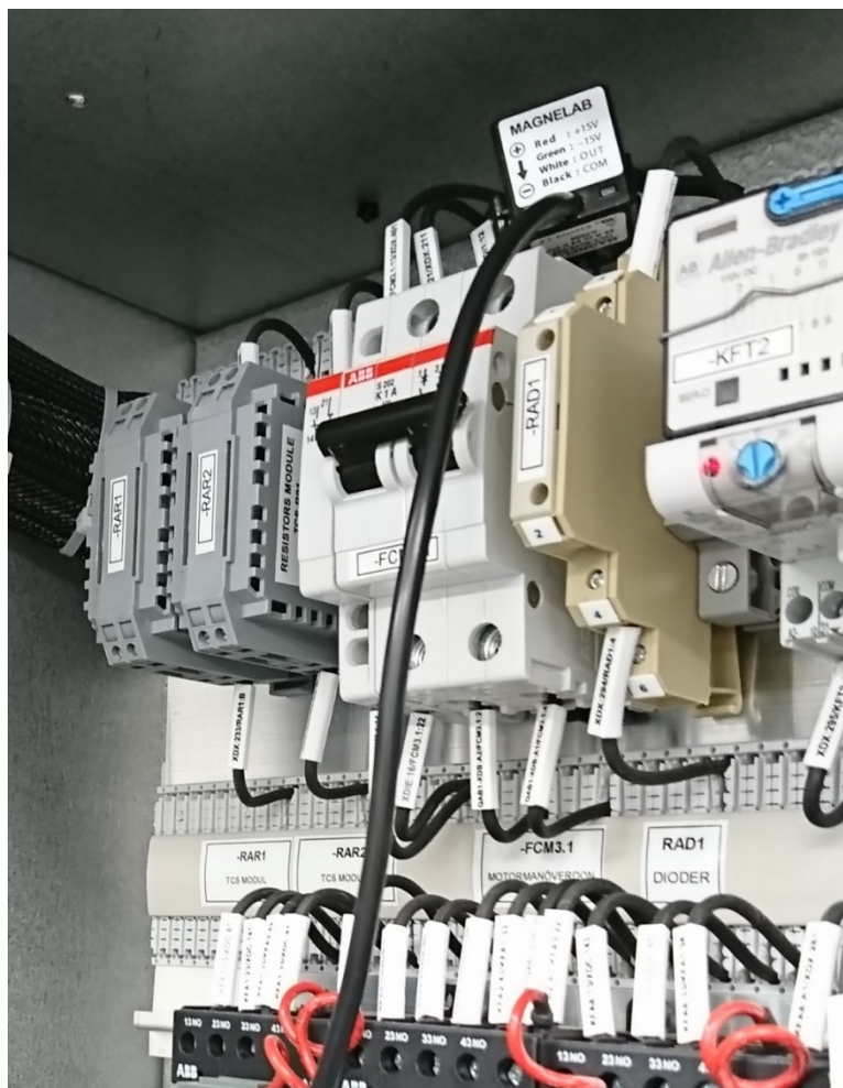
Figur 8: Strömgivare installerad i lågspänningsutrymmet i ställverksfack för att mäta strömmen till brytarens fjäderspänningsmotor
