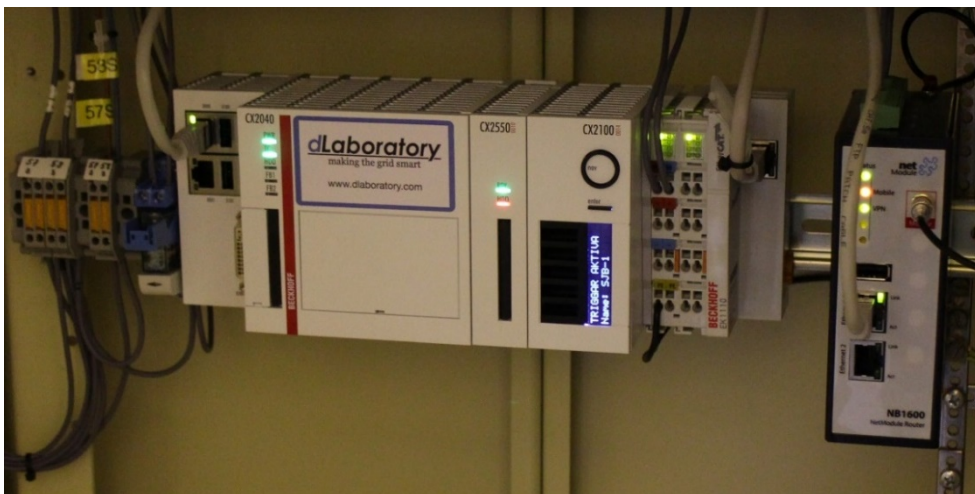
Figur 25: Huvudenhet i transformatorstationen, visad med router för VPN-uppkoppling
