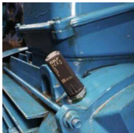
Figur 4.2 Sensor för kontinuerlig övervakning med trådlös överföring
