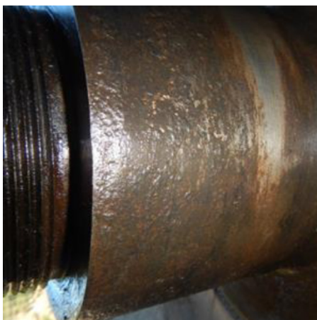
Figur 6.5 Den skadade lagertappen
