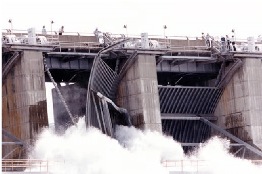
Figur 2.2 Haveri av segmentlucka vid Folsom dam Kalifornien 1995.
