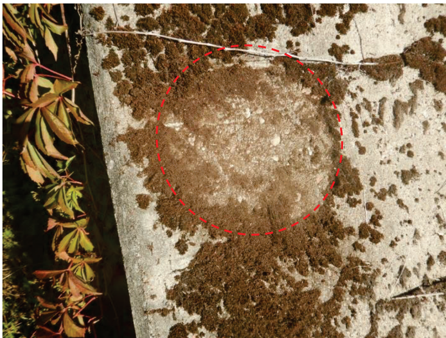
Figur 3-7. Delvis borttagen mossor på lutande yta vid nedströmssidan av en damm. Frilagd ballast syns endast vid området där mossan är borttagen från betongytan (markerat med en röd streckad cirkel).
