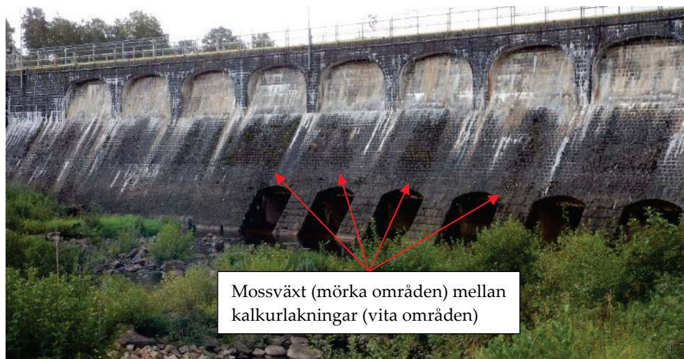
Figur 3-4. Mossa på lutande stensättning vid nedströmssidan av en damm där det inte har runnit något kalkhaltigt vatten till följd av kalkurlakning (vita områden).
