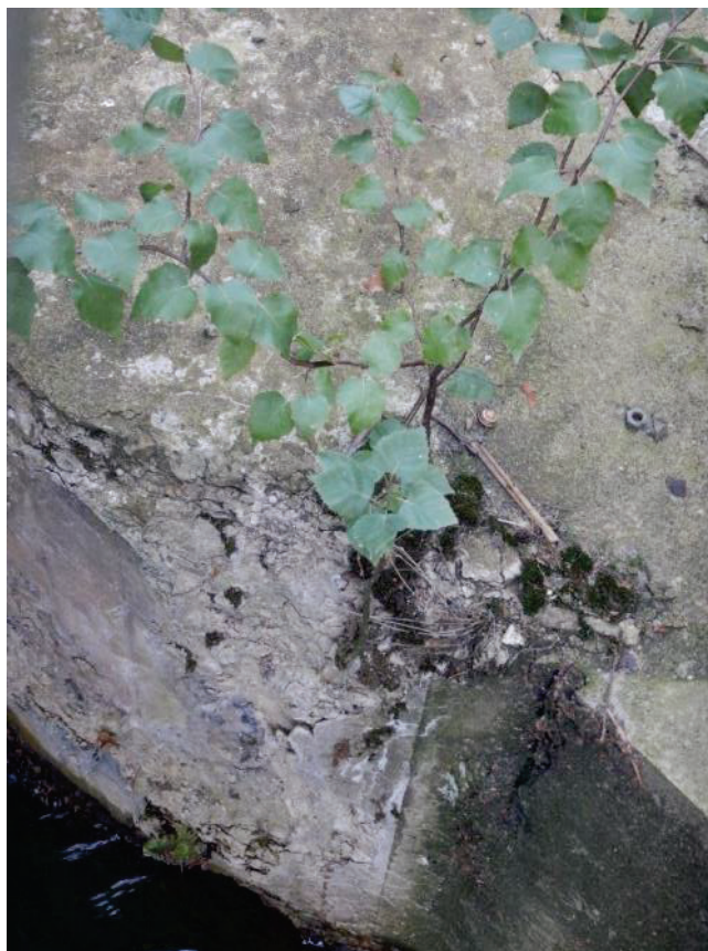
Figur 3-21. Björk på uppströmssidan av en damm.
