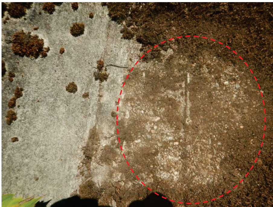
Figur 3-10. Delvis borttagen mossa (markerat med en röd streckad oval) på lutande yta vid nedströmssidan av en damm. Under den borttagna mossan syns frilagd ballast.
