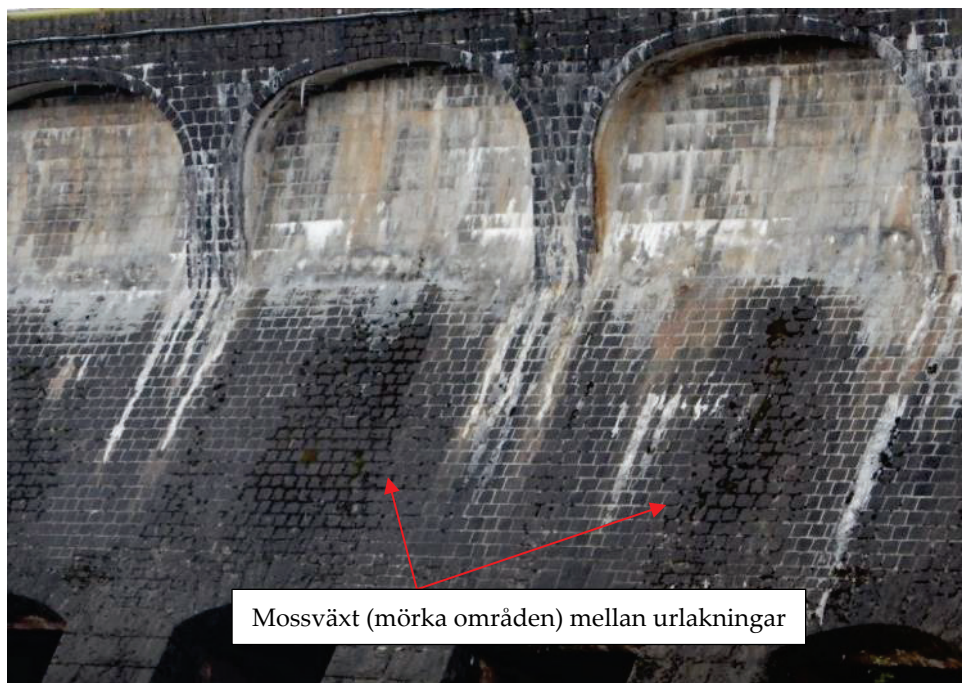
Figur 3-5. Mossa på lutande stensättning vid nedströmssidan av en damm där det inte har runnit något kalkhaltigt vatten till följd av kalkurlakning (vita områden).
