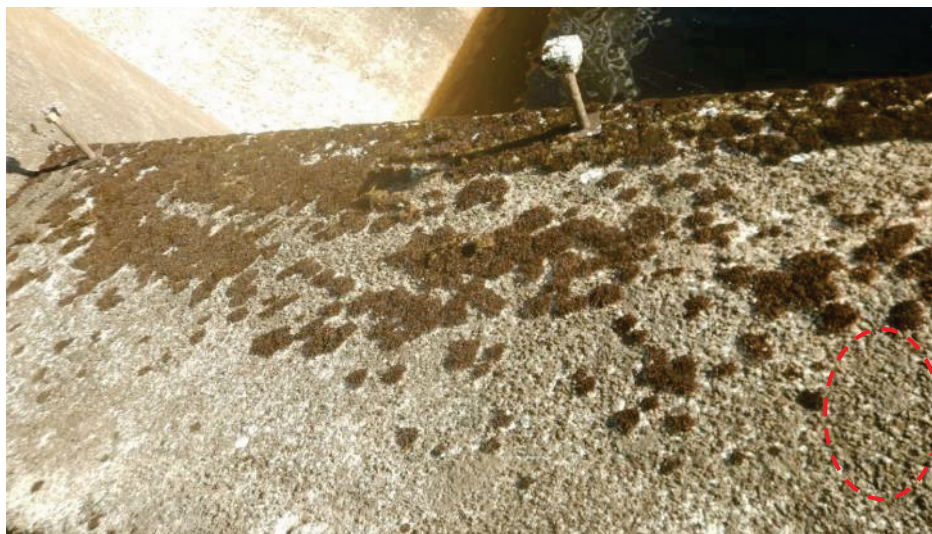
Figur 3-11. Mossa på horisontal yta vid nedströmssidan av en damm. Runtomkring mossan syns att cementpastan verkar påverkats av en ytlig attack där helt eller delvis frilagd ballast syns.
