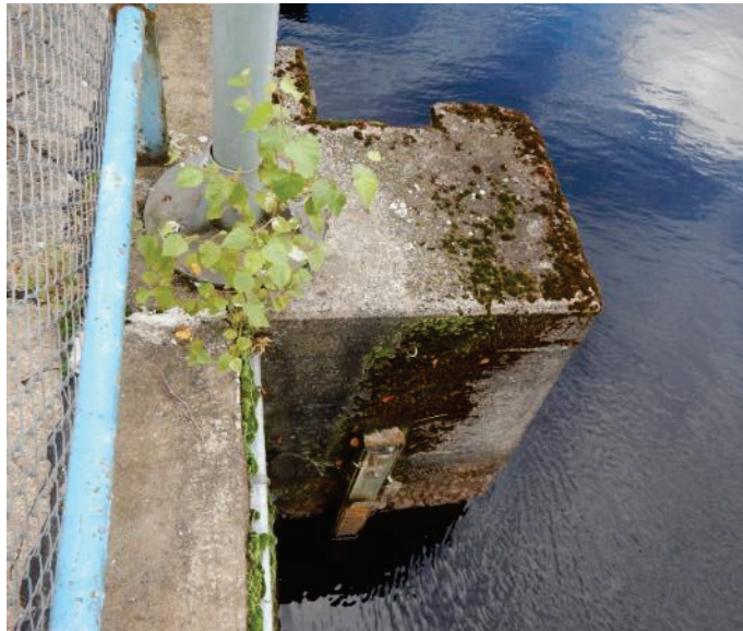
Figur 3-20. Björk på uppströmssidan som växer i en fog på uppströmssidan av en damm.
