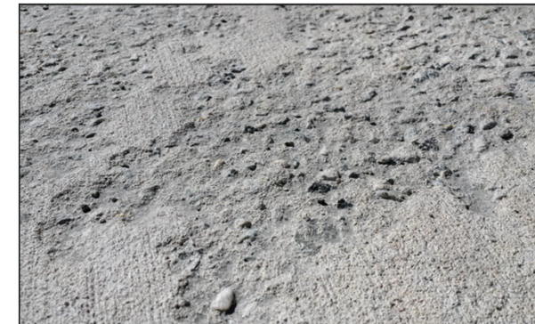
Ytavskalning orsakad av saltfrostangrepp
