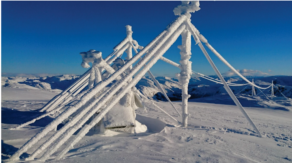
Figur 5: Exempel på is och snöpåbyggnad (Foto: Statnett)
