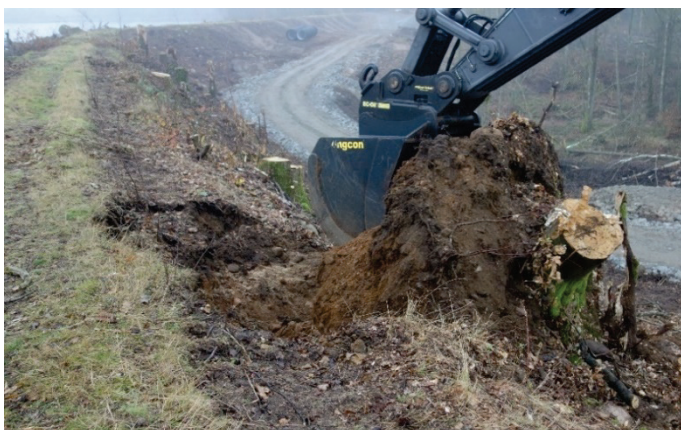
Figur 57 Uppgrävning av bokstubbe i nedströmsslänten med stamdiameter 45 cm
