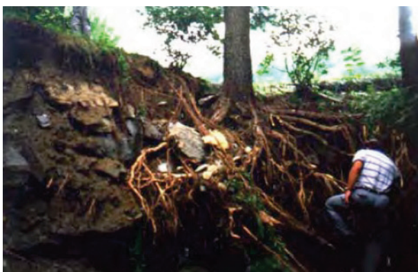
Figur 6 Skador i krön och nedströmsslänt orsakat av trädrötterna på en damm i USA (från FEMA, 2005)
