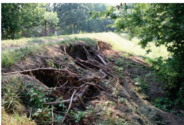
Figur 8 Erosion i anslutning till trädrötterna på en dam i USA. Dammen hade överströmmats vid ett högflöde. Oklart om det är något samband mellan rötterna och erosionsskadorna (från Cobos m.fl., 2014)
