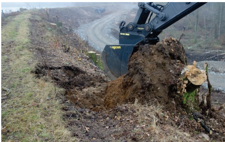
Figur 37 Uppgrävning av bokstubbe i nedströmsslänten med stamdiameter 45 cm
