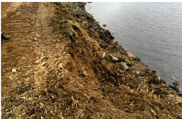
Figur 15 Hål efter bortfräst stubbe i uppströmsslänten
