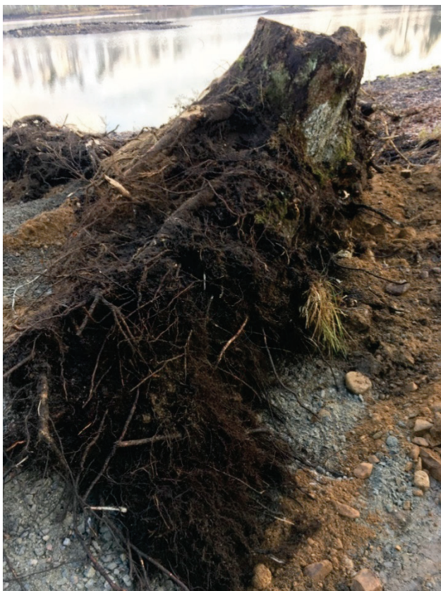
Figur 40 Bokstubbe med rötter. Bokstubben hade stamdiameter 60 cm och växte i uppströmskanten av dammkrönet.
