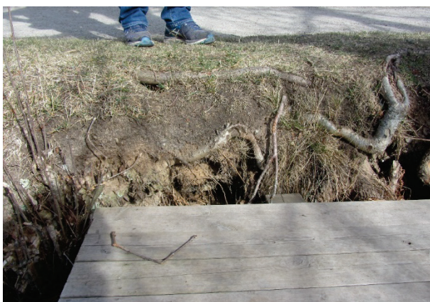
Figur 12 Erosionsskador i uppströmsslänten i anslutning till trädrötter (damm i Mellansverige)
