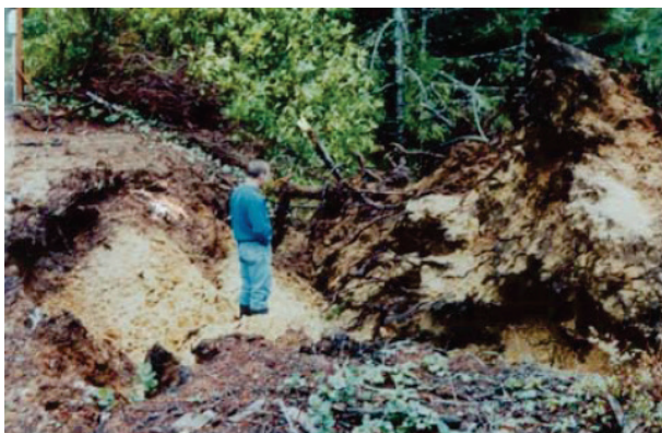
Figur 7 Skador på en dam i USA orsakat av ett omkullvält träd (från FEMA, 2005)
