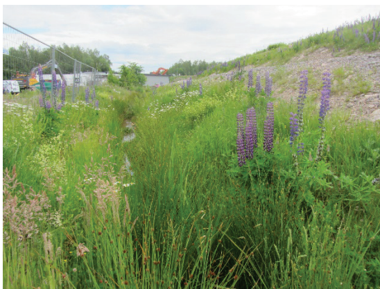
Figur 34 Exempel på igenväxt dränagedike längs en damm. Diket anlades ca ett år innan fotot är taget.
