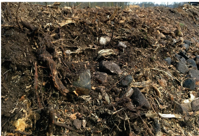
Figur 14 Uppströmsslänten innan den rensats från bortfrästa rötter
