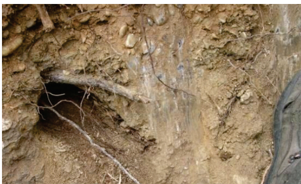
Figur 9 Hål i en damm orsakat av en rot som brutits ner (från Zanetti m.fl., 2012)
