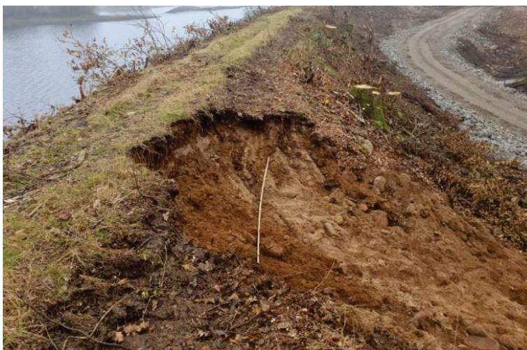
Figur 46 Hålet efter den bortgrävda stubben i Figur 45 blev stort. Stor del av nedströmsslänt och dammkrön grävdes bort.
