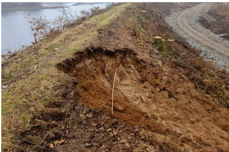
Figur 4 Hålet efter den bortgrävda stubben i Figur 64 blev stort. Stor del av nedströmsslänt och dammkrön grävdes bort.
