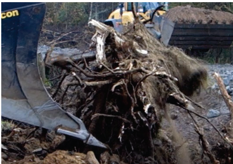
Figur 47 Björkstubbe med stamdiamter 55 cm i nedströmsslänten nära dammkrön. Stora rötter med diameter >10 cm
