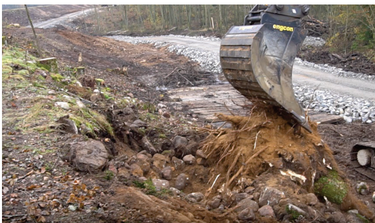
Figur 36 Stubbe från en ek med stamdiameter 35x45 cm. Eken växte i nedströmsslänten nära dammkrön.
