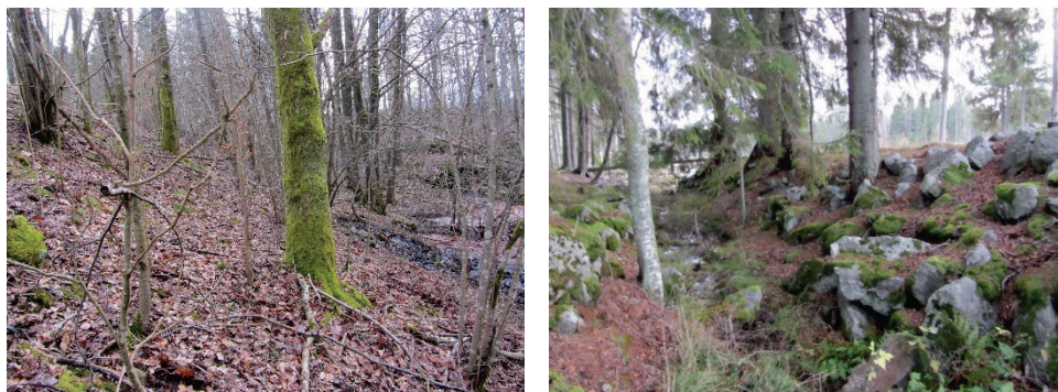
Figur 35 Exempel på svenska dammar där det växer träd på eller i direkt anslutning till dammen
