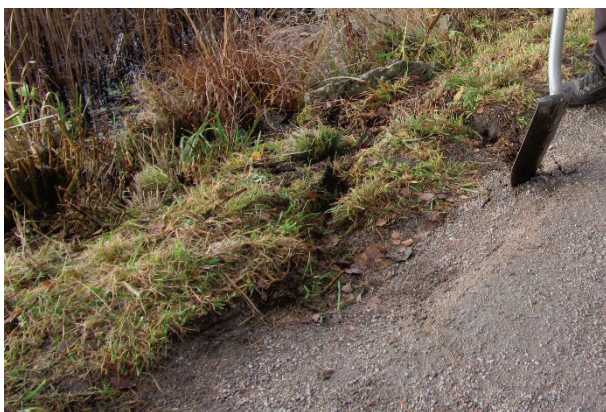
Figur 14 Sättning i uppströmsskanten av dammkrönet på en damm i Mellansverige
