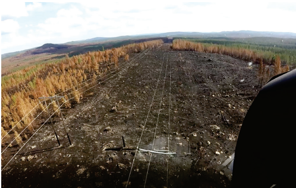
Figur 22 Cirka 80 av Ellevios stolpplatser skadades i branden mellan Laforsen och Kårböle. Foto: Ellevio, ur Jenvald & Morin (2019).
