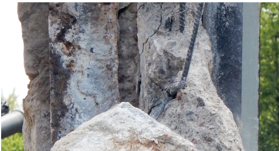
Figur 3.29. Pelare 3. Närbild på flänsarna till de två U-balkarna i pelarens skalmur, inklusive armering av typen kamjärn i kringgjutningsbetongen. Notera korrosionsangreppen på den inre (vänstra) U-balken (2020-06-30).
