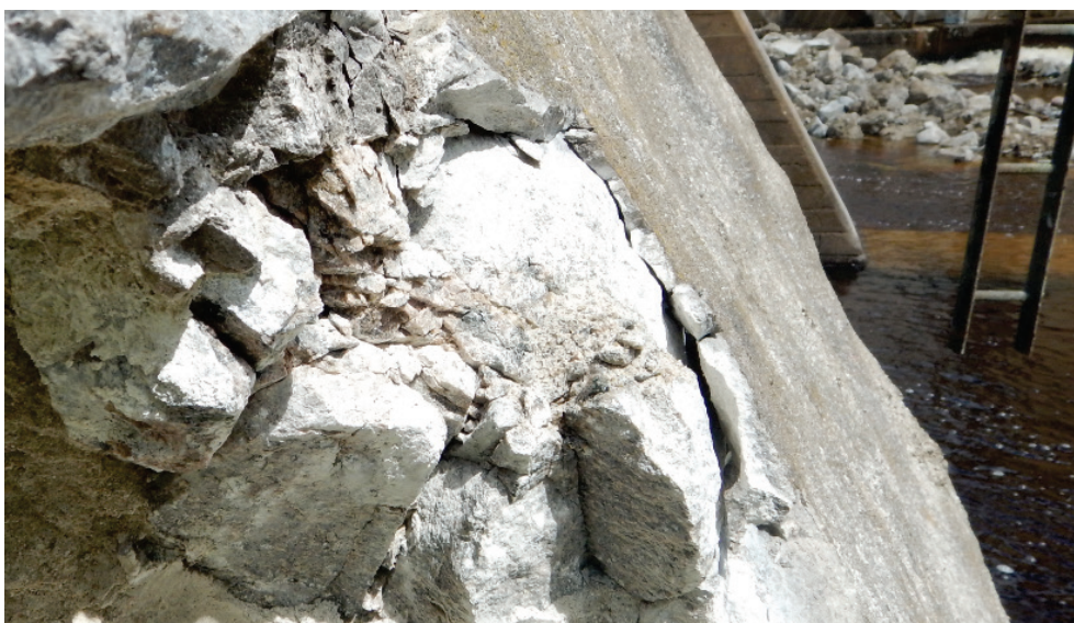
Figur 3.37. Pelare 5. Närbild på området för kontrollen av pelarens uppbyggnad. Det framgår att det ytliga skiktet av puts eller sprutbetong som täcker skalmuren når en tjocklek uppåt 10–15 mm (2020-06-30).
