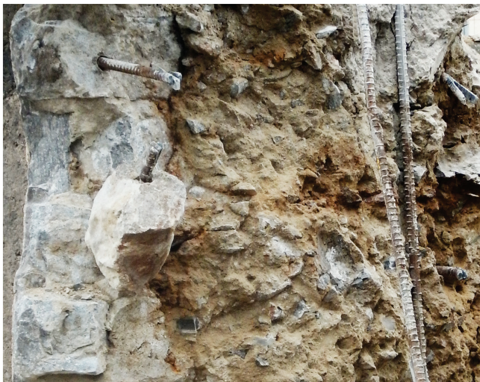
Figur 3.19. Pelare 2. Närbild som visar pelarens innanmäte innanför skalmuren av huggen sten. Som synes har materialet viss sammanhållning. Notera även armeringen av kamjärn som har tillkommit i efterhand. Uppe till höger i bild syns den inre delen av ett tvärsat förankringsjärn som falsen till utskovsluckan har förankrats med. Förankringsjärnet ser ut att vara av typen slätstål och härstamma från byggskedet (2020-06-30).
