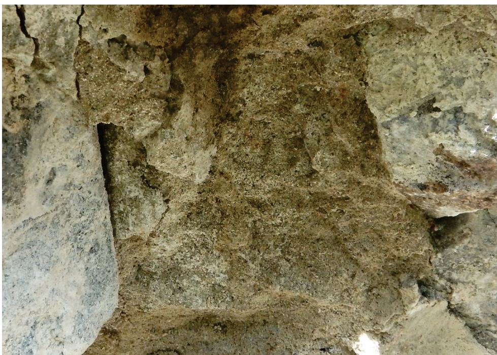
Figur 3.38. Pelare 5. Närbild på materialet precis innanför skalmuren. En av stenarna syns till vänster i bild. Utseendet på materialet påminner om ett cementbruk mer än en konventionell betong. Samtidigt ser ytan sandig ut med ställvisa bruna partier. På stenarna syns vita utfällningar (2020-06-30).
