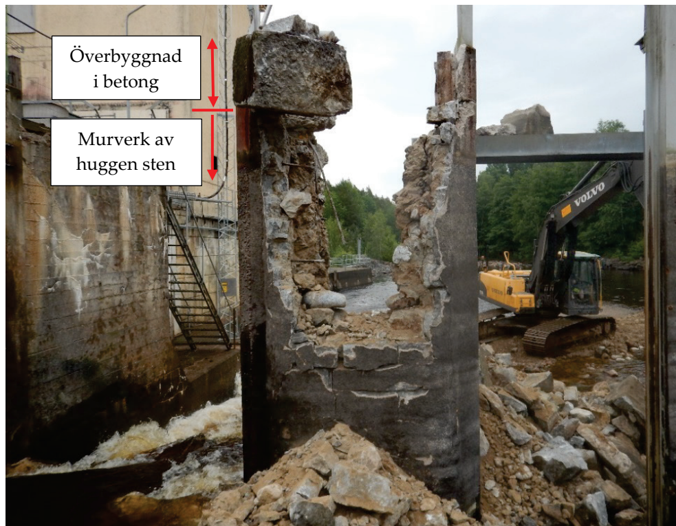
Figur 3.15. Pelare 2. Bild av uppströmssidan där en del av överbyggnaden ligger kvar på pelaren (2020-06-30).
