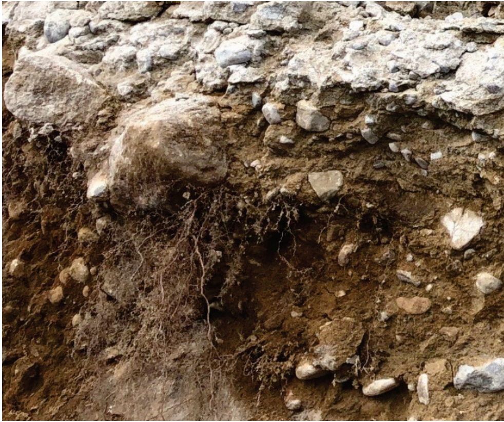
Figur 3.46. Höger dammanslutning. Närbild av rötter i det gulbrunaktiga jordmaterialet direkt under den magra betongen. Närbilden visar rötter mitt i snittet i dammanslutningen. Foto F Lundblad (2020-07-02).
