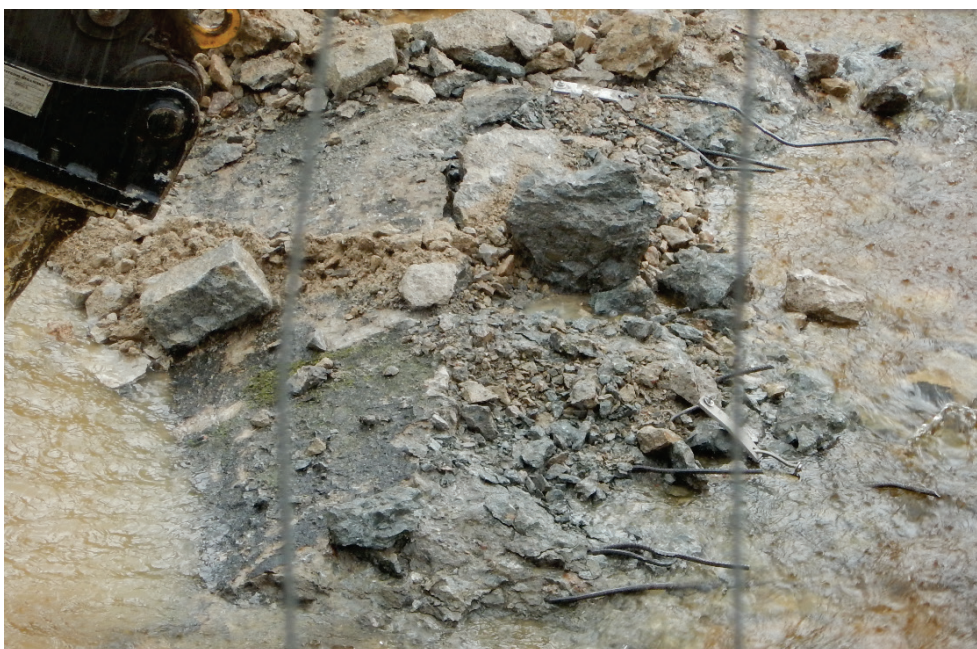
Figur 3.49. Utrivning av en utskovströskel belagd med sprutbetong. Uppstickande kamjärn syns (2020-06-30).
