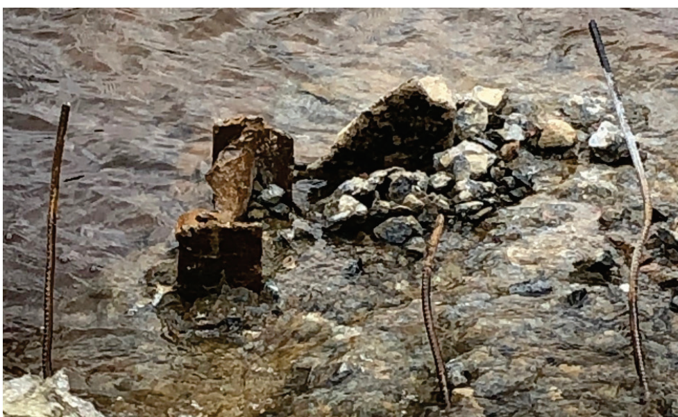
Figur 3.50. Uppstickande kamjärn och avskuren stålprofil från en utskovströskel. Foto F Lundblad (2020-07-02).
