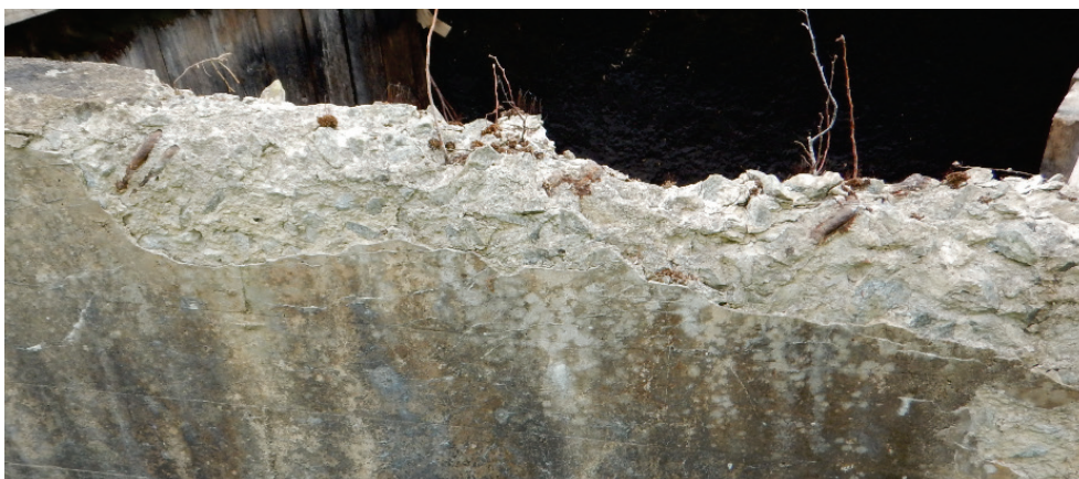
Figur 3.53. Fisktrappan. Ställvis påträffades frostsadad betong och frilagd armering (2020-06-17).
