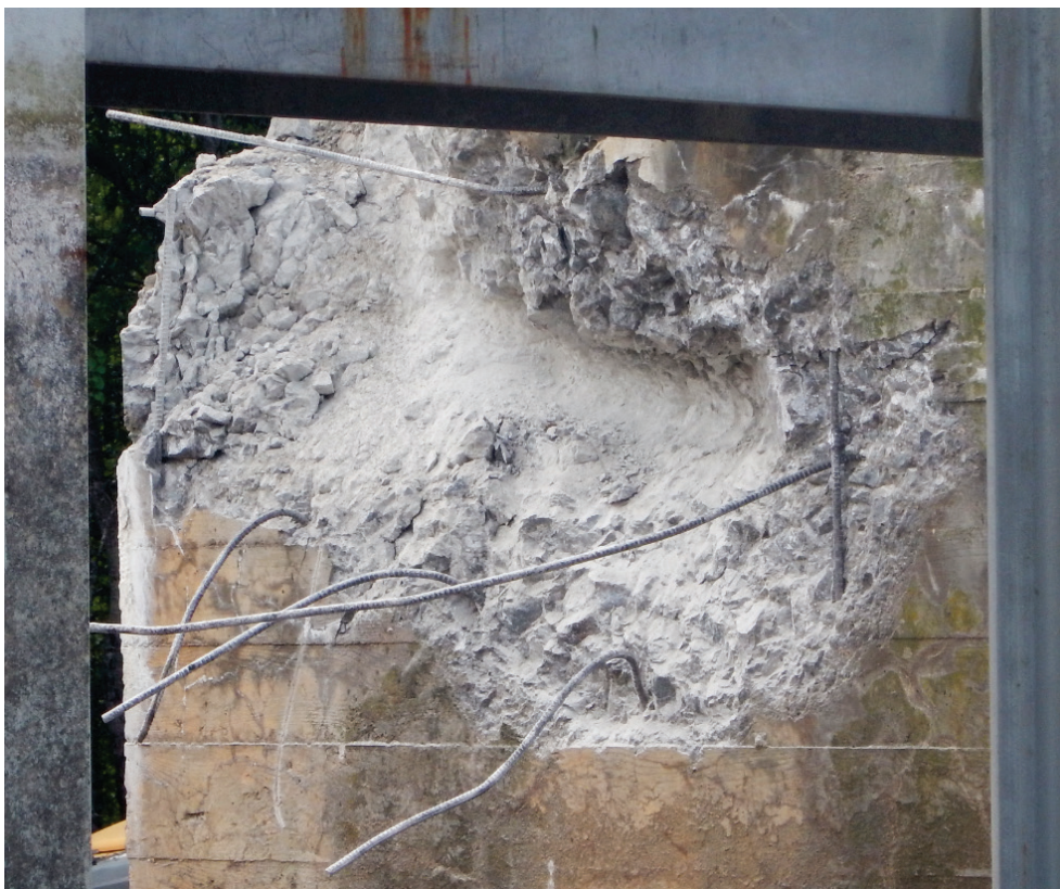
Figur 3.31. Pelare 4. Närbild på pelarens topp där en snabb kontroll med hydraulhammaren visade att pelaren både var uppförd av konventionell gjutbetong och armerad med armering av typen kamjärn (2020-06-30).
