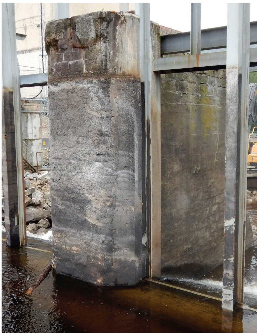
Figur 3.21. Pelare 3. I fotografiet syns pelarens uppströmssida. Nivån för hur långt upp på pelaren vattenytan normalt har nått syns som en brun rand på samma höjd som de liggande stålprofilerna (2020-06-30).
