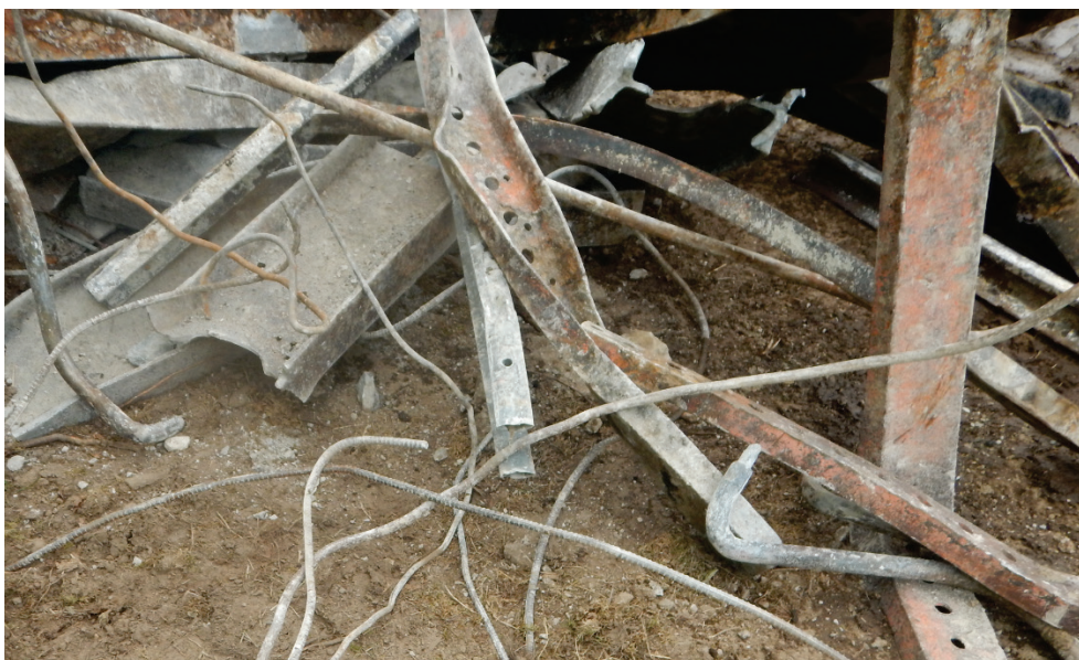
Figur 3.55. Utrivna stålprofiler var för det mesta i gott skick och hade ofta endast ställvis ytrost (2020-07-03).
