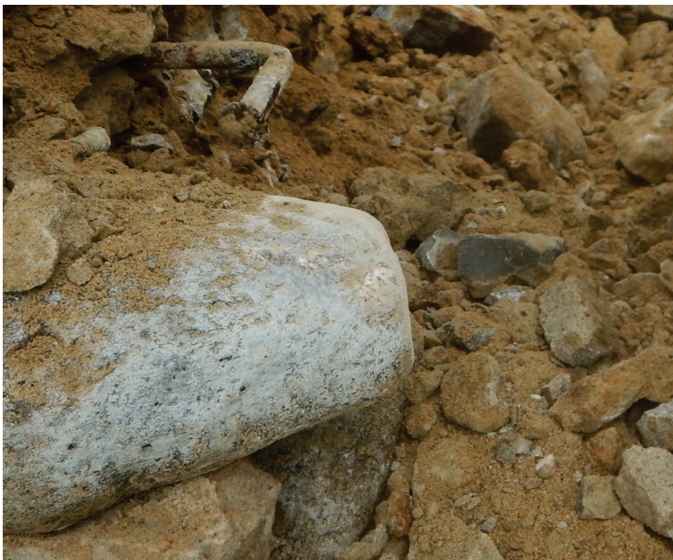
Figur 3.18. Pelare 2. Närbild på pelarens innanmäte som mer påminner om grus än betong. Vad som också kan noteras i bildens övre vänstra hörn kan vara en kramla för att förankra murverket i pelaren (2020-06-30).
