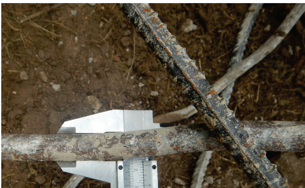
Figur 3.56. Armering av typen slätstål respektive kamjärn. Avsynad armering uppvisade ställvis ytrost, vilken till stor del antogs ha uppkommit i samband med eller direkt efter utfört rivningsarbete (2020-07-03).
