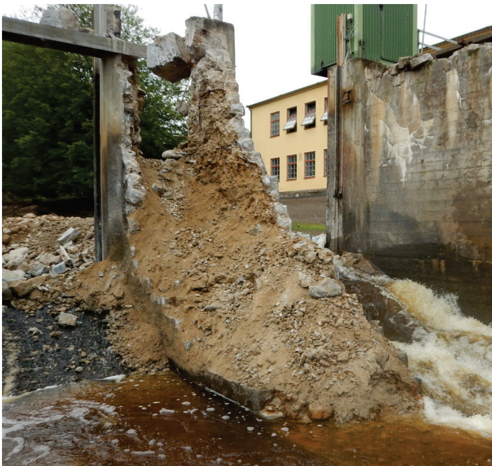
Figur 3.14. Pelare 2. Pelaren har delvis rivits ut och dess uppbyggnad framgår av fotografiet (2020-06-30).
