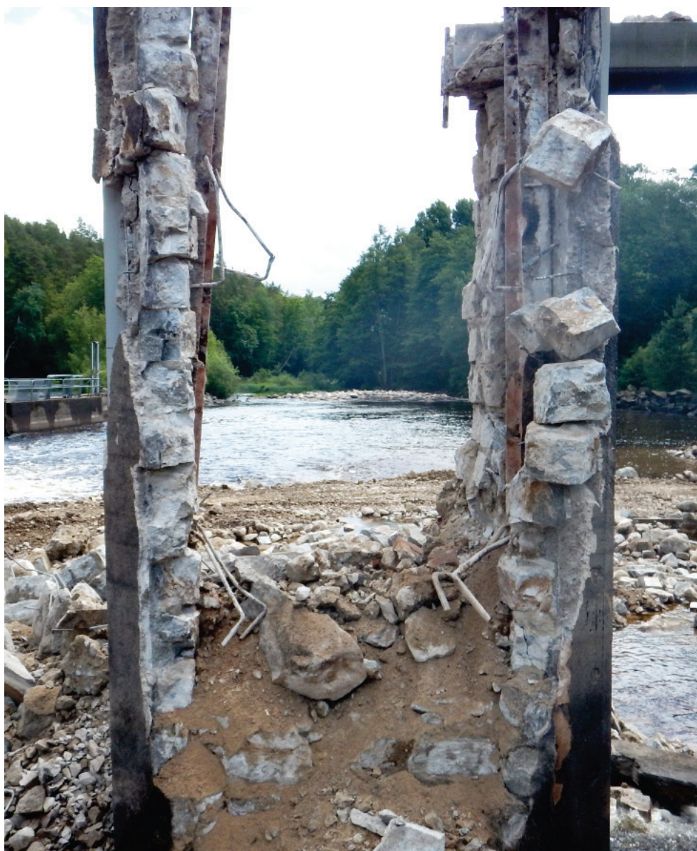
Figur 3.27. Pelare 3. Uppströmssidan av pelaren. Endast pelarens nedre del och skalmuren kring de ingjutna stålprofilerna som utgör luckornas falsar kvarstår. Notera det sandliknande materialet nedtill (2020-06-30).
