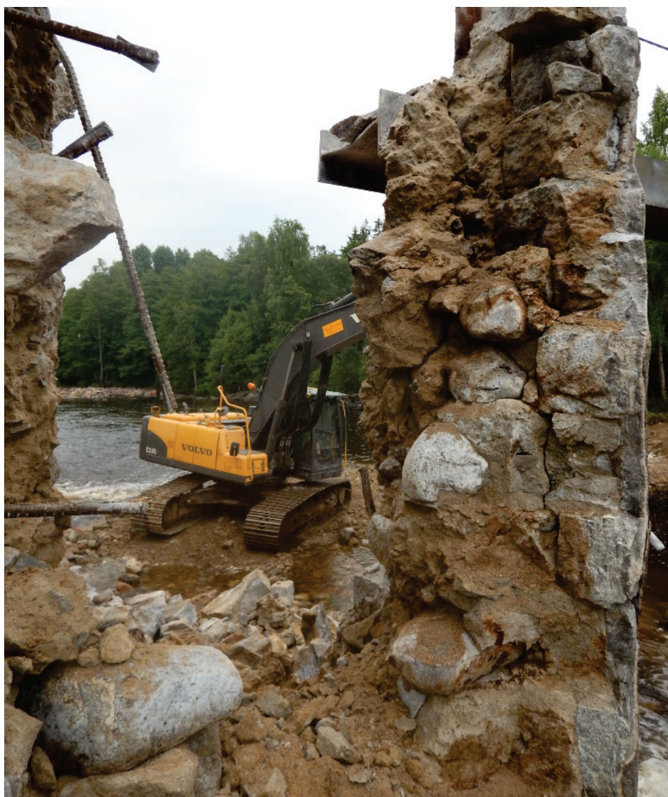
Figur 3.17. Pelare 2. Närbild på pelarens inre av sparsten och ett jordliknande material (2020-06-30).
