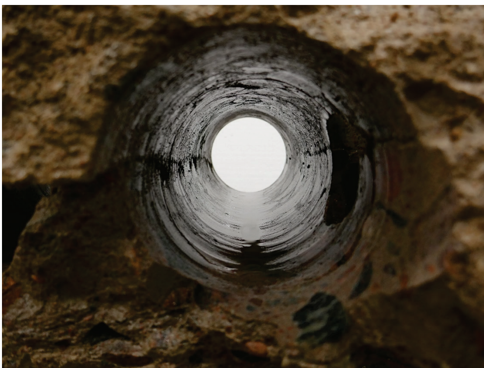
Figur 5. Borrhål i betongblock efter uttagning av horisontell kärna. Den horisontella gjutfogen mellan två gjutpallar synlig som längsgående sprickor orienterade klockan 9 och 15.
