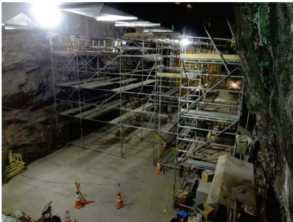
Figur 15. Ställningsinstallation Från Hydro Québec för underhåll av stort berggrum 18 .
