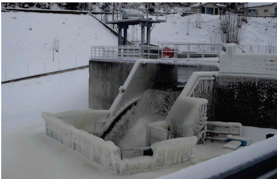
Figur 5.7 Avbördning under vintertiden genom pianotangentutskov vid Escouloubre-dammen, Frankrike (källa EDF, Epcum, et al. 2013).
