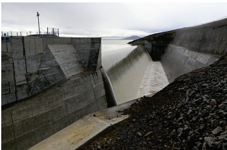
Figur 1.3 Sidoutskov vid Kárahnjúkar-dammen, Island (Källa: www.langdale-associates.com).
