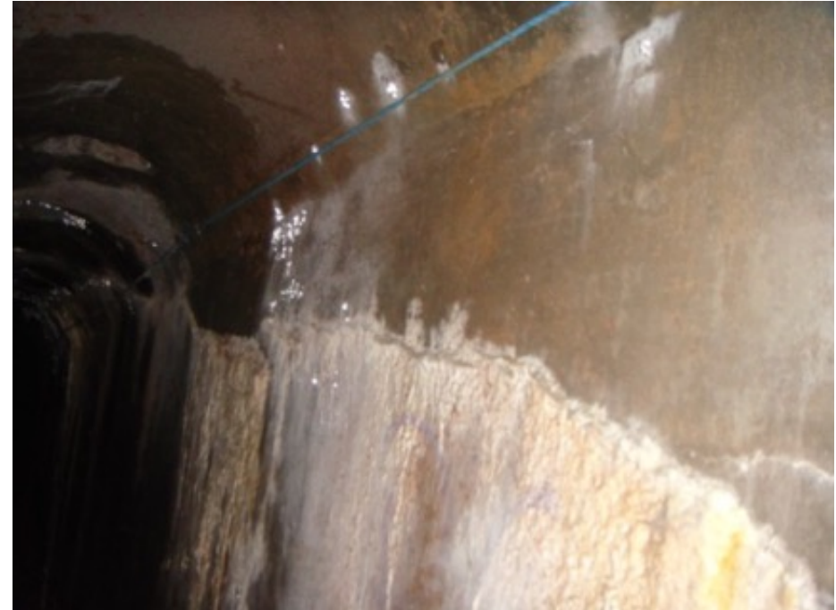
Urlakning genom en spricka, som troligen uppkommit p.g.a. förhindrade termiska rörelser
