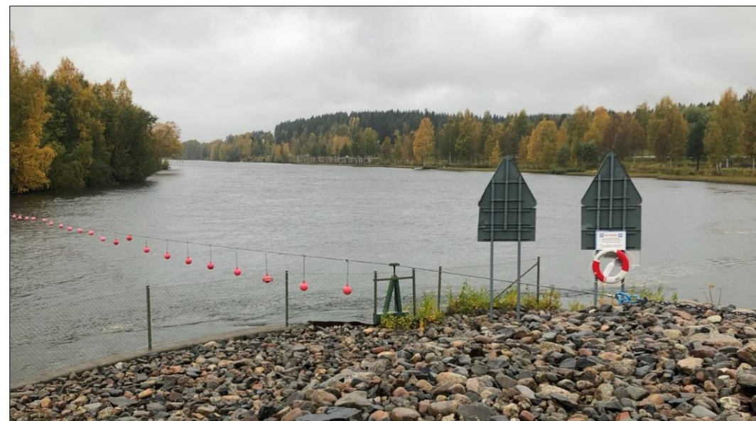
Säkerhetsvajer vid Bergsbyns regleringsdamm i Skellefteälven. Foto: Lisa Carlsson, Sweco.
