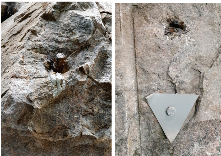
Figur A-6. Exempel på Perfobult samt kompletterande bult med felvänd trekantsbricka som ersatt tidigare bult, maskinsal.
