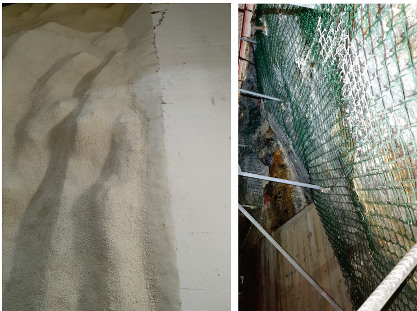
Figur A-16. T.v. Exempel på insprutat område, vägg i maskinsal. T.h. Exempel på nätat område samt betongkontrefor, bakom innervägg i maskinsal, galleri.
