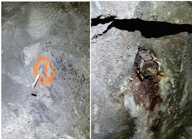
Figur A-8. T.v. Exempel på kompletterande bult i tillfartstunnel. T.h. Exempel på äldre, korroderad bult i tillfartstunnel.
