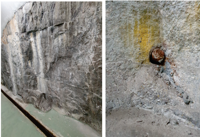
Figur A-5. Exempel på gynnsam bergkvalitet samt bult med bristfällig ingjutning, maskinsal, turbinplan.
