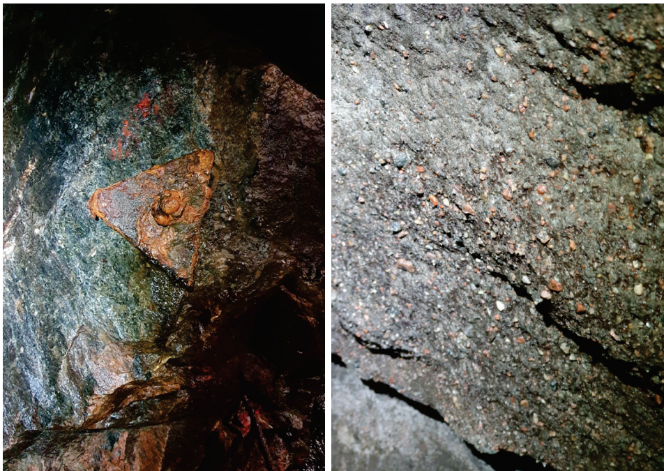
Figur A-4. Exempel bult med bricka respektive urlakad sprutbetong, inspektionstunnel anläggning 1.
