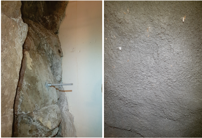
Figur A-11. T.v. Exempel kompletterande förstärkning (gängstång?). T.h. Ny sprutbetong, ej fiberarmerad pga svårtillgängligt utrymme.
