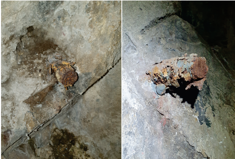
Figur A-13. T.v. Exempel på ingjutna bultar med korroderad bultände. Vägg i utrymme i anslutning till maskinsal.
