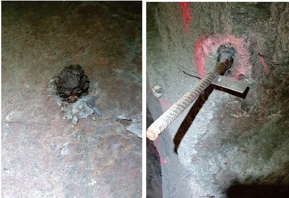
Figur A-3. Exempel korroderad bult respektive kompletterande bult med tag, infartstunnel anläggning 1.
