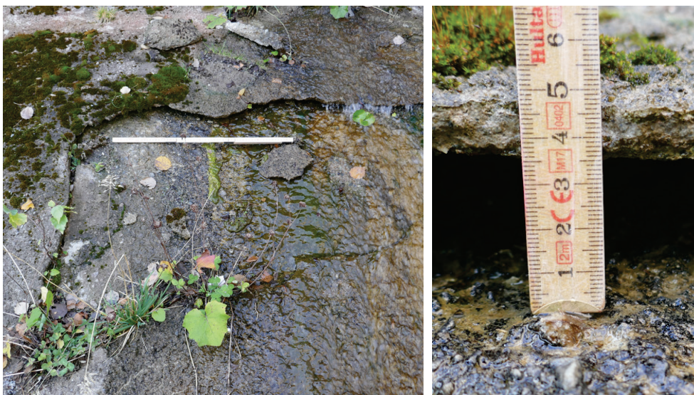
Figur 16. Hissmofors. Utskov 1. Ställvis hade sprutbetongskiktet släpp och den intilliggande sprutbetongen rest sig så upp till 20–30 mm så att det var möjligt att sticka in en tumstock under skiktet.
