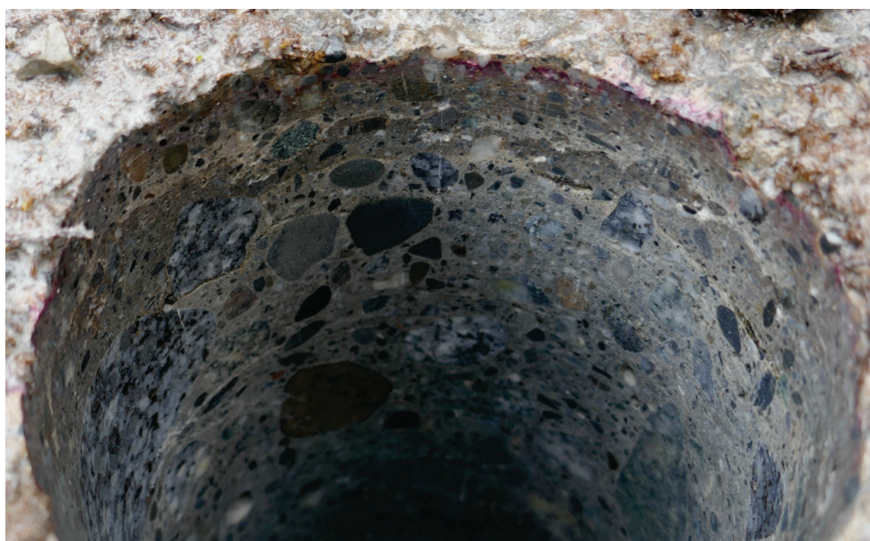
Figur 21. Hissmofors. Utskov 1. Närbild på väggen i ett av borrhålen. En ljusbrun rand kan ses i kontaktzonen mellan sprutbetong och konstruktionsbetong. Ställvis har materialet längs randen nöts bort vid borrhållningen.
