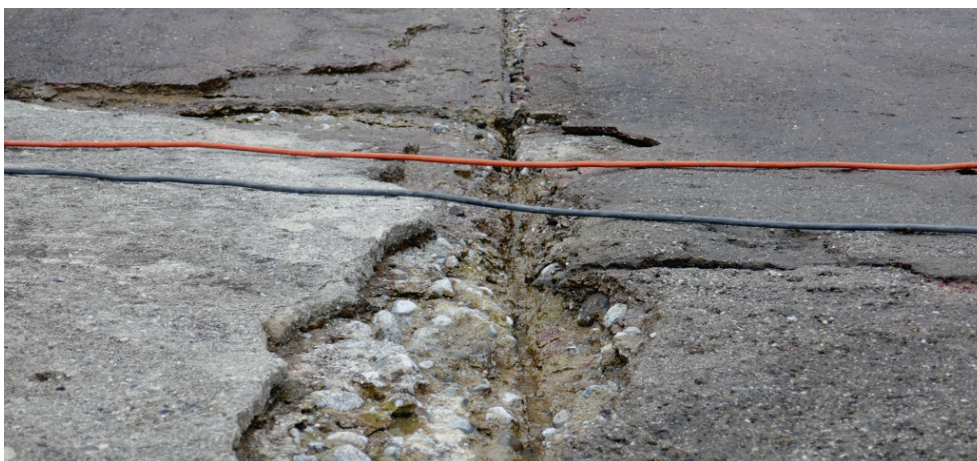
Figur 22. Hissmofors. Utskov 5. Skador i form av spjälkad sprutbetong vid gjutfogar i konstruktionsbetongen.
