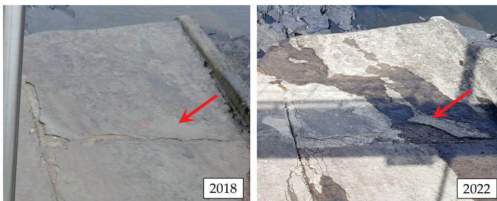
Figur 23. Hissmofors. Utskov 5. Ett större sjok sprutbetong har spjälkat loss (röd pil) mellan 2018 och 2022.
