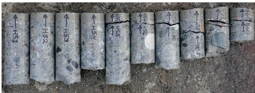
Figur 26. Hissmofors. Utskov 5. Upptagna betongkärnor från borrhålen. Pilen markerar överytan hos skibordsförlängningen. Tjockleken på sprutbetongskiktet varierar mellan 25 och 40 mm.
