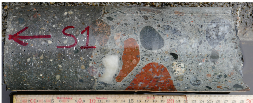
Figur 32. Kraftverk 2. Utskov C. Sprutbetongens tjocklek är cirka 100 mm. Pilen markerar skibordets överyta.
