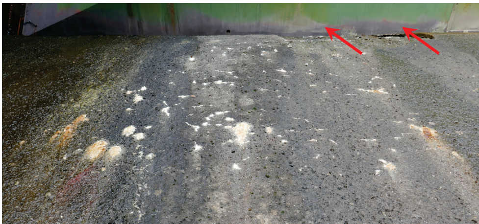
Figur 42. Kattstrupeforsen. Utskov 2. Mindre krackelering och kalkutfällningar i sprutbetongskiktet. De röda pilarna markerar läget för en större skada (1 x 1 m) där sprutbetongen har släppts och armeringsjärn frilagts.
