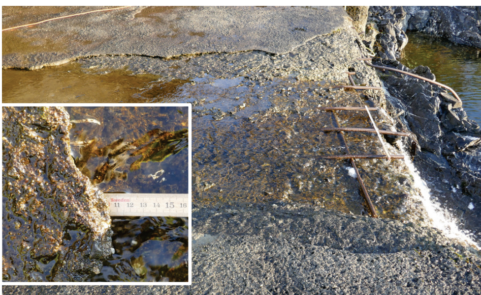
Figur 43. Kattstrupeforsen. Utskov 3. Nedbrytning av sprut- och konstruktionsbetong har frilagt armeringsjärn.
