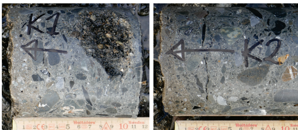
Figur 44. Kattstrupeforsen. Utskov 2. Två betongkärnor. Kärna K1 har ett gjutsår på sidan (t.v.) och i kärna K2 kan det noteras en spricka eller skiktning parallellt med överytan cirka 10–20 mm under sprutbetongen (t.h.).
