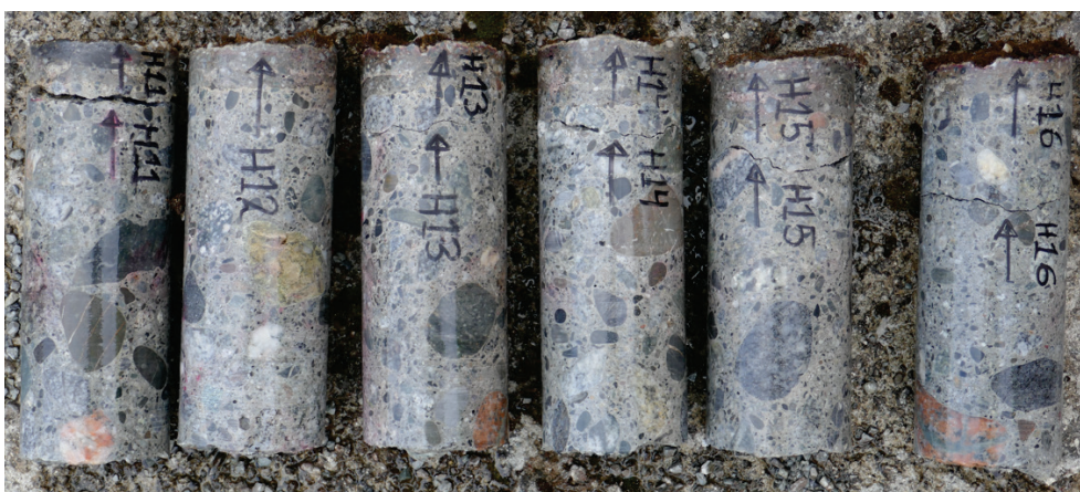
Figur 18. Hissmofors. Utskov 1. Upptagna betongkärnor från borrhålen som borrades till fult djup av 300 mm. Pilen markerar skibordets överyta. Tjockleken på sprutbetongskiktet varierar mellan 10 och 40 mm.
