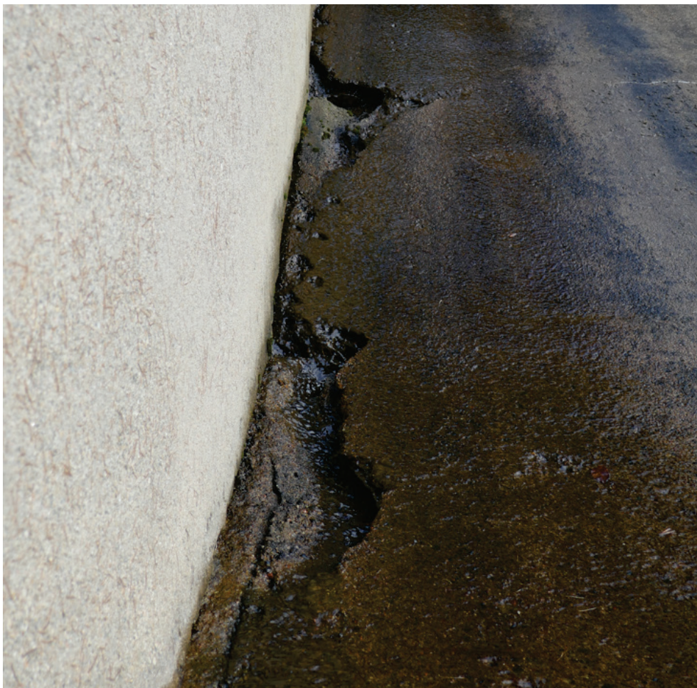
Figur 31. Kraftverk 2. Utskov D. Intill höger pelare rann det vatten från en läckande utskovstätning. Skador noterades längs anslutningen mot pelarsidan. Skadornas utbredning i längdled uppskattades till 1,5 m.
