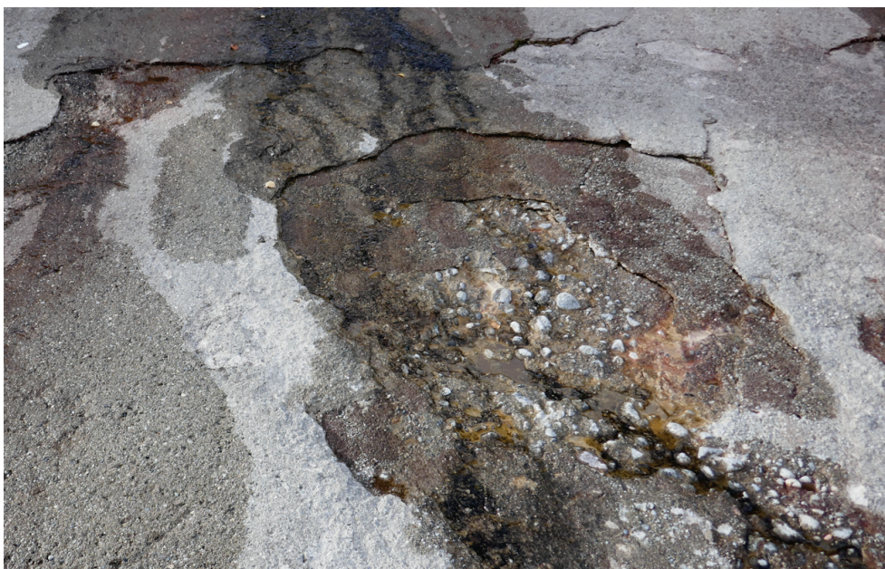
Figur 24. Hissmofors. Utskov 5. Exempel på skador på skibordsförlängningen där antingen tunna skikt av sprutbetong har släppt från underliggande sprutbetong eller där hela sprutbetongskiktet har spjälkats loss.
