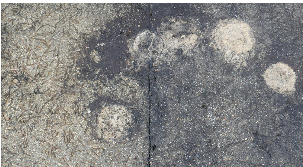
Figur 29. Kraftverk 2. Utskov C. Korroderade stålfiber finns i ytan. En av skibordets gjut- eller rörelsefogar syns mitt i bilden tillsammans med lagningarna efter 1996 års uppföljning.
