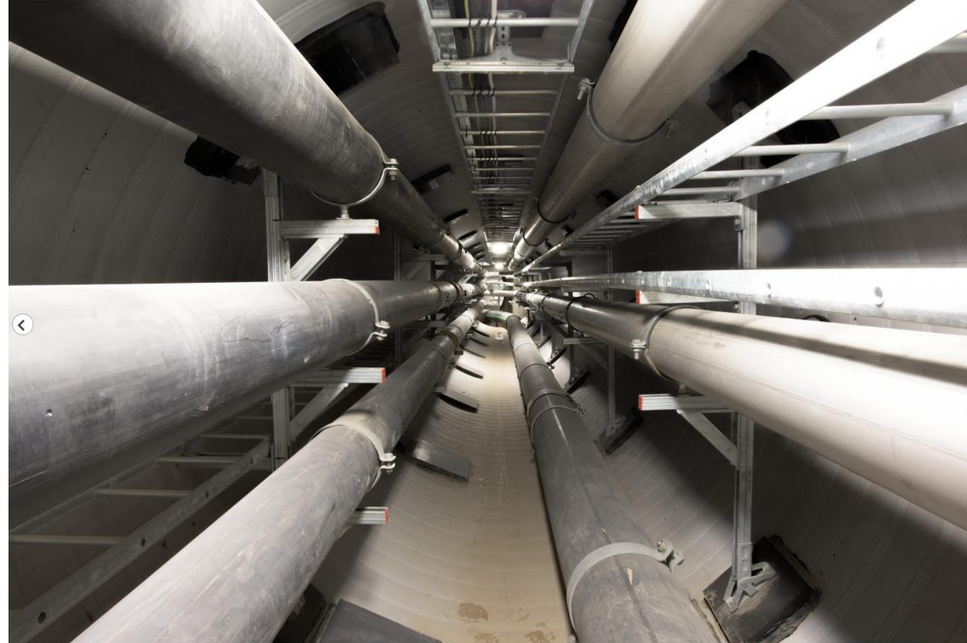
Kulvert för ledningsbunden infrastruktur i Vallastaden
