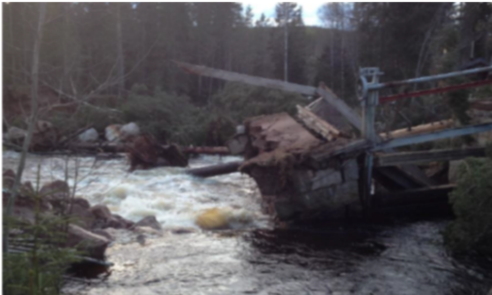
Figur 3.71 Foto av dammhaveri. Uppströmsvy.
