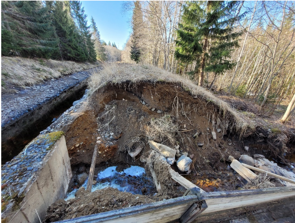
Figur 3.18 Homogen fyllningsdamm vid kanal. Dammen bedöms vara uppbyggd av kanalschaktsmaterial. Foto: Mats Lund.
