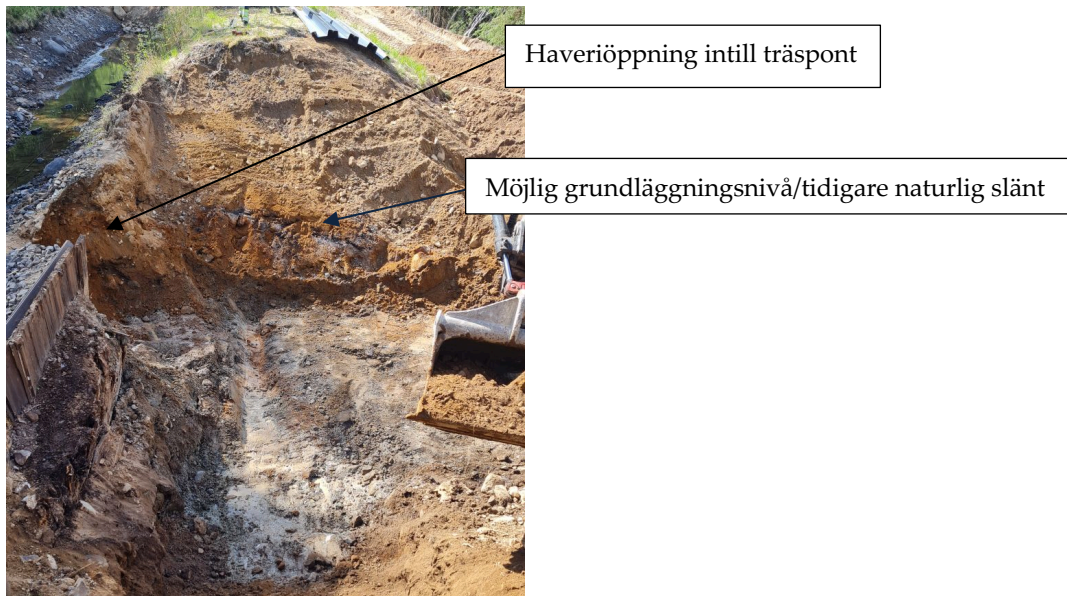
Figur 3.19 Homogen kanaldamm vid läge för dammhaveri. Foto: Mats Lund.
