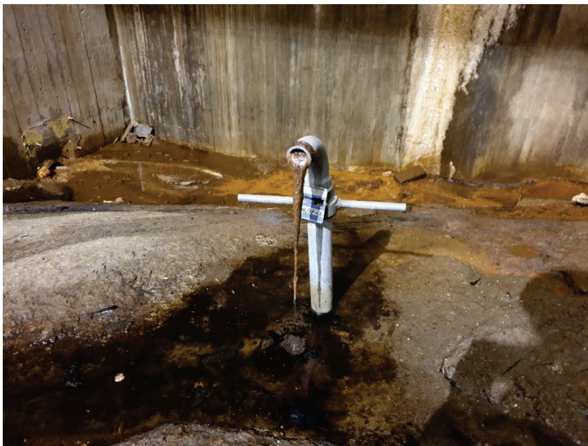
Figur 5—2 Svanhals med artesiskt tryck som satts igen av järnoxidutfällningar som bildats i kontakt med syre. Notera att svanhalsen i bilden är placerad onödigt högt ovan berg vilket innebär att artesiskt tryck först upptäcks när trycket är en bra bit ovanför bergövertytan.
