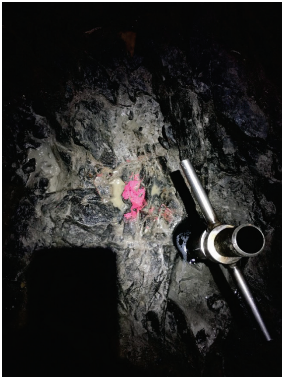
Figur 5—1 Dränagehål med åtdragen packer i berg och utan svanhals installerad.
