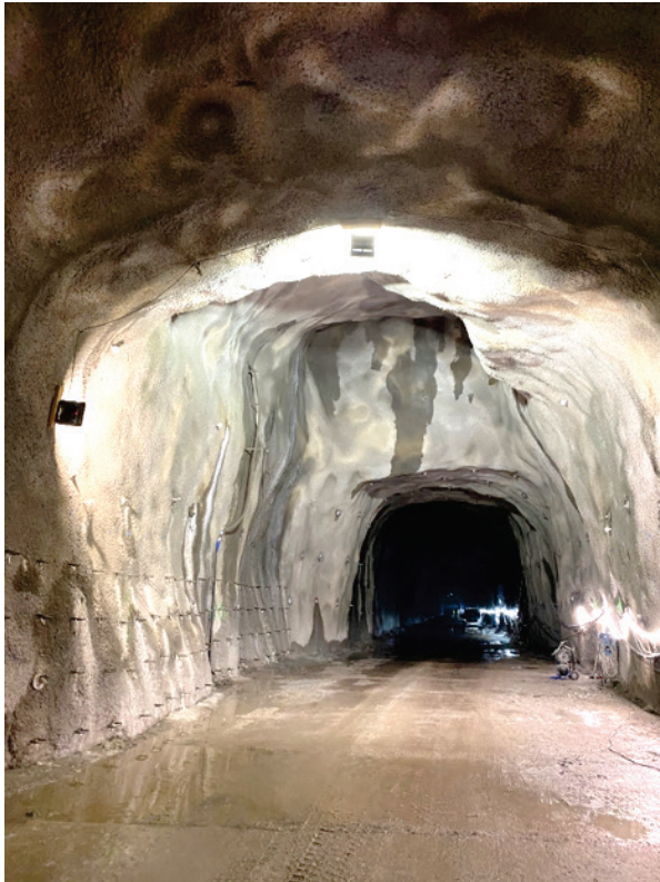
Figur 3-26 Rasområdet sett från uppströmssidan efter utlastning av rasmassor (foto SWECO)
