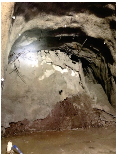
Figur 3-23 Kvarvarande rasmassor stabiliserade med sprutbetong efter utlastning (foto SWECO)
