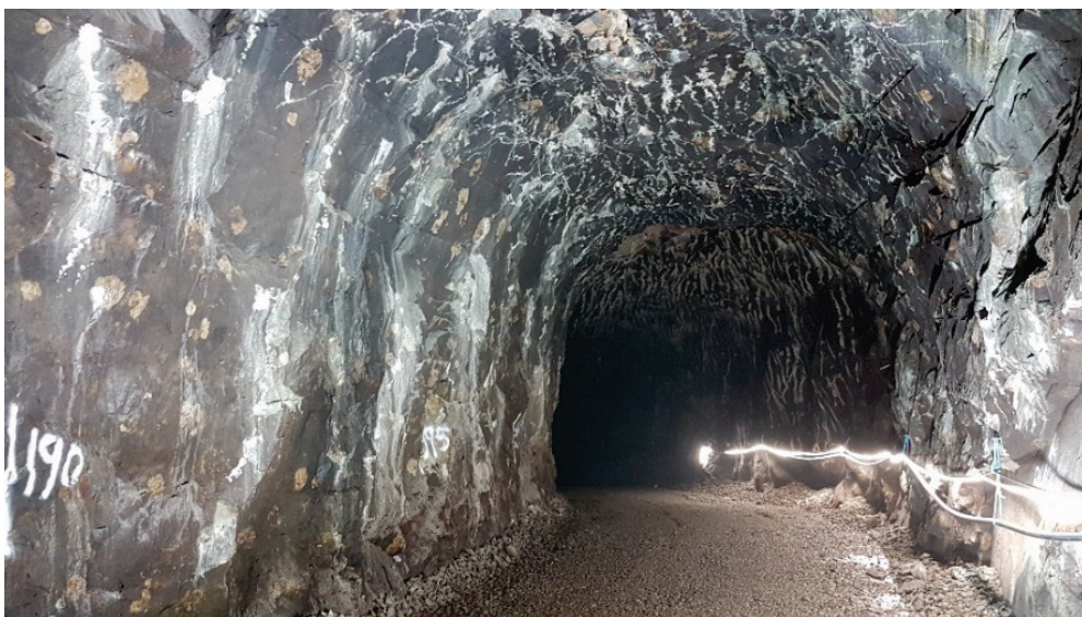
Figur 3-13 Golvet i svalltunneln var väldigt ojämnt. För att man skulle kunna köra med arbetsmaskiner anlades en arbetsväg genom att fylla ut med makadam (foto SWECO).
