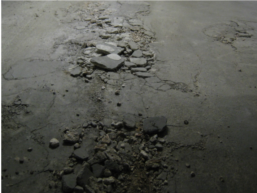
Figur 1 Betongskada i golv till följd av armeringskorrosion. Foto: Tor Powell
