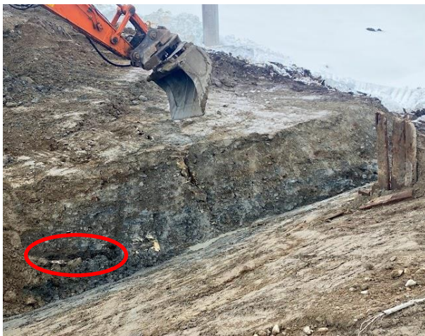
Figur 22 Linje av organiskt material ovan schaktlinje nedströms spont
