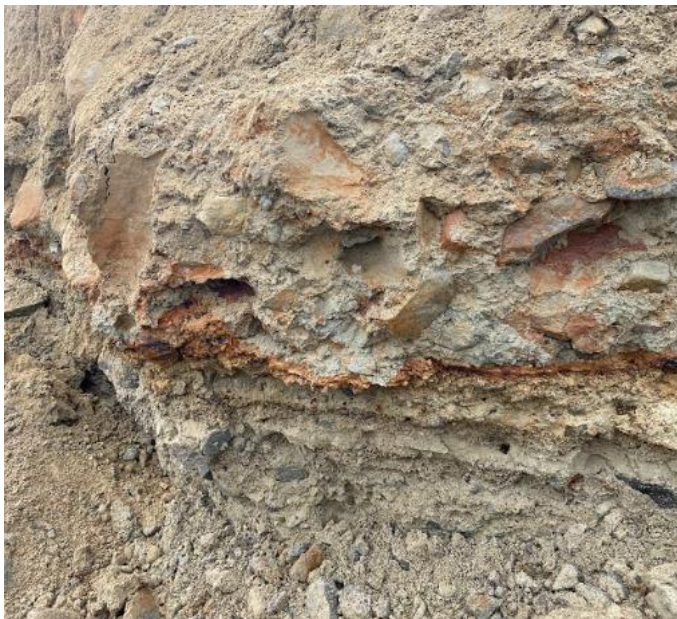
Figur 24 Tydlig utfällning i tätkärnan som sträckte sig längsmed dammen vid sektion 0/185, linjen ligger på nivå +562,9
