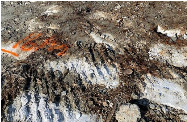
Figur 10 Betong från förstärkningsåtgärder som genomförts i kulverten, bilden visar kulvertens ovansida 16 meter nedströms spont
