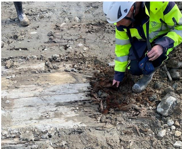
Figur 11 Tydlig gräns mellan friskt och murket tak i kulverten, ca 12 meter nedströms spont
