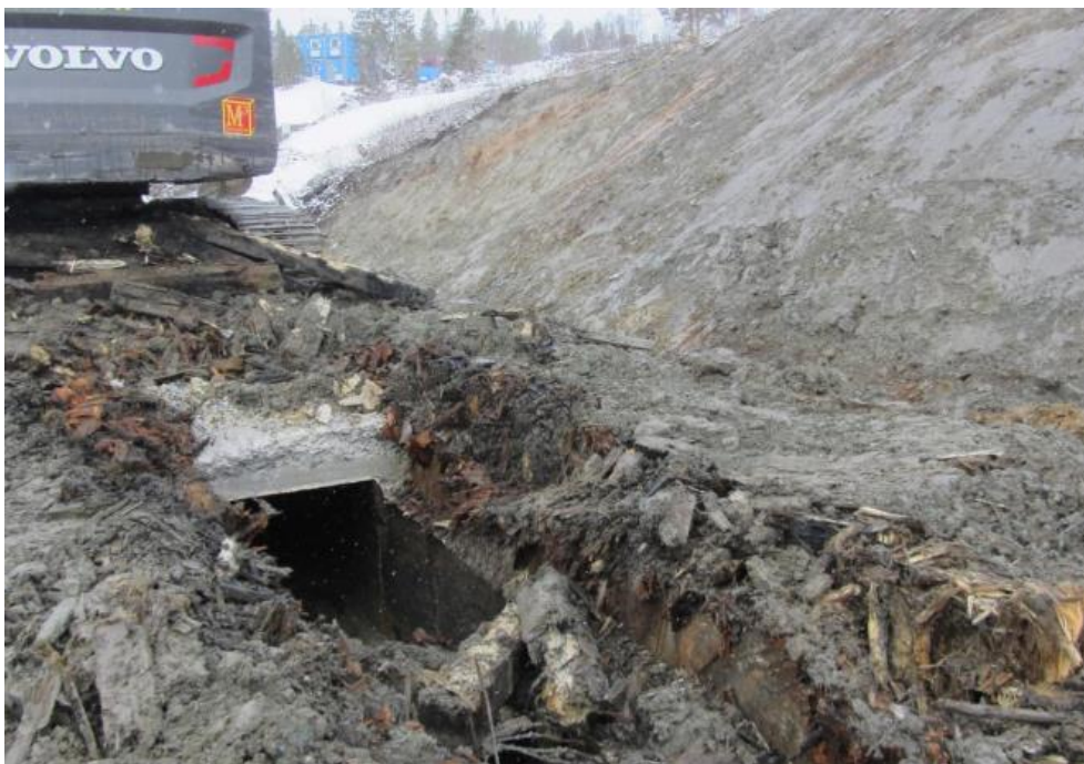
Figur 3.6 Bottenutskovet i nedströms riktning i området där träkulverten var i dåligt skick. Ovanpå betongelementet syns injekterad betong.
