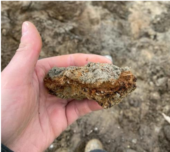
Figur 23 Tydlig utfällning i tätkärnan som sträckte sig längsmed dammen vid sektion 0/185, linjen ligger på nivå +562,9
