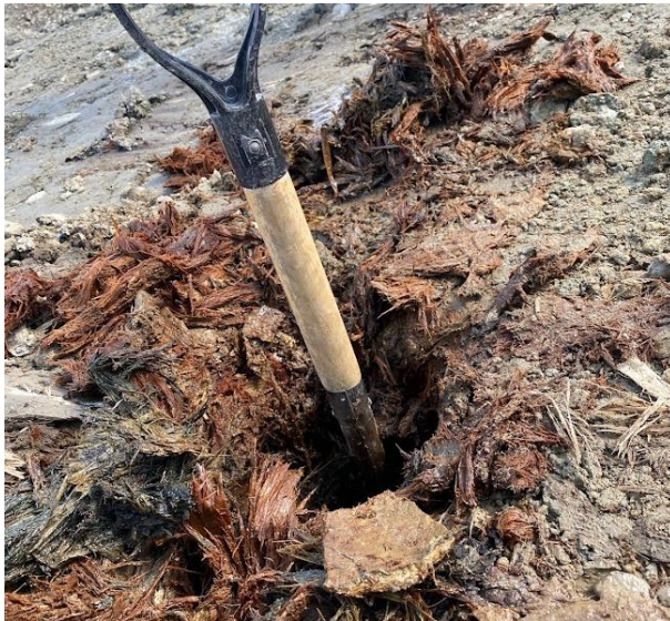
Figur 12 Kulverttak ca 14 meter nedströms spont, taket går att pressa sönder med handkraft
