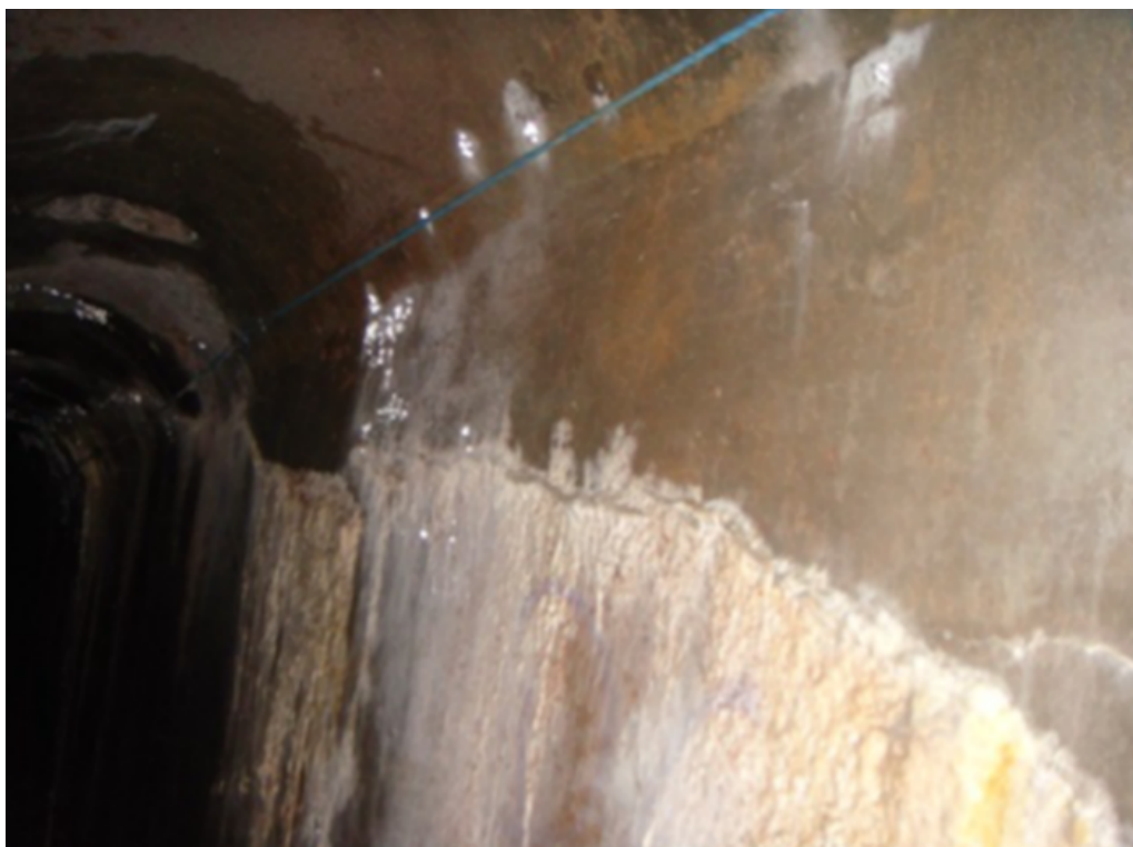
Figur 2-12 – Läckage från en spricka.
