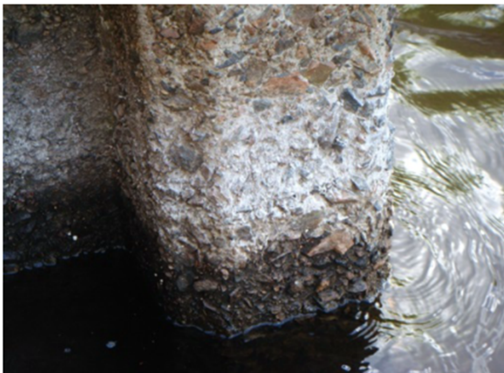
Figur 2-10 – Skadad betong vid vattenlinje.
