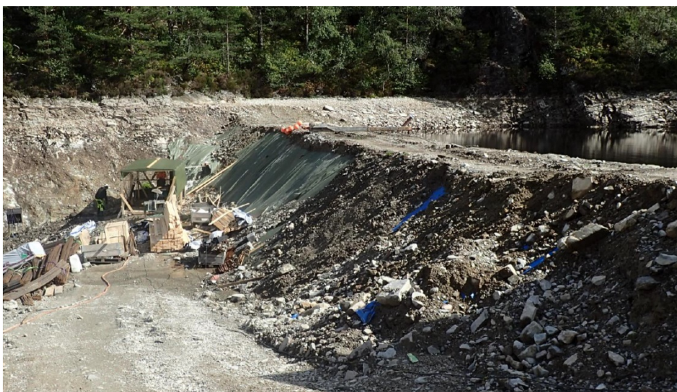
Figur 47 Nederbörd har lett till att vattenytan stigit till nära dammkrön (från presentationen Planning and design of cofferdams in light of Munkebotvatn dam failure , Sigtryggsdóttir, NTNU)
