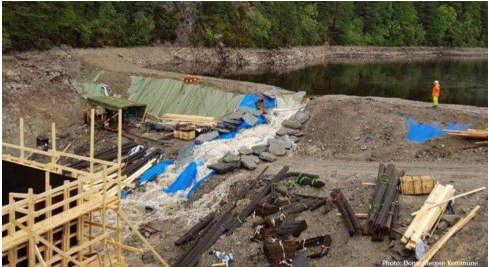
Figur 48 Fångdammen har försetts med ett nödutskov (från presentationen Planning and design of cofferdams in light of Munkebottsvatn dam failure , Sigtryggsdóttir, NTNU)
