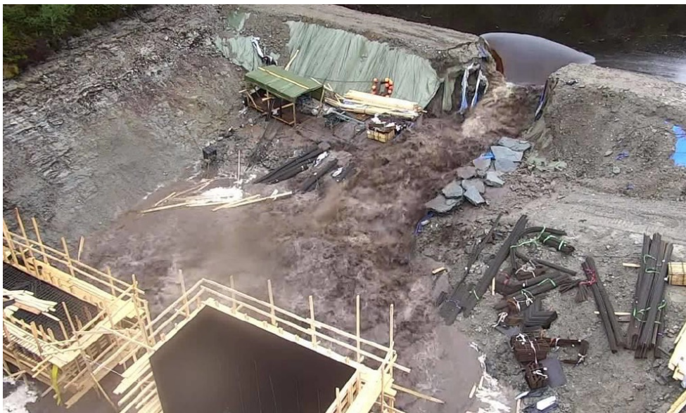
Figur 49 Vattnet har börjat erodera massorna i fångdammen (från presentationen Planning and design of cofferdams in light of Munkebottsvatn dam failure , Sigtryggsdóttir, NTNU)
