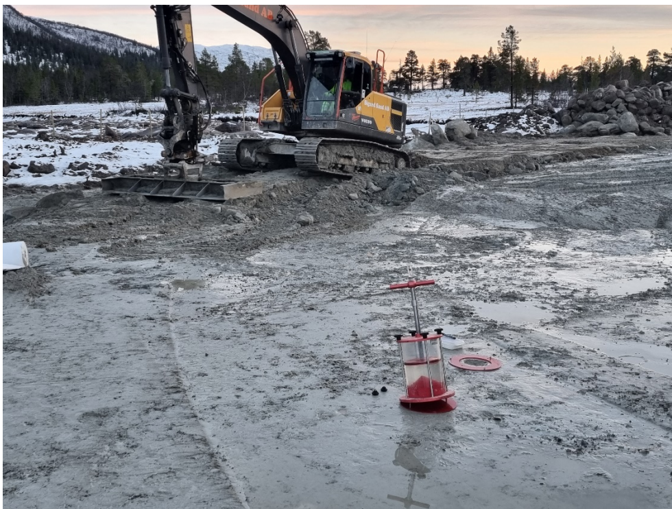
Figur 23 Svårighet att ta packningsprover pga. blöta massor
