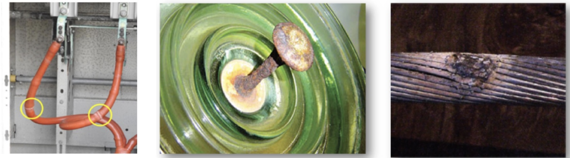
Figur 24. Skador orsakade av korona på polymera isolationsmaterial (vita banden på isoleringen, vänster) och metaller (korrosion; bilderna till höger)
