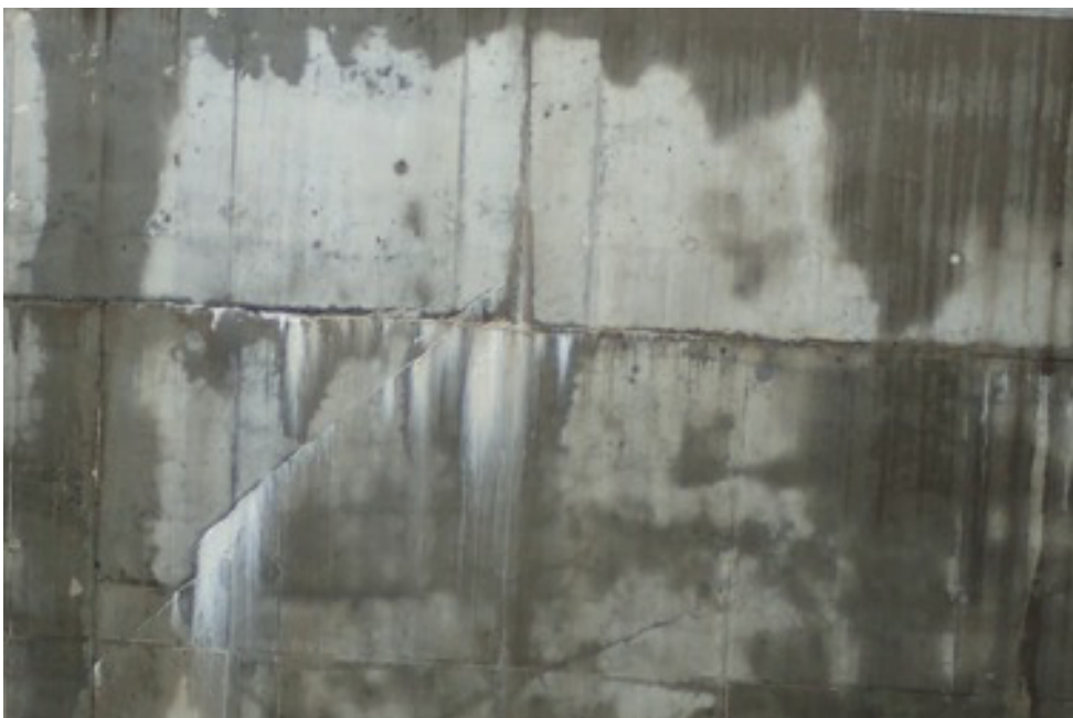
Figur 3-18 – Sprickor i en vägg vid en dammkonstruktion. Väggen är exponerad för utomhusklimat.
