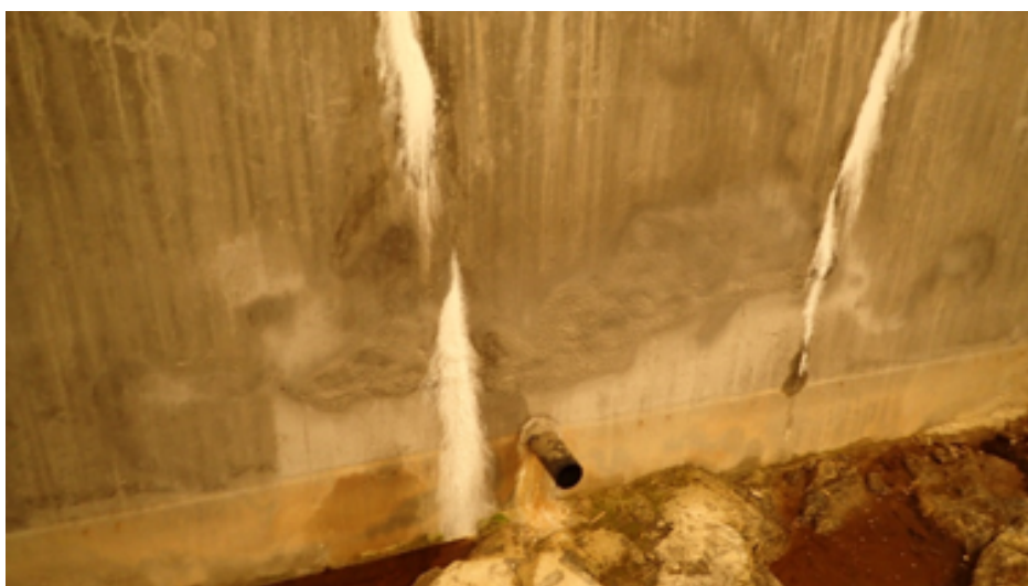
Figur 3-15 – Sprickbildning i en betongvägg i ett inspektionsutrymme i en damm.
