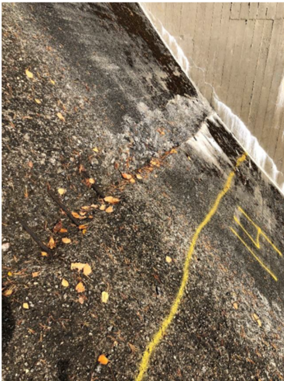
Figur 6-3 – Det täckande betongskiktet har avskalats och armeringen har avtäckts.
