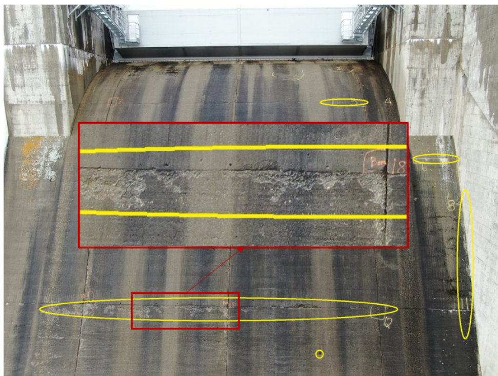
Figur 6-5 – Mindre erosionsskador kring gjutfog.
