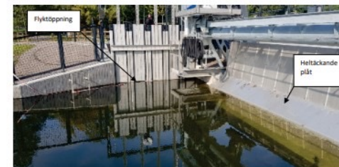
Figur 25. Affagallret med den ytligt monterade heltäckande plåten och rensanordning vid gallrets vänstra sida. Till vänster om gallret syns flyktöppningen, tillika omlöpets inlopp, med fem ställbara luckor.
