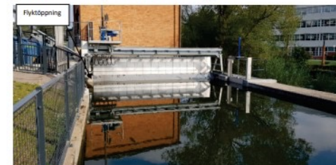
Figur 24. Intagskanalen med affagallret närmast kraftstationen. Flyktöppningen, tillika utskov till omlöpet, är placerat till vänster om gallret. Luckan till höger om gallret utgör lutskov. Vid fotofällat var inte kraftverket i drift.
