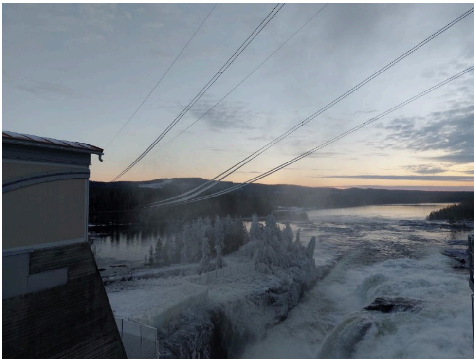
Figur 4-2. Ispåbyggnad på kraftledning som korsar vattenvägen nedströms om utskovsluckorna.
