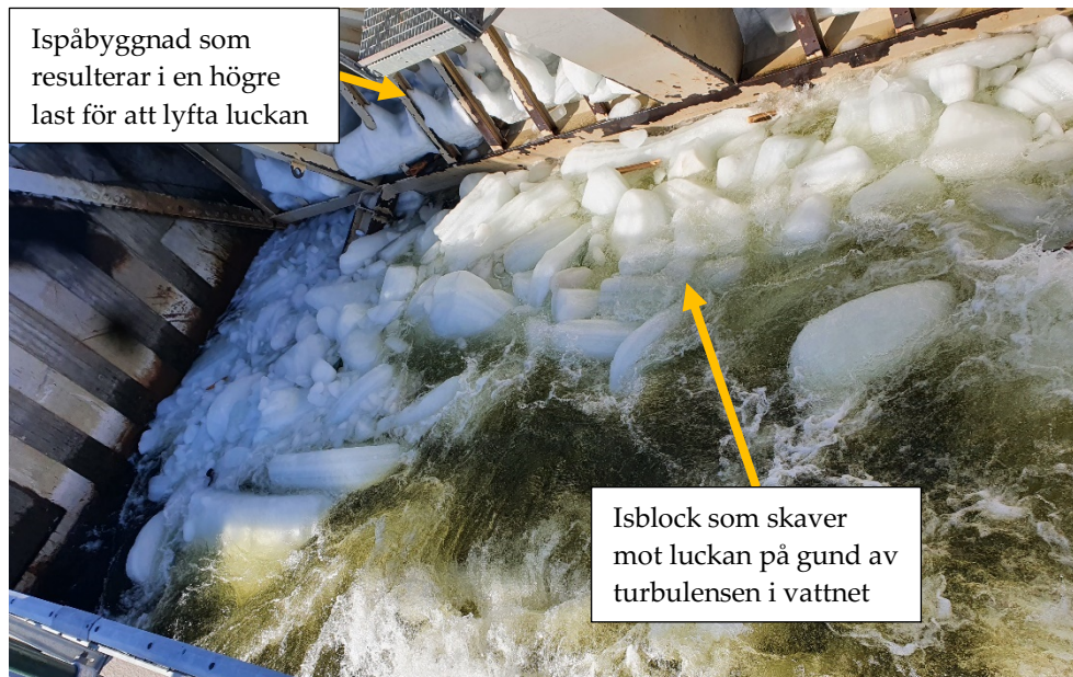
Figur 9-40. Lucka som inte är isolerad eller skyddad på nedströmssidan vilket leder till en högre last på luckan.
