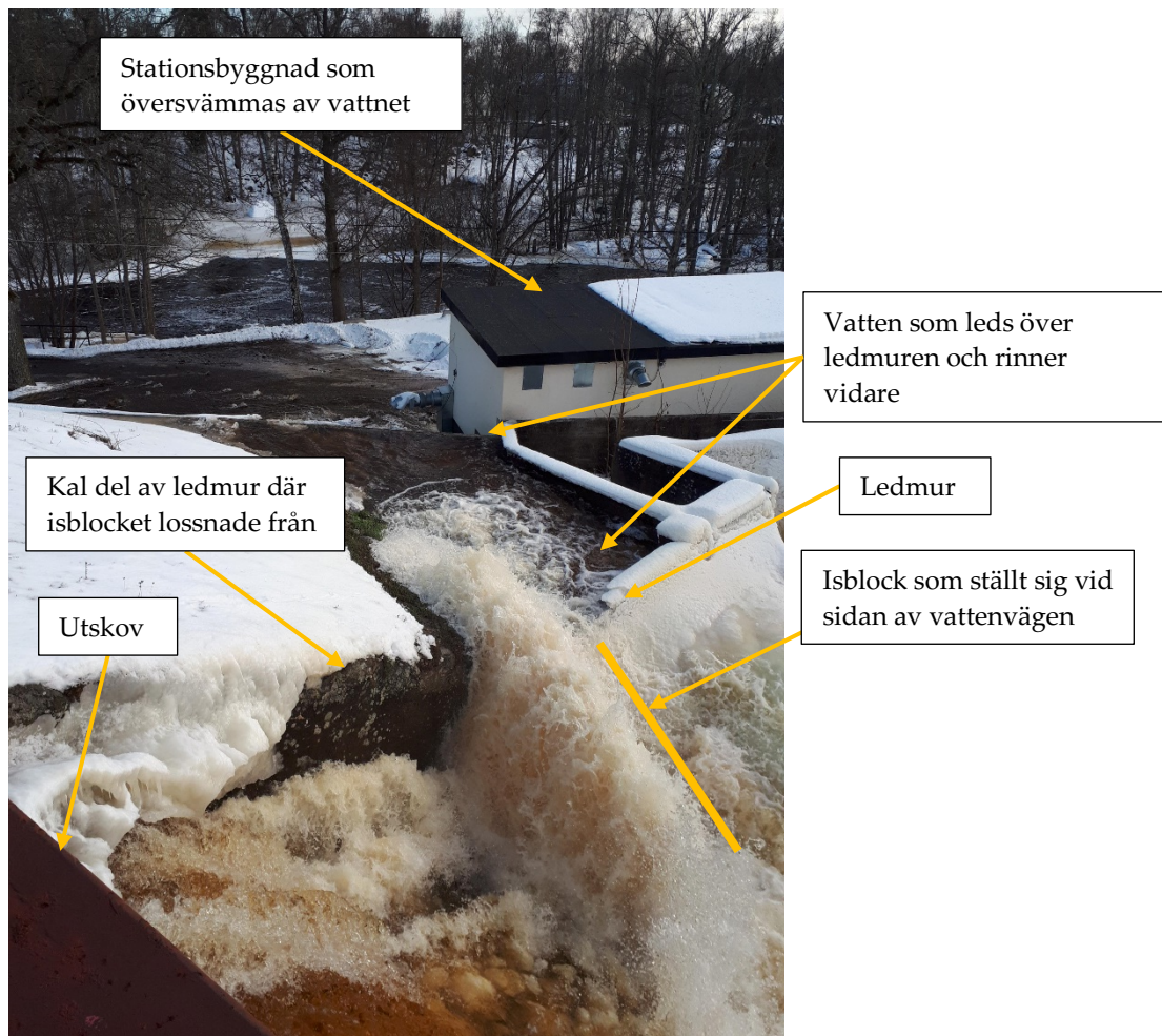
Figur 9-15. Isblock som ställt sig vid sidan av vattenvägen och agerar plog till vattnet som strömmar ut från utskovet. Vattnet lyfts upp över ledmuren så att det sedan kan rinna ner till stationshuset på nedströmssidan. För att åtgärda ispåbyggnad finns det tillgång till en spolbil från ett närliggande pappersbruk. Denna har en högtrycksslang som kan spruta varmvatten upp till 60 m.
