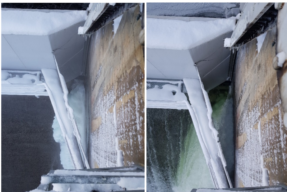
Figur 9-29. Till vänster är luckan stängd. Till höger syns hur ispåbyggnaden påverkar flödet intill pelaren.
