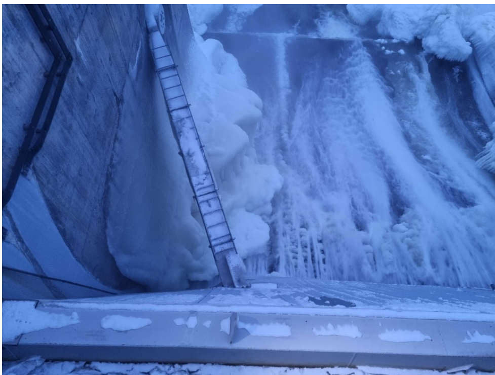
Figur 9-26. Ispåbyggnad på nedströmssidan av luckan under pågående vinterspill.
