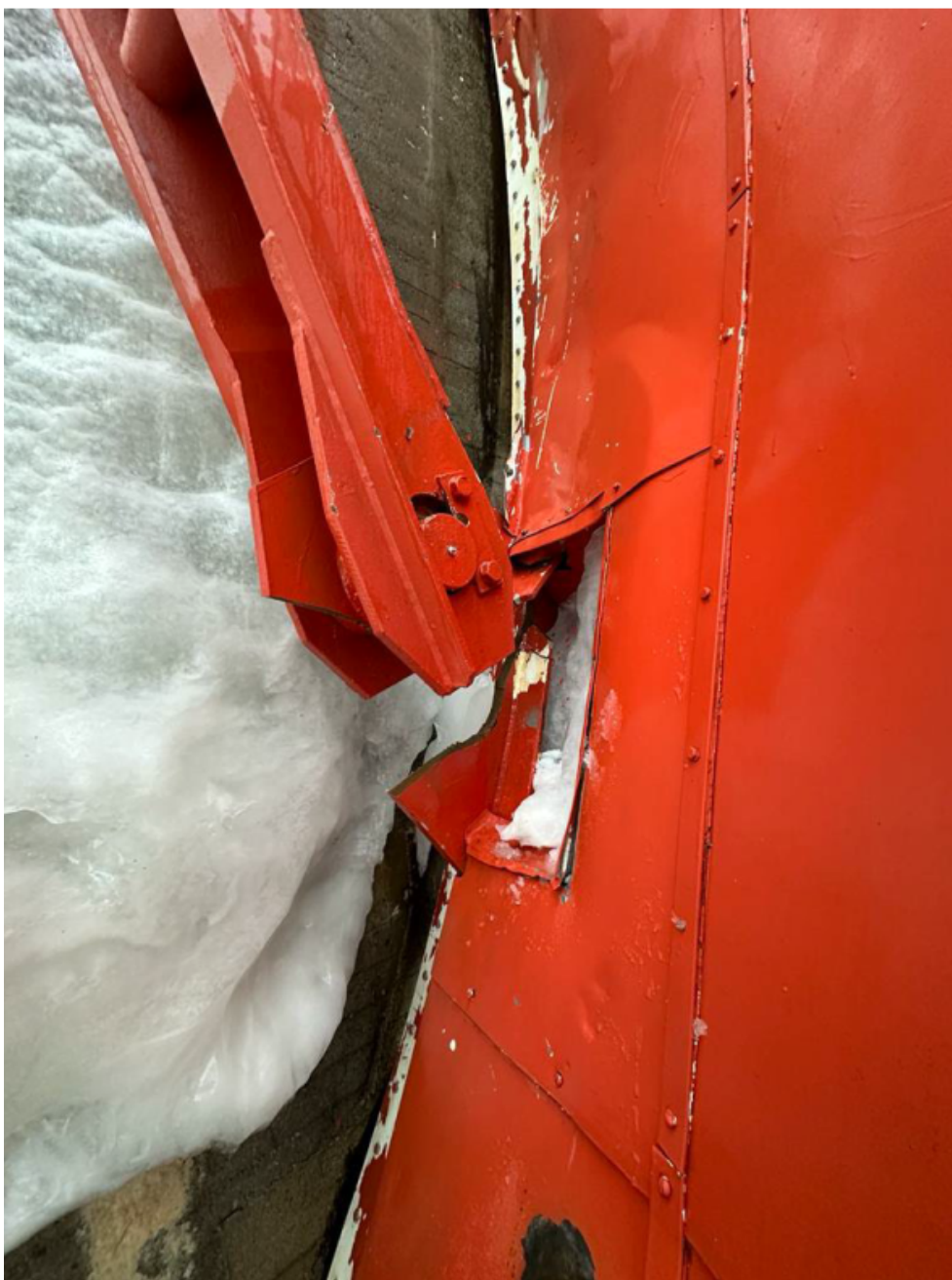
Figur 9-58 Kuggstångens infästningsplåt i luckan har gått av och deformerats.
