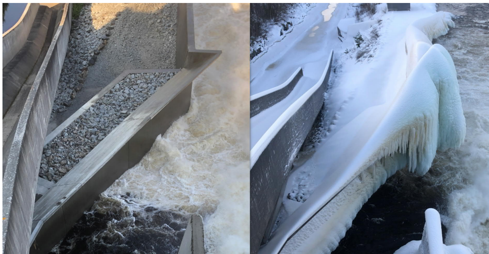
Figur 4-4. Bild av översköljningsskydd på ledmur. Till vänster är det plusgrader, till höger är det minusgrader.
