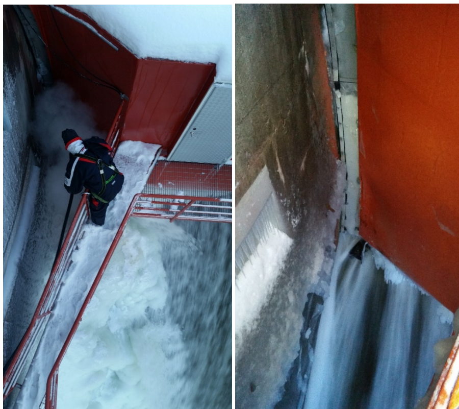
Figur 9-28. Åtgärdsinsats där ånga sprutas med lans från en av luckarmarna. Till höger syns hur det byggs is på sida av pelaren och underkant av luckan.
