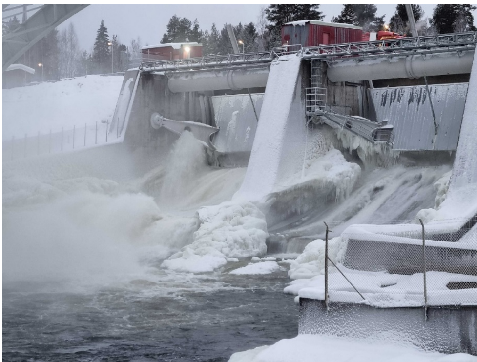
Figur 9-25. Ispåbyggnad på nedströmssidan av luckan under pågående vinterspill. Under luckbenet till vänster i bilden syns ett tydligt vattensprut som uppkommit pga. påfrysning.
