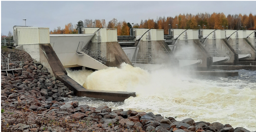
Figur 9-47 Strålyftare (energiomvandling) orsakar problem med stänk som ger isbildning vintertid.
