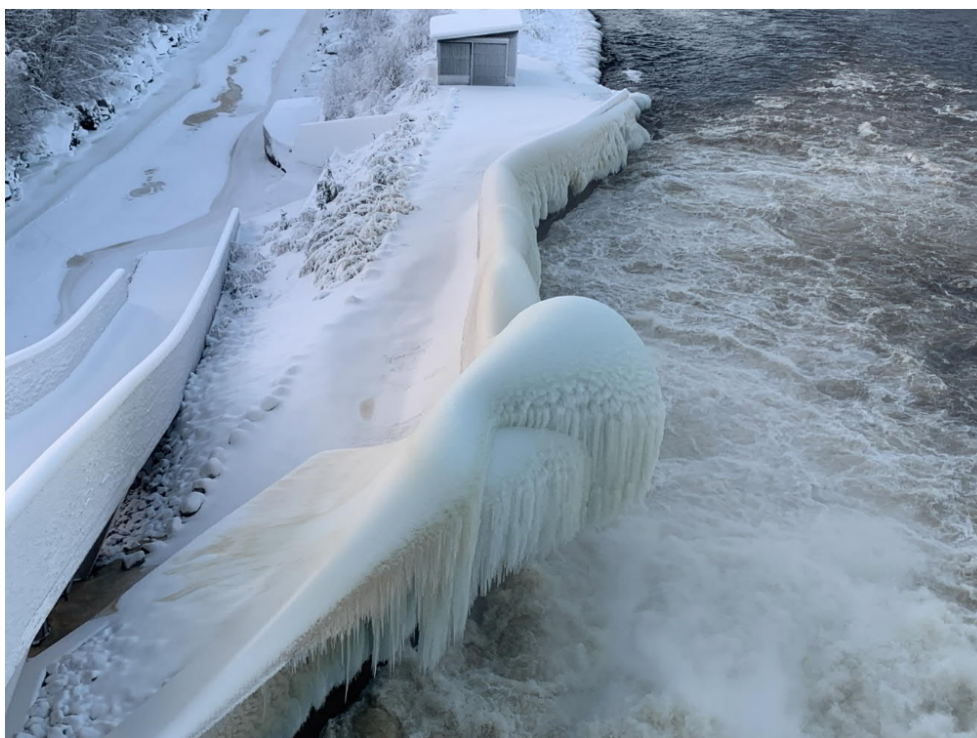
Figur 9-18. Omfattande ispåbyggnad på översköljningskyddet.
