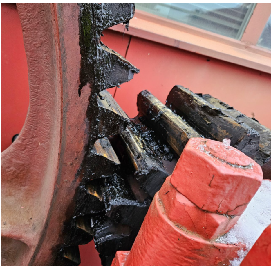
Figur 9-60 Spelets kugghjul har ändrat läge och är inte i korrekt ingrepp samt att axlarna är olinjerade.
