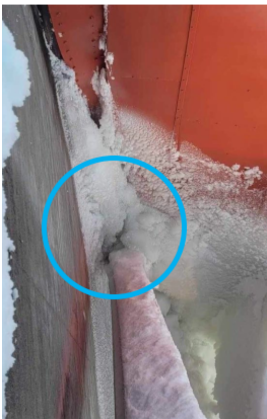
Figur 9-56 Visar på hur isen har byggts upp på höger betongpelare och mellan kuggstången.
