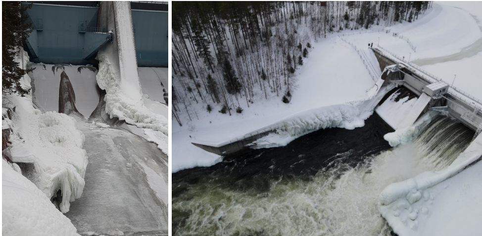
Figur 4-3. Ispåbyggnad på pelare och ledmur.
