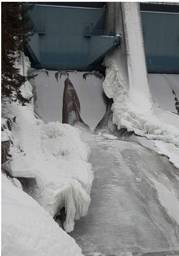
Figur 9-50 Anläggning 3. Isbildning på betongmonolit och under luckben vid vinterspill december 2021 – januari 2022.
