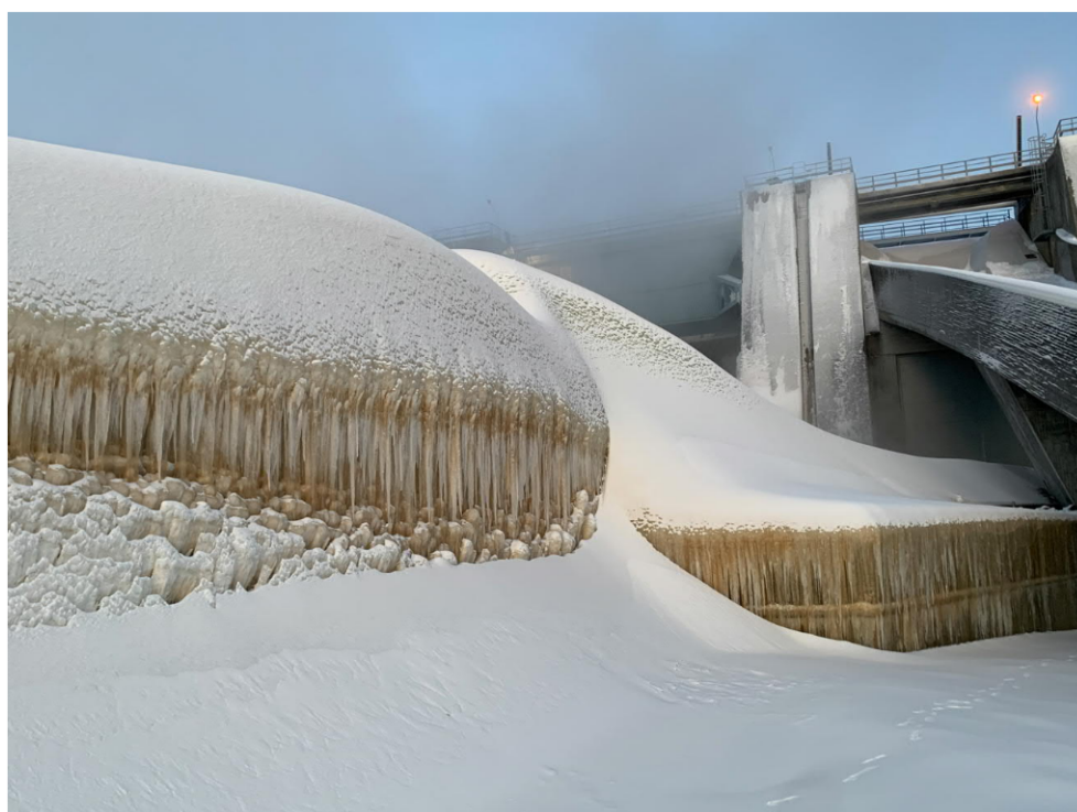
Figur 9-19. Omfattande ispåbyggnad på nedströmssidan av ledmuren.
