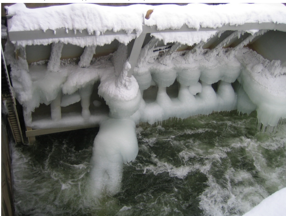
Figur 9-36. Ispåbyggnad på nedströmssidan av luckan med nedströms vattennivå som når upp till ungefär halva luckans höjd. Luckan är öppen, varför det syns mycket rörelse i vattnet.
