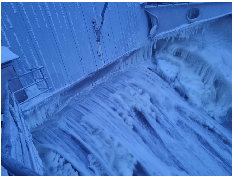
Figur 9-23. Ispåbyggnad på nedströmssidan av luckan under pågående vinterspill.
