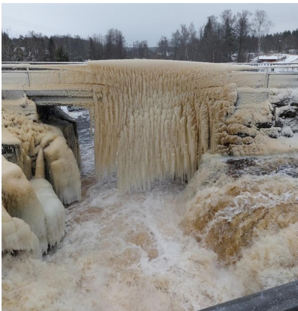
Figur 4-1. Bro strax nedströms av utskoven som presenterar inverkan av ispåbyggnad från vattendimma som bildas under vinterspill.
