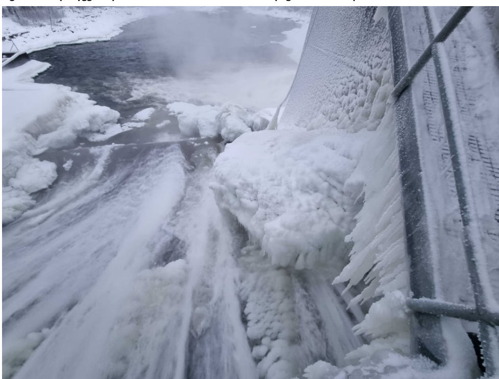
Figur 9-24. Ispåbyggnad på nedströmssidan av luckan under pågående vinterspill.
