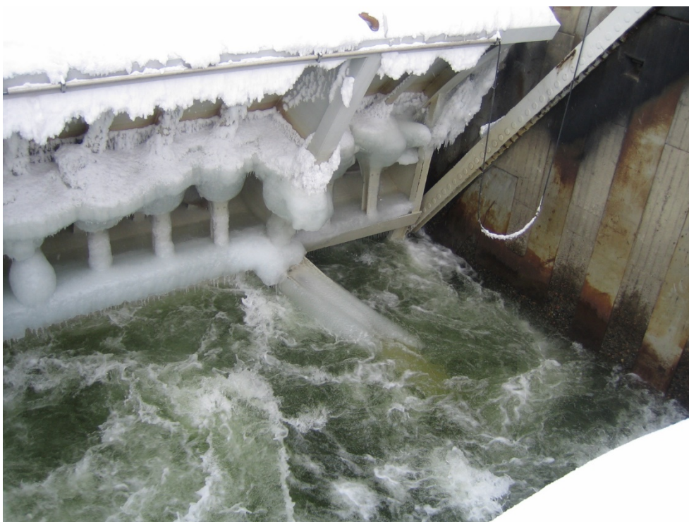
Figur 9-35. Ispåbyggnad på nedströmssidan av luckan med nedströms vattennivå som når upp till ungefär halva luckans höjd. Luckan är öppen, varför det syns mycket rörelse i vattnet.
