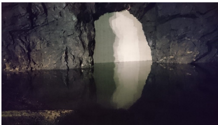
Figur 12 Betongförsegling för att skapa två separata akviferlager i Hudiksvall. Foto: Stefan Svedlund, FVB
