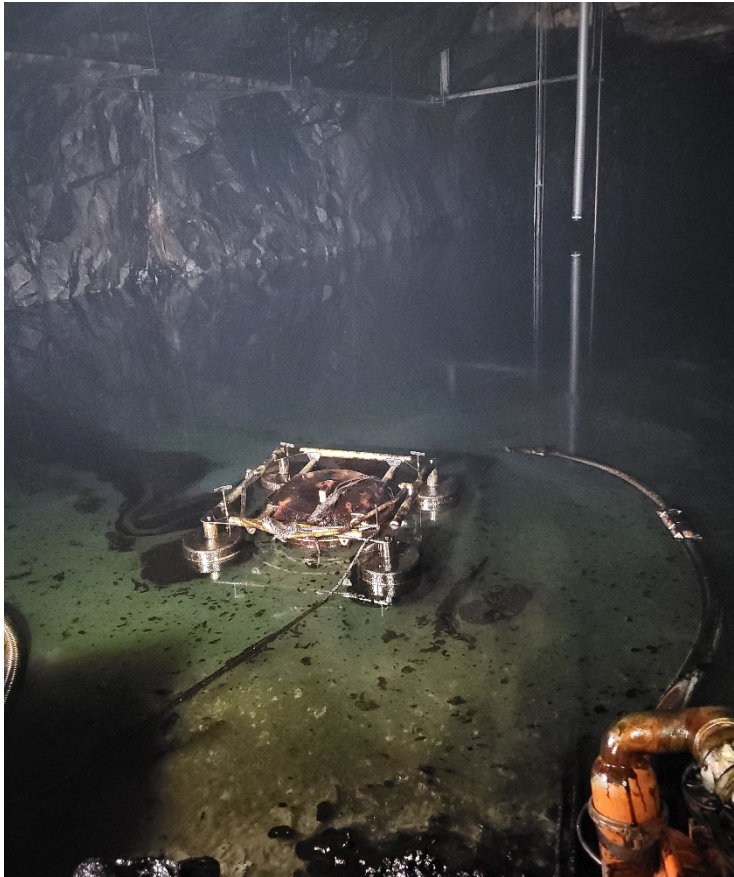
Figur 44 Oljeskimmer som samlar upp och pumpar ut olja från vattenytan i ett av bergrummen. Foto: Mälarenergi.
