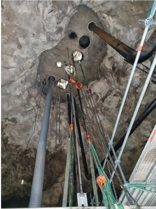
Figur 65 Foto taget från bergrummet mot genomföringarna i cisterntoppen (till servicegången).
