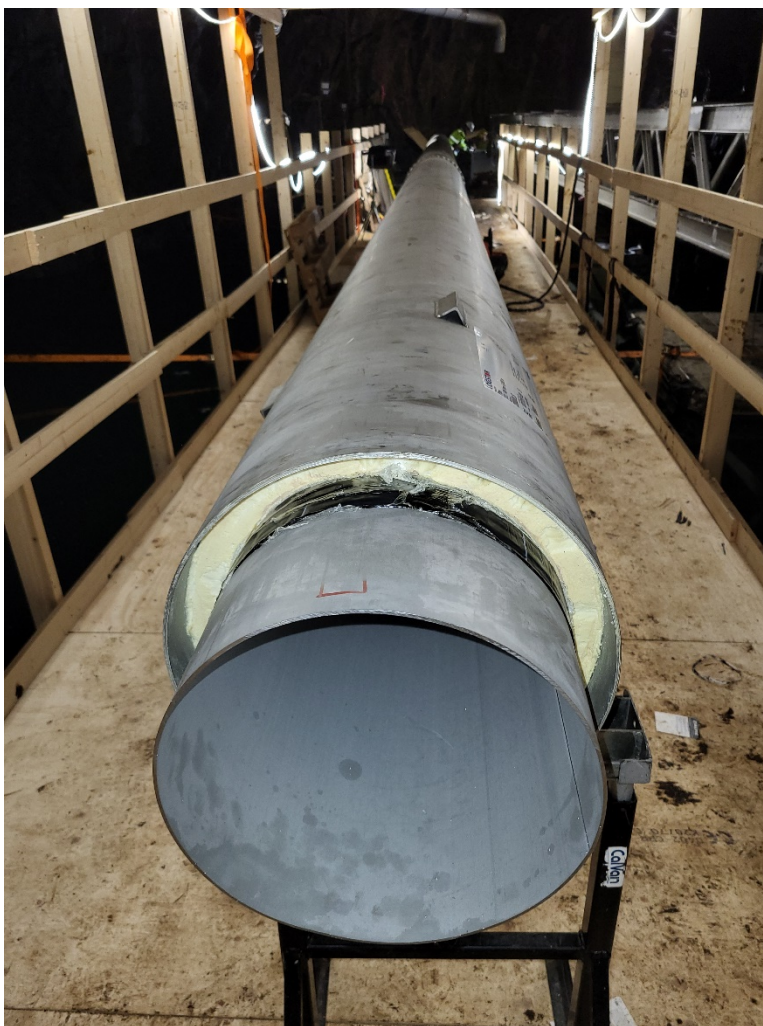
Figur 37 Rörledning som använts i värmelagret; PUR-isolering och mantel i rostfritt stål. Foto: Mälarenergi.
