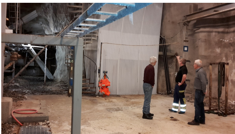
Figur 7 Värmväxlare i titan stod placerade ungefär där personerna på bilden står; utanför gaveln till det numera nedlagda bergvärmelagret (genomföringar bakom den korrugerade plasten). Foto: Ulrika Sagebrand.
