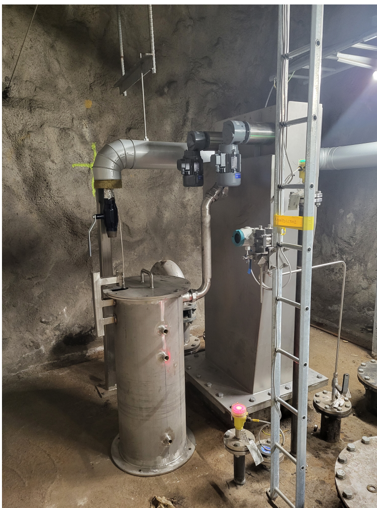
Figur 46 Oljeskimmerinstallation i cisterntopp. Foto: Mälarenergi.
