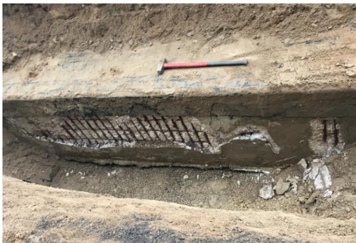
Figur 5. Armeringskorrosion i betongväggar till betongkulvert, Furutorpsgatan i Helsingborg (foto Öresundskraft).
