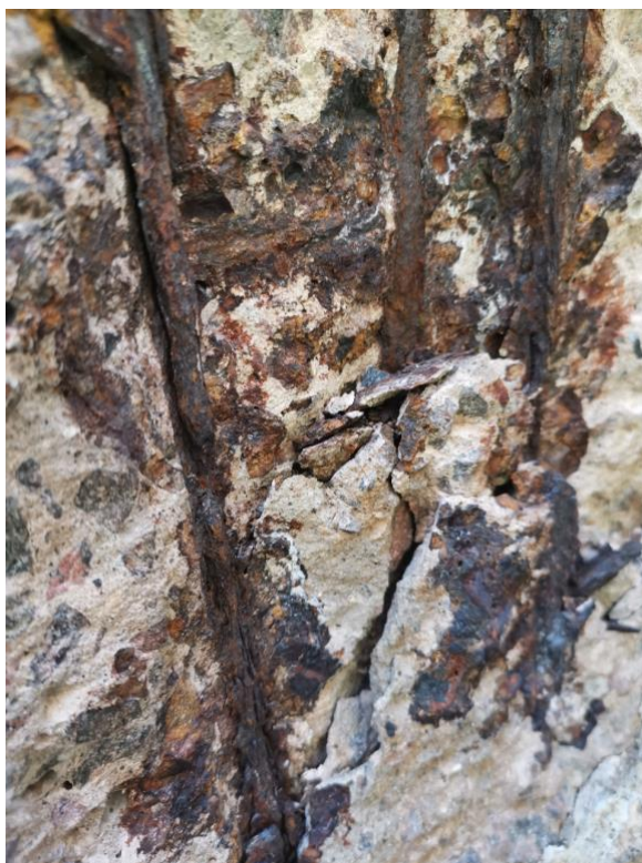
Figur 6. Armeringskorrosion på betongväggar till betongkulvert, Furutorpsgatan i Helsingborg (foto, Öresundskraft).
