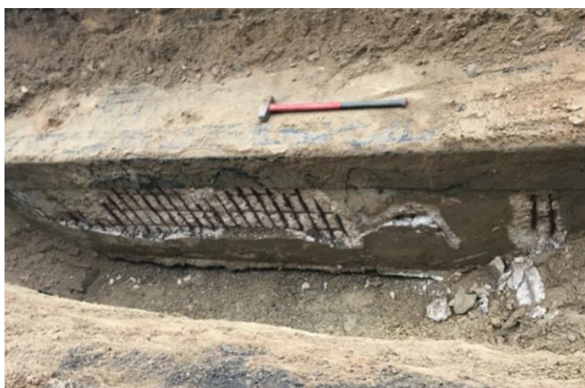
Figur 9. Framschaktad betongkulvert med betongskador orsakad av armeringskorrosion (foto Öresundskraft)
