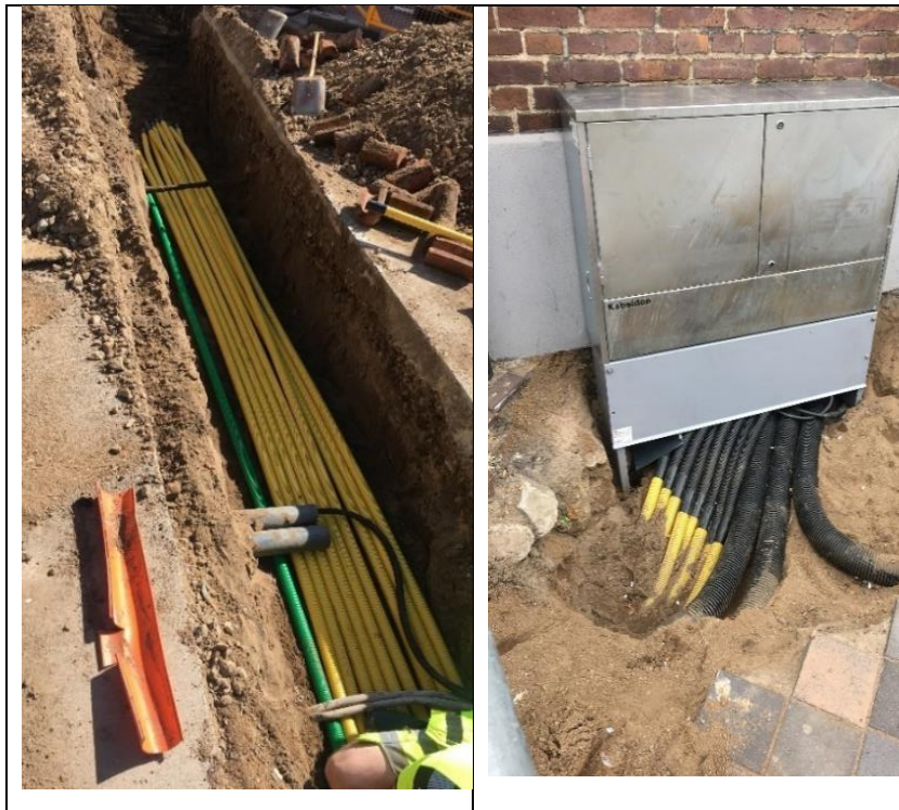
Figur 18. Plaströr för elkablar till det katodiska skyddet och mätskåp för övervakning av det katodiska skyddet (foto Öresundskraft).
