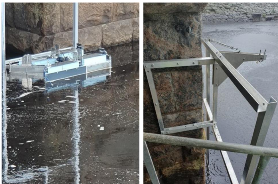
Figur 16 Konsolen (lyftanordning) som monterades strax utanför utskovskulverten, EF:23-uppsamlaren följer nivåfluktuationer i ån med hjälp av två ledskenor. Vid vittjning användes ett kedjeblock för att lyfta EF:23-uppsamlaren.
