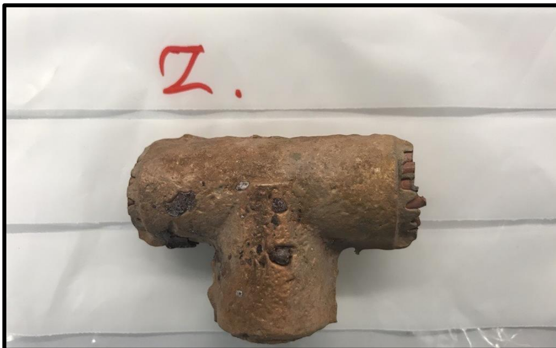
Figur 49: Klämma från prov 2 efter betning, baksida.
