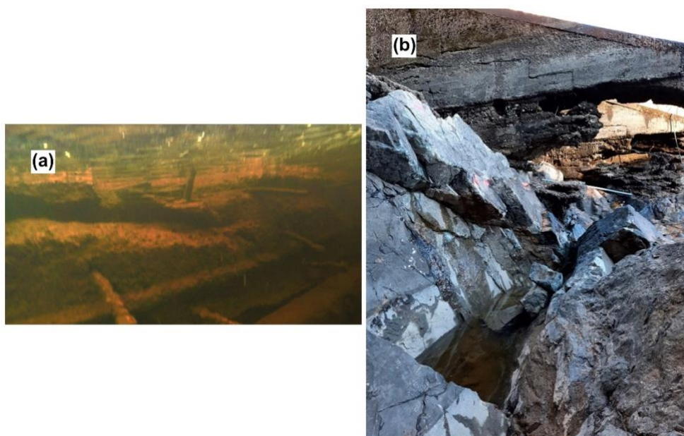
Figur 5 Observerade erosionsskador i området nedanför utskovsluckorna vid (a) utförd dykundersökning år 2016 [12] och (b) utfört platsbesök år 2021 efter torrläggning [11].
