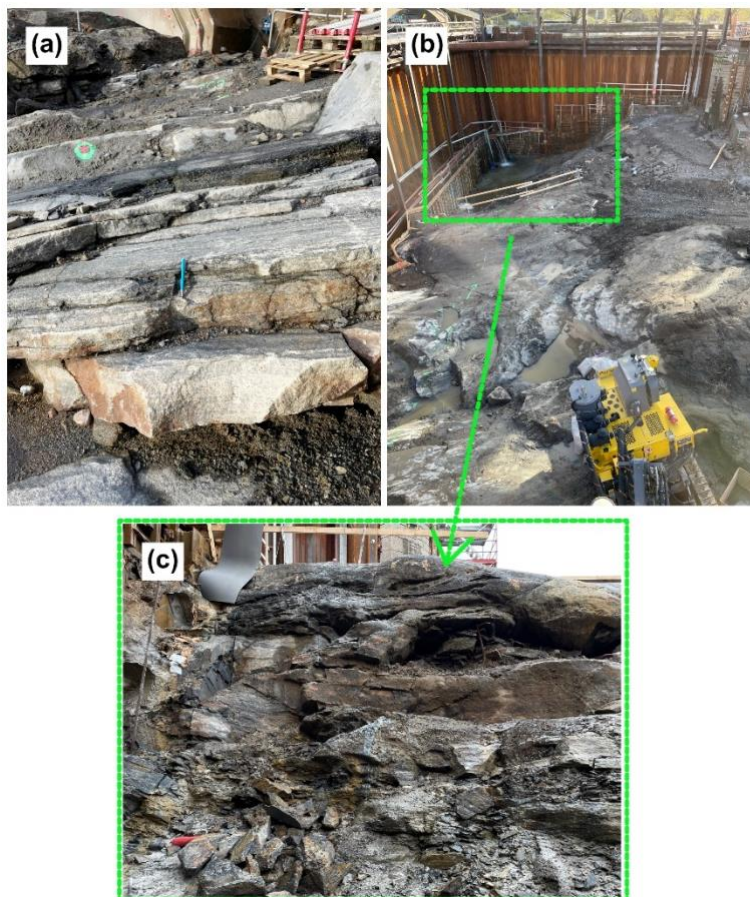
Figur 19 Dammanläggning 2: (a) observerad foliation i bergmassan; (b) övergripande bild över de karterade områdena 1 och 2 med sänkan i berggrunden mot fångdammens hörna; (c) observerad svaghetszon i sänkan med uppsprucket berg och lerfyllda och vattenförande sprickor i foliationsriktningen.
