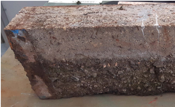
Figur 6. Eroderad och opåverkad yta (under fästplatta).
