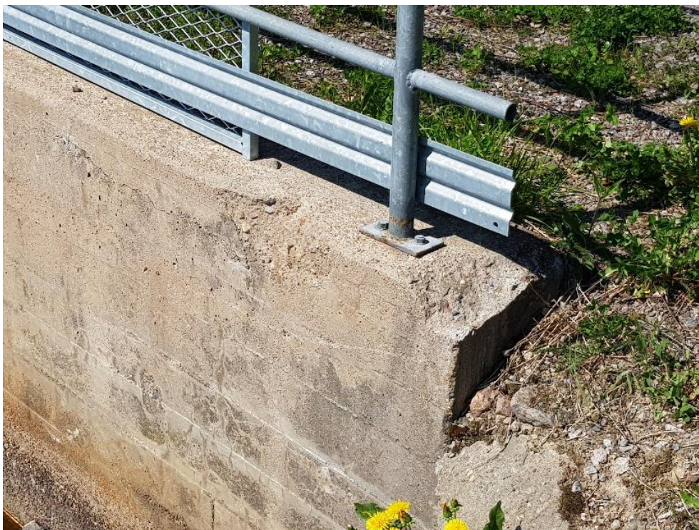
Figur 26 Lokala betongskador på överkanten av en ledmur. Skadans påverkan på konstruktionen bedöms vara i princip obetydlig.
