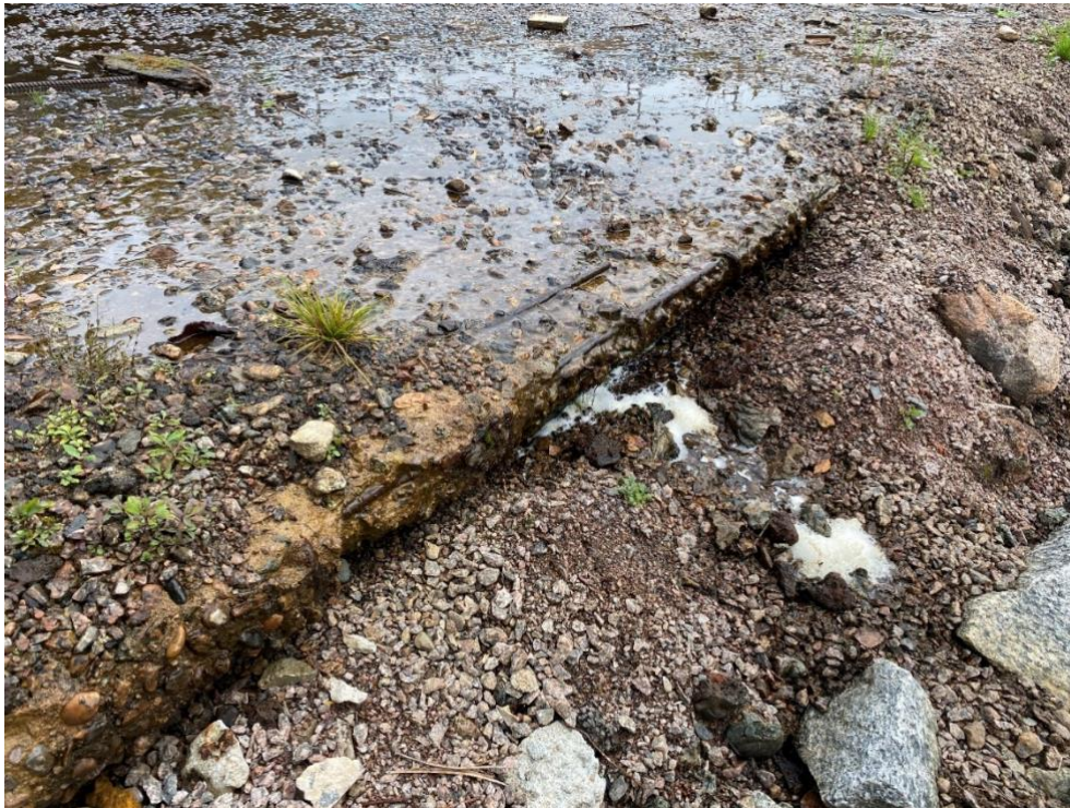
Figur 7 Ett skibord med eroderad yta och enstaka armeringsjärn frilagda. Utbredningen är begränsad och skadans utveckling bedöms som måttligt utvecklad och att den börjar påverka konstruktionens bärrighet, samtidigt som påverkan bedöms bli större på längre sikt.
