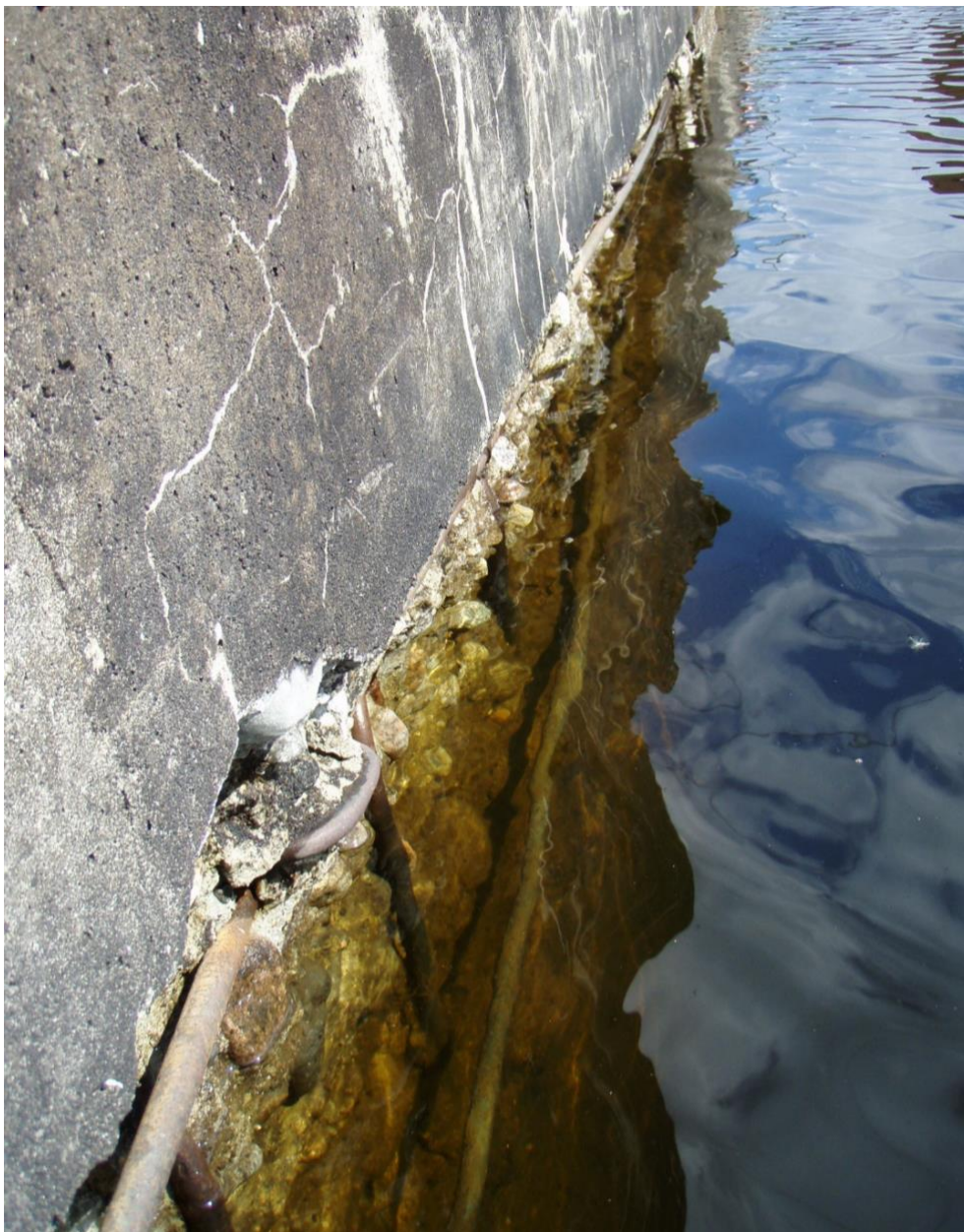
Figur 10 Erosionsskador i uppströmskanten av en kröndamm där armeringen är frilagd över en större yta. Skadan bedöms påverka konstruktionens bärrighet.
