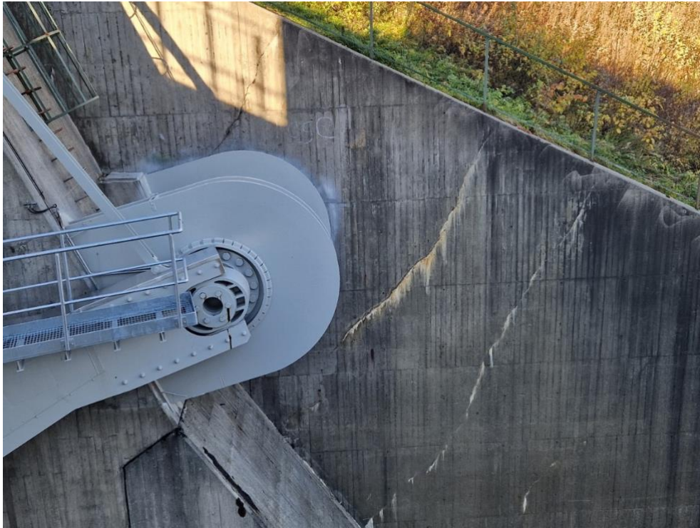
Figur 21 Ett antal sprickor i en pelare varav tre större diagonala som även syns i ovansidan och därför med stor säkerhet är genomgående. Några av sprickorna har vita eller rödbruna utfällningar. Sprickorna bedöms börja påverka konstruktionens bärlighet samtidigt som påverkan bedöms bli större på längre sikt.
