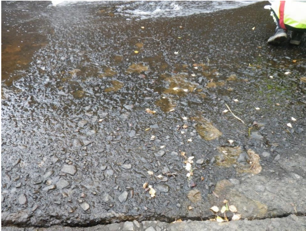
Figur 5 Erosionsskador med frilagd ballast samt några lokala betongskador i ett skibord. Skadan har viss utbredning men är i ett tidigt utvecklingsskede och bedöms inte påverka konstruktionens bärrighet.
