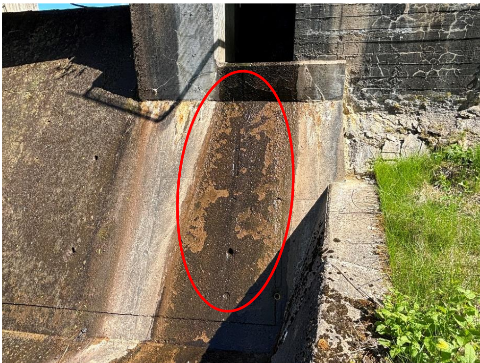
Figur 2 Erosionsskador i ett skibord i form av skrovlig yta. Marginella skador som inte bedöms påverka konstruktionen.
