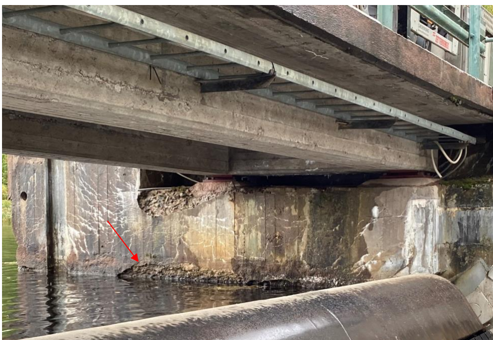
Figur 9 Erosionsskador i vattenlinjen på insidan av en pelare. Ingen armering är synlig men avnötningen är så pass omfattande att den bedöms börja påverka konstruktionens bärighet samtidigt som påverkan bedöms bli större på längre sikt.
