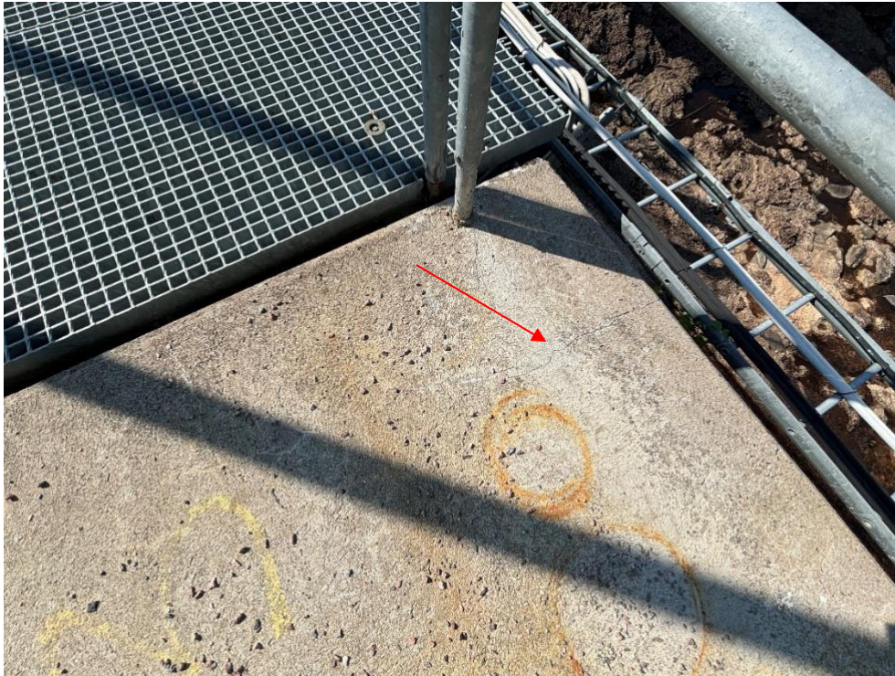
Figur 15 Spricka i nedströmskanten av en pelare som identifieras på handnära avstånd. Påverkan på konstruktionen bedöms vara i princip obetydlig.
