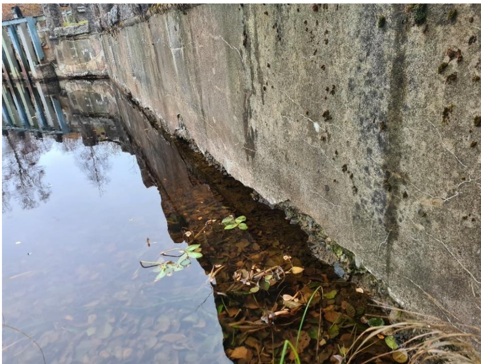
Figur 8 Erosionsskador i uppströmskanten av en anslutningsmur som i princip löper längs med hela muren. Ingen armering är synlig men avnötningen är så pass omfattande att den bedöms börja påverka konstruktionens bärighet samtidigt som påverkan bedöms bli större på längre sikt.
