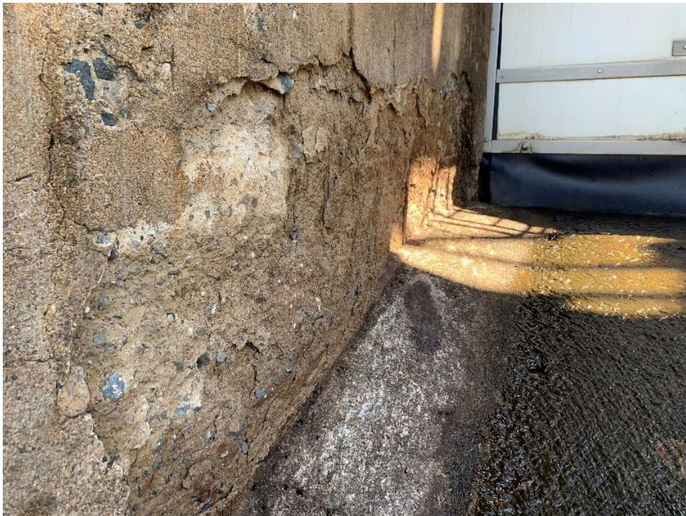
Figur 34 Betongskada på insidan av en pelare som börjar strax bakom fals och fortsätter nedströms åt. Armeringen är delvis synlig och utbredning är relativt stor. Skadan bedöms börja påverka konstruktionens bärrighet samtidigt som påverkan bedöms bli större på längre sikt.
