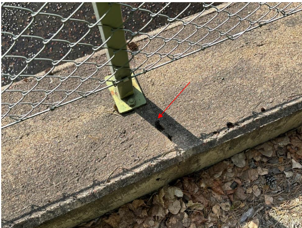
Figur 16 Spricka i krönet på en ledmur nedströms som identifieras på handnära avstånd. Påverkan på konstruktionen bedöms vara i princip obetydlig.
