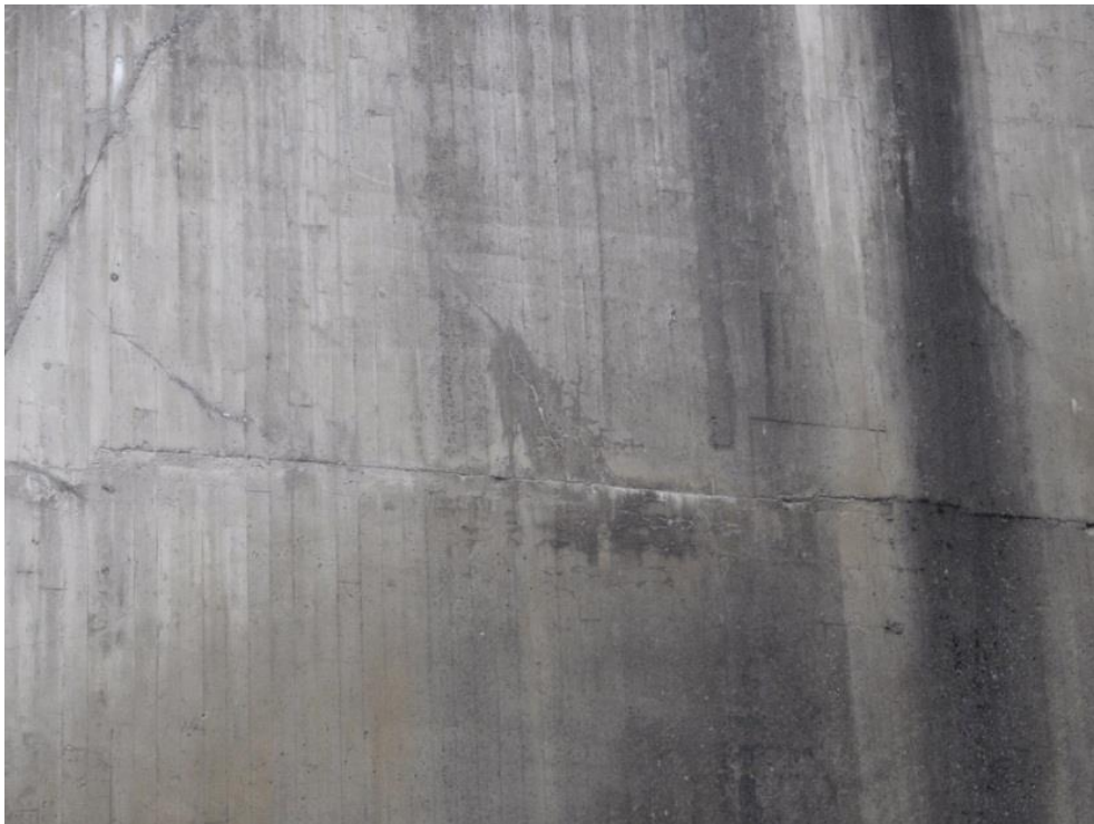
Figur 19 Sprickor med marginellt läckage och mindre vita utfällningar i pelarsida. Sprickorna bedöms inte påverka konstruktionens bärrighet.
