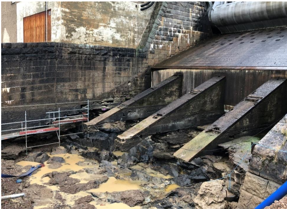
Figur 13 Kraftigt eroderat skibord i nedströmsdelen. Både betong och berg har eroderat. Påverkan är så pass stor att konstruktionsdelen kan räknas som ur funktion.
