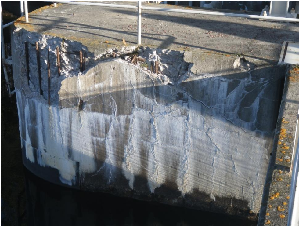
Figur 23 Omfattande skadeutveckling av sprickor (orsakade av så kallade ASR-reaktioner) i en pelare med frilagd armering. Skadorna bedöms påverka konstruktionens bärrighet och tillståndet är otillfredsställande.
