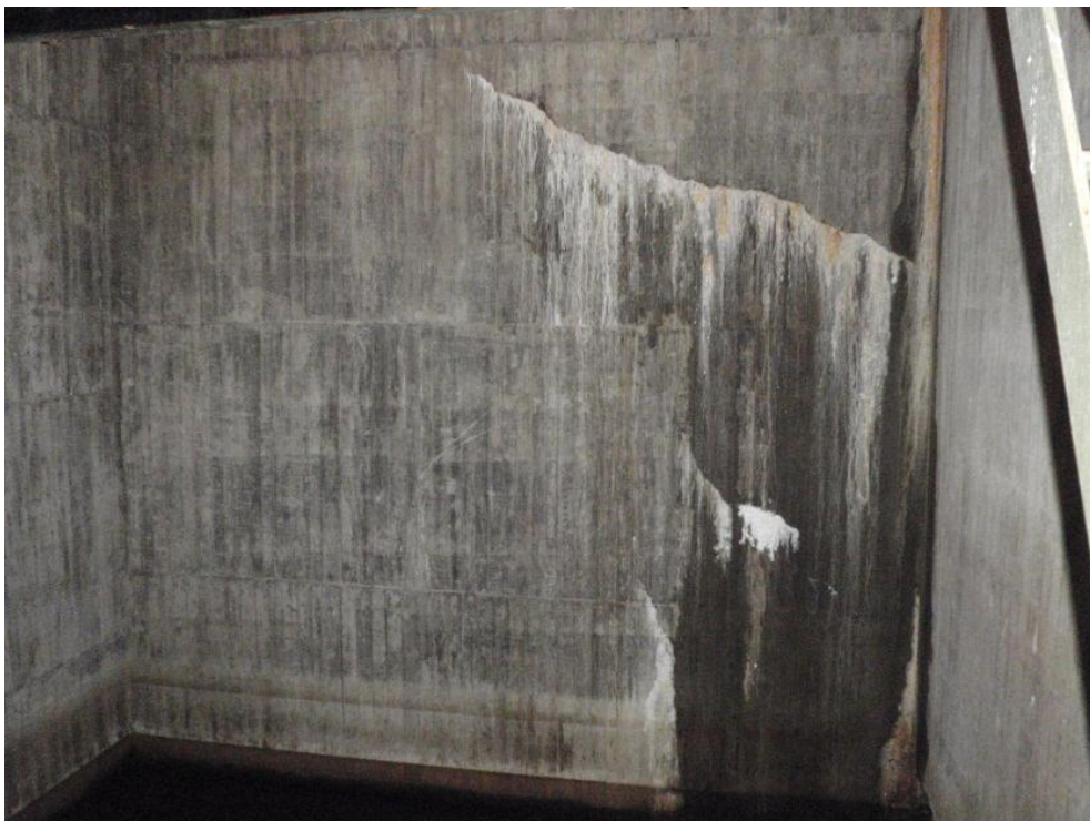
Figur 22 Sneda sprickor med vita och rödbruna utfällningar på en uppströmsvägg i ett utskov. Sprickorna bedöms börja påverka konstruktionens bärlighet samtidigt som påverkan bedöms bli större på längre sikt.
