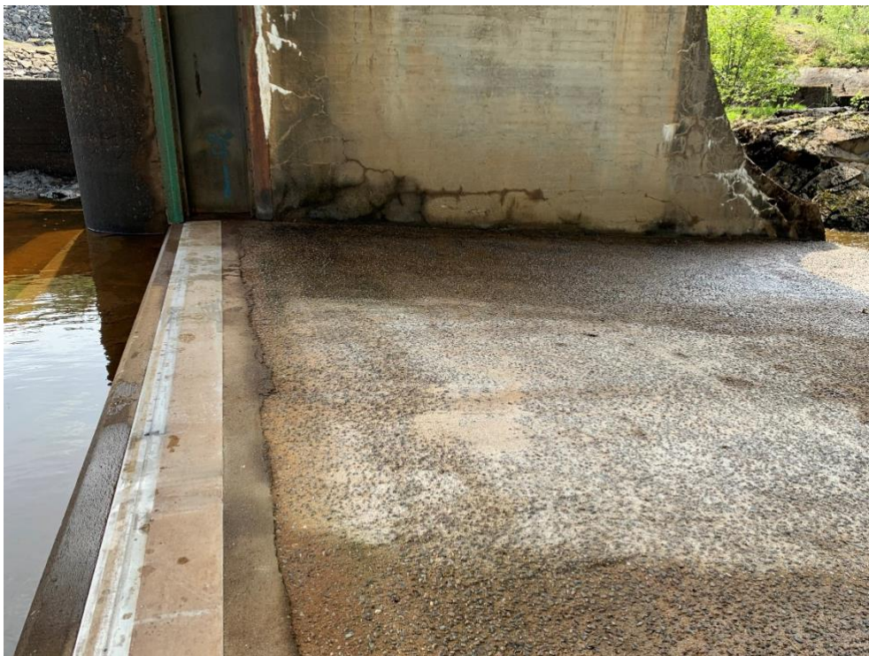
Figur 6 Erosionsskador med frilagd ballast i ett skibord. Skadan omfattar hela ytan men är i ett tidigt utvecklingsskede och bedöms inte påverka konstruktionens bärrighet.
