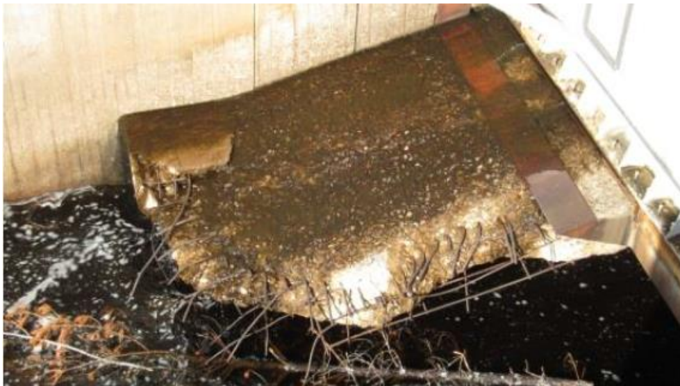
Figur 38 Ett skibord med omfattande betongskador där ingående armering har skadats och på vissa ställen gått av. Skadan bedöms påverka konstruktionen så pass mycket att konstruktionen kan räknas som ur funktion.
