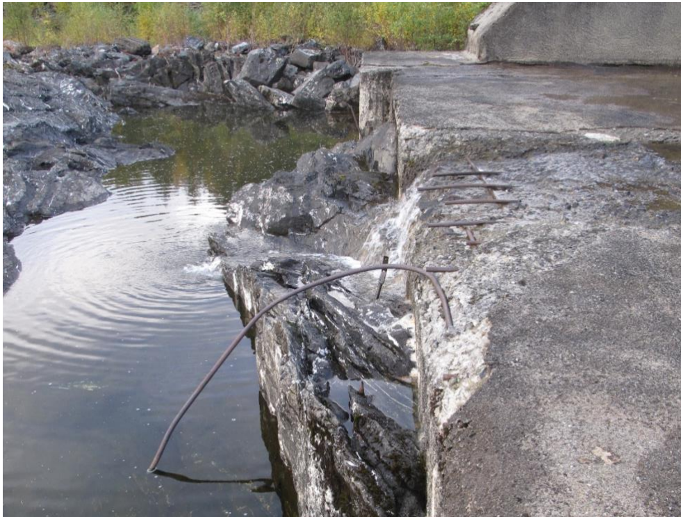
Figur 36 Betongskada med frilagd armering som delvis är skadad i nedströmsdel av skibord. Något armeringsjärn har gått av men skibordet bedöms fortfarande uppfylla sin funktion. Skadan bedöms dock påverka konstruktionens bärrighet och tillståndet bedöms som otillfredsställande.
