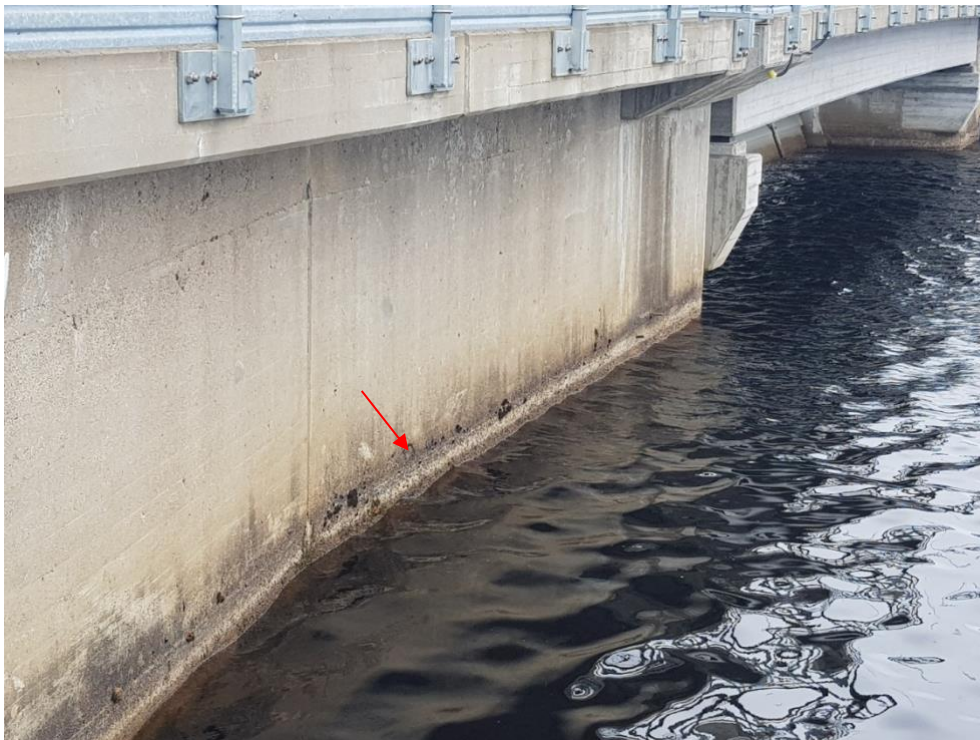
Figur 1 Erosionsskada i vattenlinje på uppströmssidan av en pelare/mur i form av skrovlig yta. Utbredning är relativt stor men skadorna är marginella och bedöms inte påverka konstruktionen.
