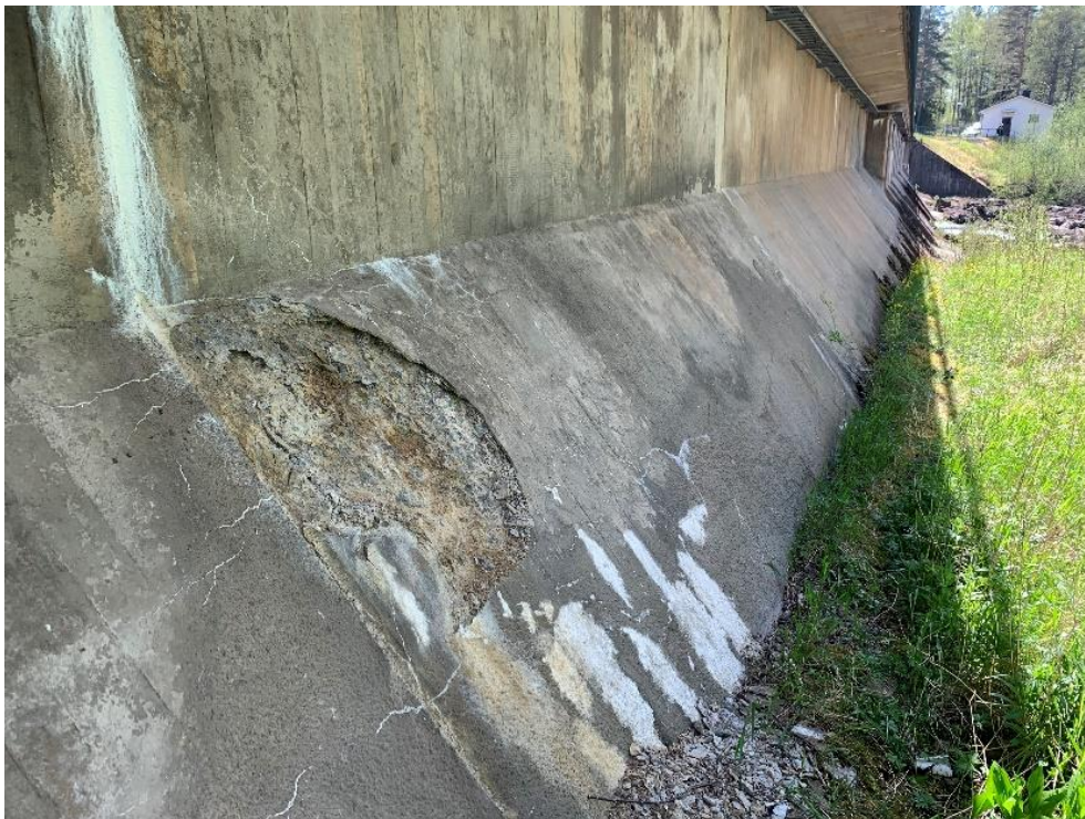
Figur 29 Betongskada i en anslutningsmur med begränsad utbredning där betong släppt på en yta som ser ut att kunna vara sprutbetong. Skadan bedöms inte påverka konstruktionens bärrighet.
