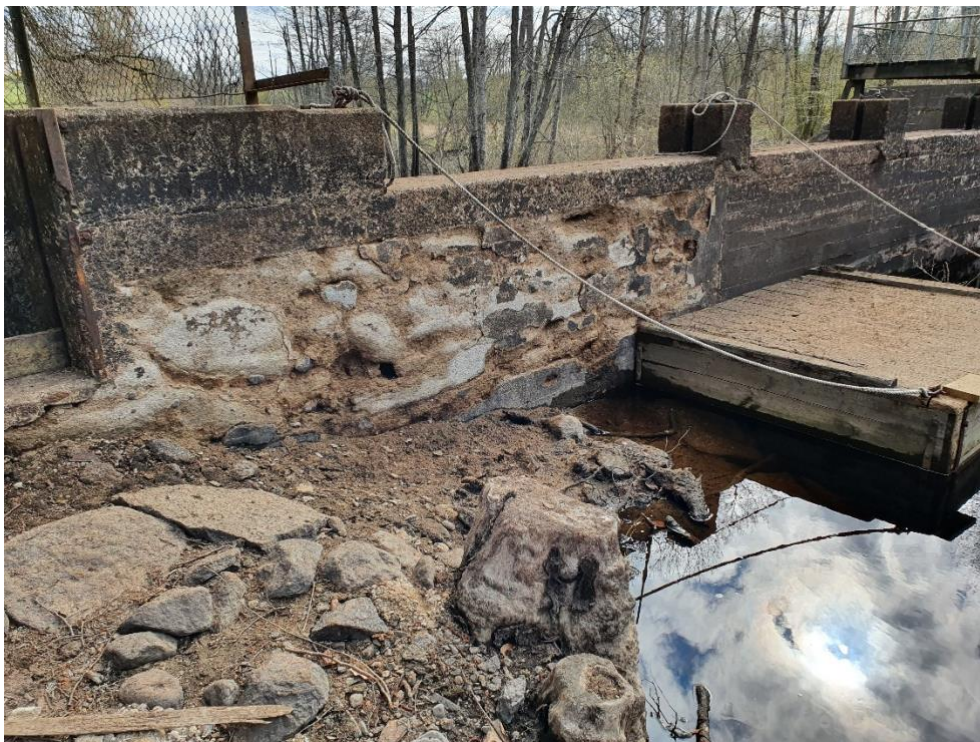
Figur 37 Skadad frontvägg i en låg lamelldamm. Betong som bestod av sand och grus kunde karvas ut med handen. Konstruktionen var i princip oarmerad. Skadan bedöms påverka konstruktionens bärrighet och tillståndet bedöms som otillfredsställande.
