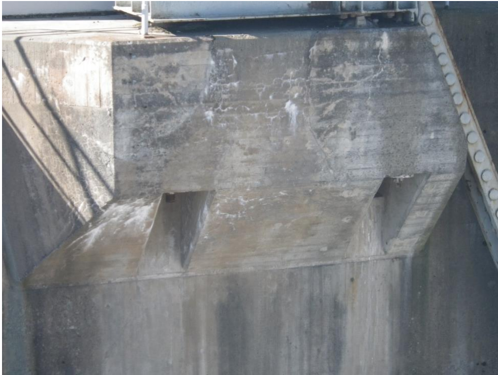
Figur 18 Sprickor med mindre vita utfällningar på en pelarkonsol nedströms. Sprickvidden är liten och sprickorna bedöms inte påverka konstruktionens bärrighet.
