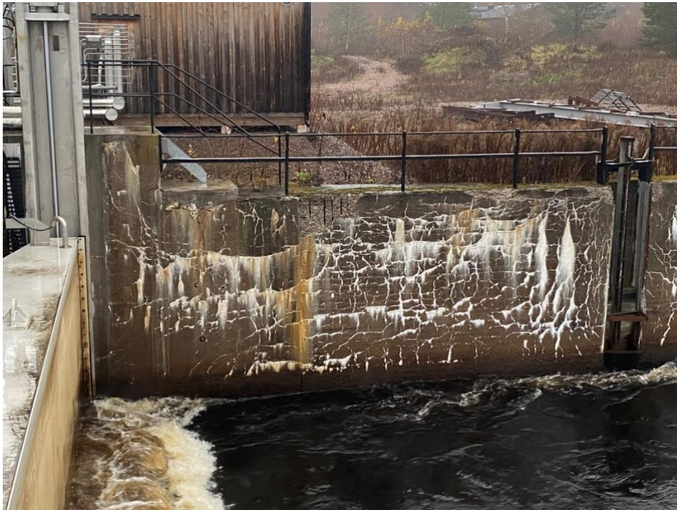
Figur 20 Omfattande skadebild med sprickor som har både vita och rödbruna utfällningar på en uppströmsliggande ledmur. Sprickorna bedöms börja påverka konstruktionens bärrighet samtidigt som påverkan bedöms bli större på längre sikt.
