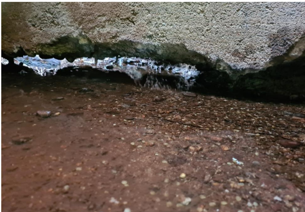
Figur 12 En underminerad betongmur i bottenutskov längs en sträcka av ca 1,5 m orsakat av erosion. Skadan bedöms påverka konstruktionens bärrighet.
