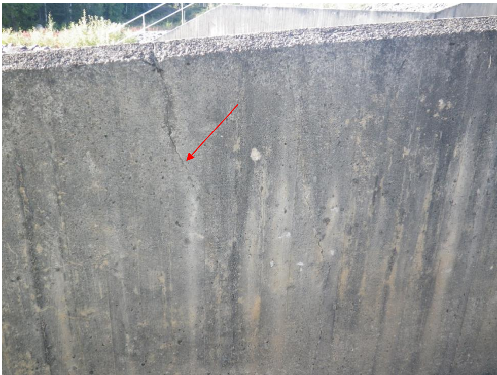
Figur 14 Sprickor i en ledmur nedströms som identifieras på nära avstånd med liten sprickvidd. Inga läckage genom sprickan. Påverkan på konstruktionen bedöms vara i princip obetydlig.
