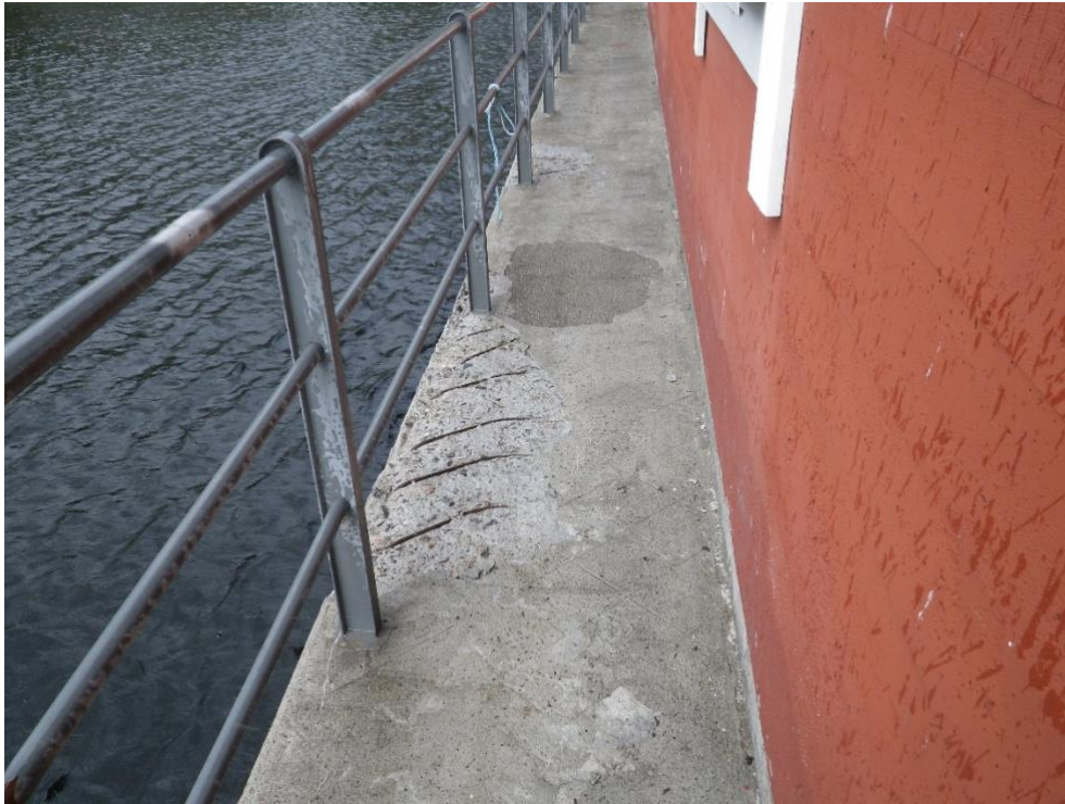
Figur 33 Ytlig betongskada med synlig armering i överkanten på ett intag. Skadan bedöms börja påverka konstruktionens bärrighet samtidigt som påverkan bedöms bli större på längre sikt.
