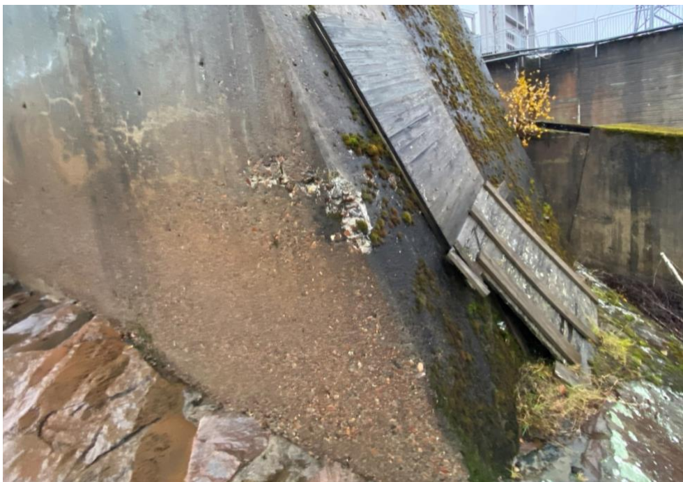
Figur 28 Lokal betongskada i nedströmskanten av en pelare. Skadans påverkan på konstruktionen bedöms vara i princip obetydlig.
