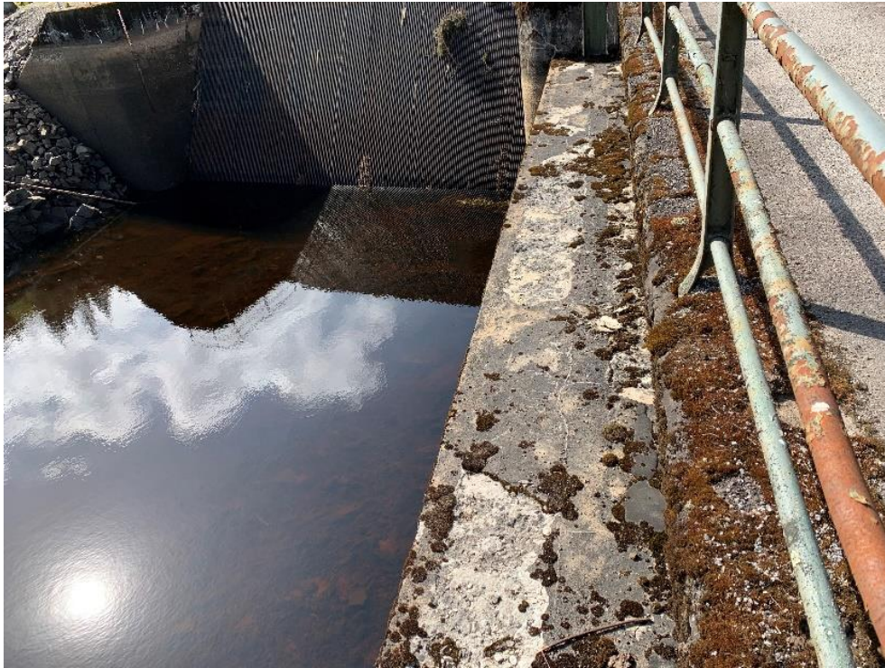
Figur 27 Betong som släppt i överkant på en överfallströskel. Skadans påverkan på konstruktionen bedöms vara i princip obetydlig.
