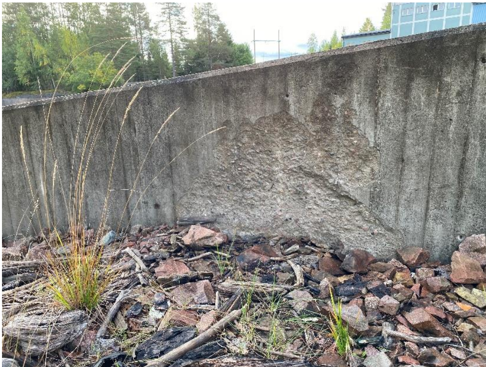
Figur 31 Betongskada på en ledmur nedströms med begränsad skadebild och utbredning. Skadan bedöms inte påverka konstruktionens bärrighet.
