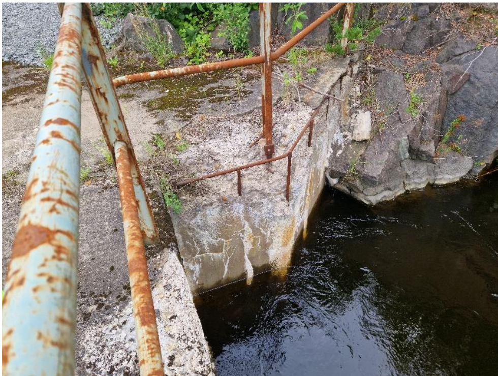
Figur 35 Betongskada i överkant av en pelare med frilagd armering över ett större område. Skadan bedöms påverka konstruktionens bärighet och tillståndet bedöms som otillfredsställande.
