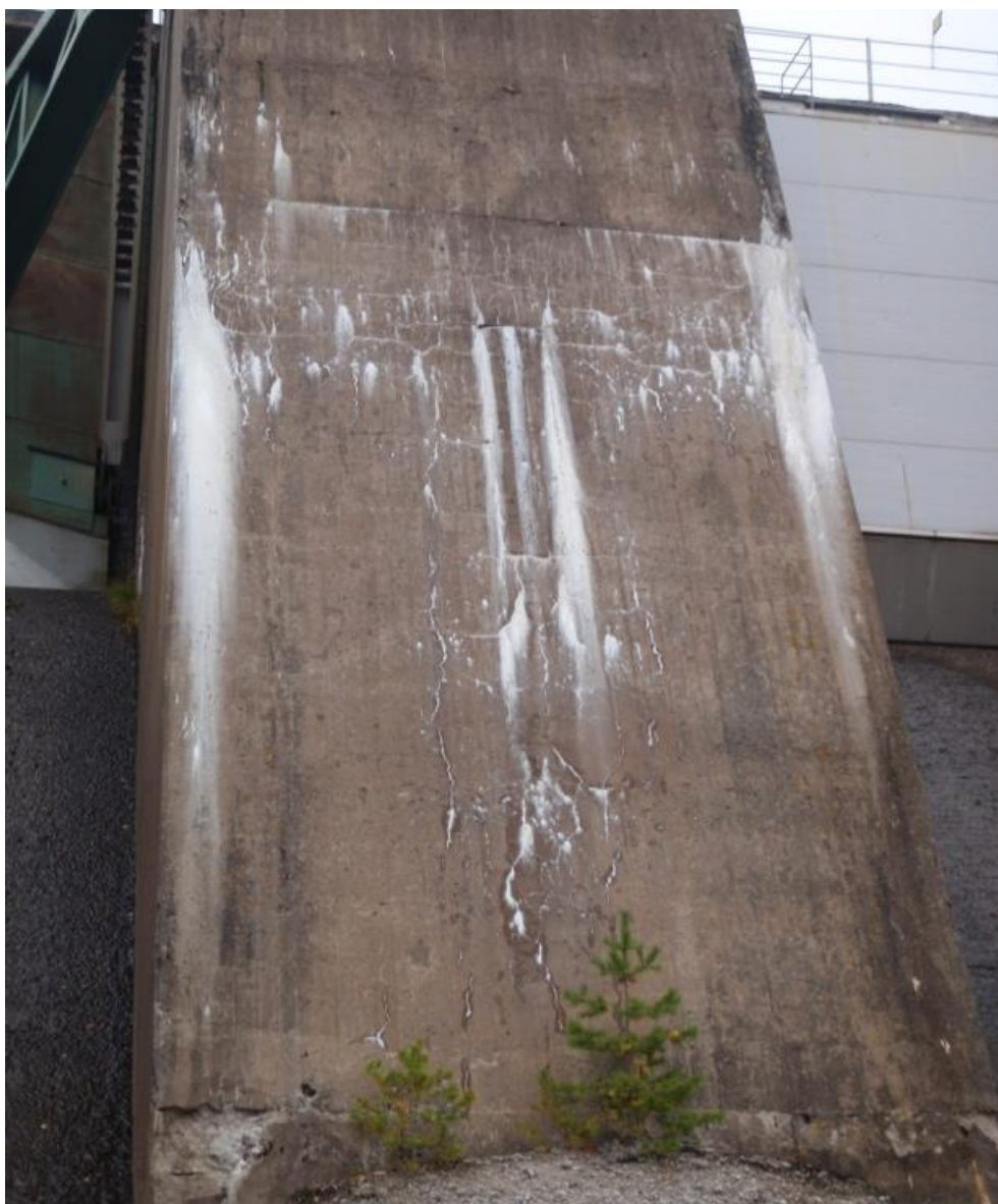
Figur 17 Sprickor med vita utfällningar på nedströmssidan av en pelare. Sprickvidden är liten och sprickorna bedöms inte påverka konstruktionens bärrighet.
