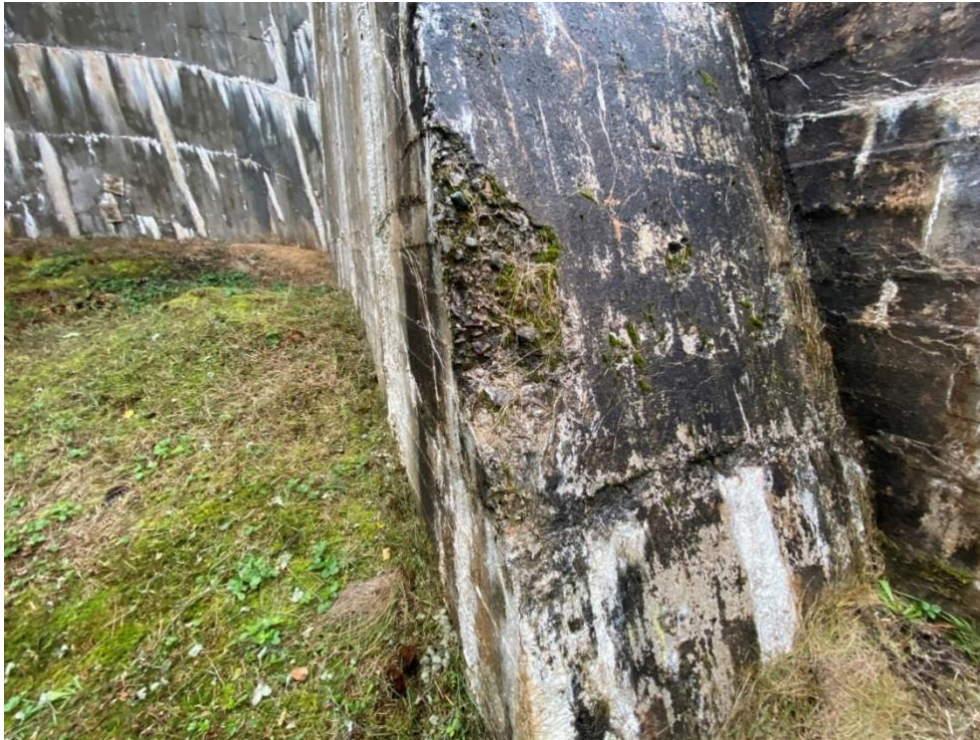
Figur 30 Betongskada i nedströmskanten av en pelare med begränsad skadebild och utbredning. Skadan bedöms inte påverka konstruktionens bärrighet.
