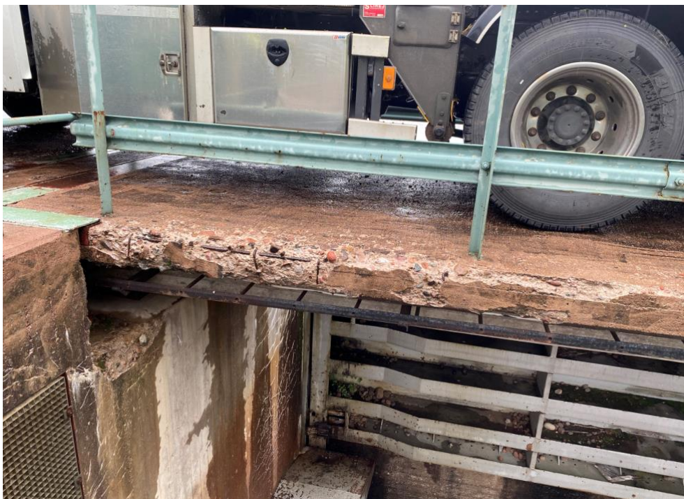
Figur 32 Betongskada med synlig armering på nedströmskanten av en brobana. Skadan bedöms börja påverka konstruktionens bärighet samtidigt som påverkan bedöms bli större på längre sikt.
