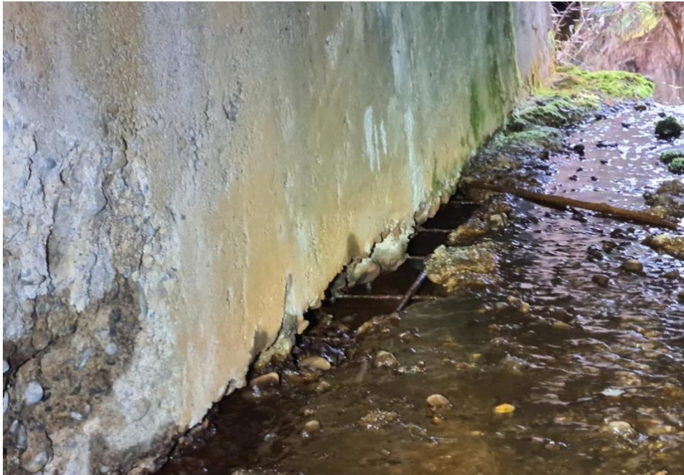
Figur 11 Erosionsskador i ett skibord med frilagd armering över större yta där även betong saknas. Tillståndet är otillfredsställande och skadan bedöms påverka konstruktionens bärrighet.
