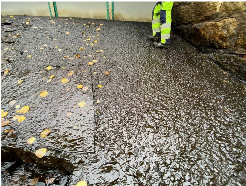
Figur 4 Erosionsskadat skibord som uppvisar frilagd ballast. Skadebilden har en stor utbredning men är i ett tidigt utvecklingsskede och bedöms inte påverka konstruktionens bärrighet.
