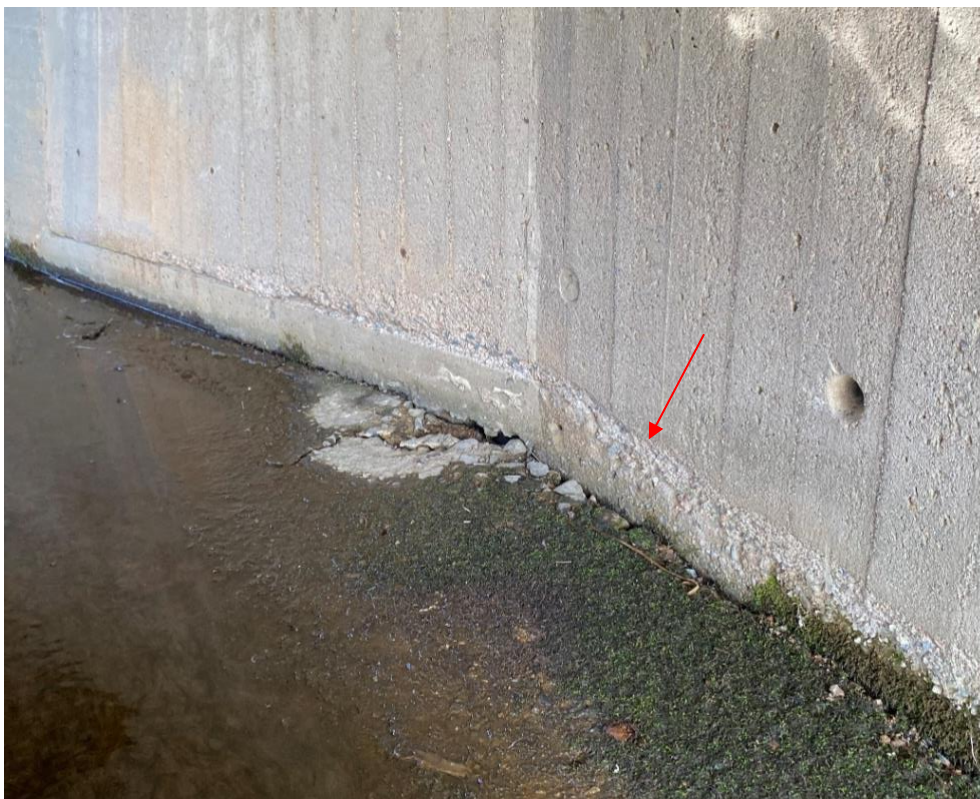
Figur 3 Erosion på en pelarvägg nedströms lucka. Skadorna är marginella och bedöms inte påverka konstruktionen.
