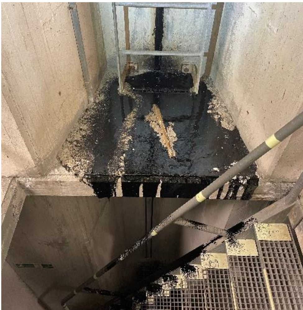
Figur 18. Bitumenläckage inuti en anläggning. Bild från platsbesök.
