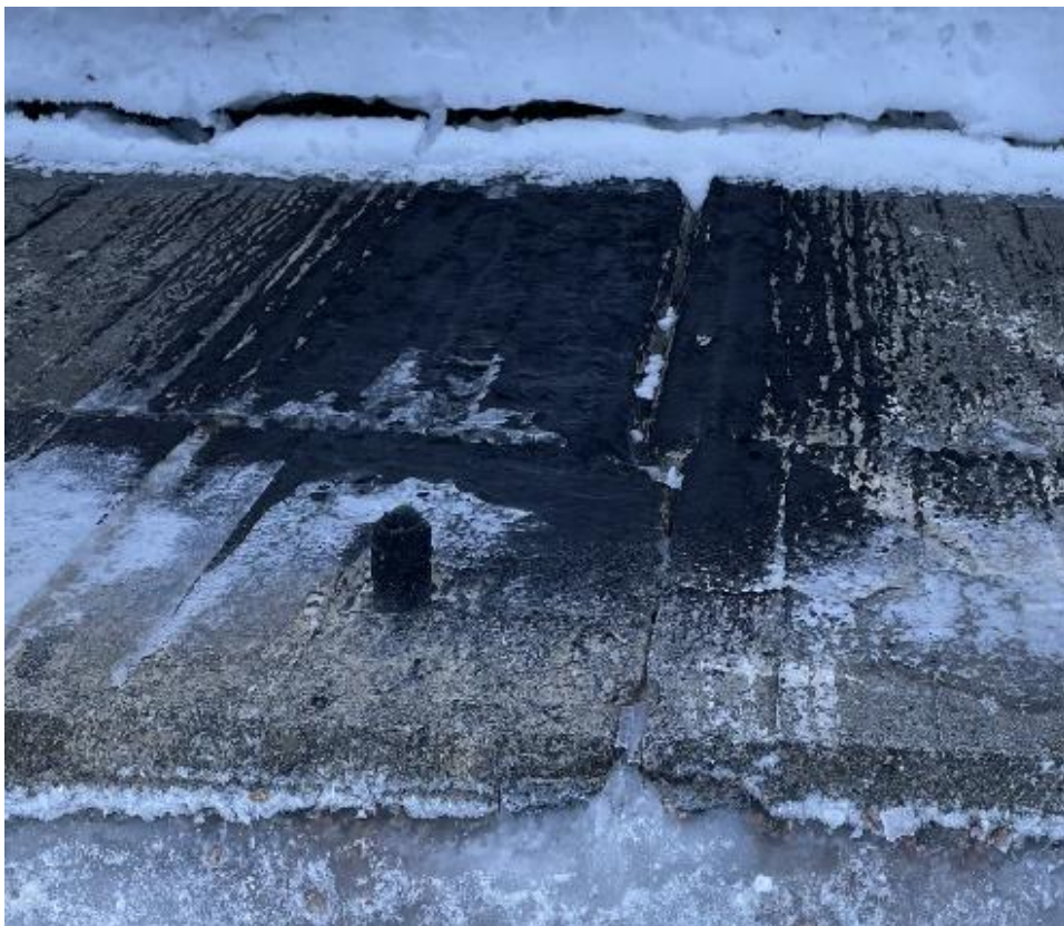
Figur 17. Bitumenläckage uppströms dammkropp. Bild från platsbesök.
