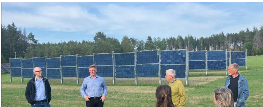
Figur 28. (var 16) Stående öst-väst placering av solceller i Västerås- Tack vare produktion av el från panelens båda sidor har anläggningen produceras mer el än den traditionella syd orienterade anläggningen som syns i bakgrunden till vänster. Foto: Nicholas Etherden 2023.
