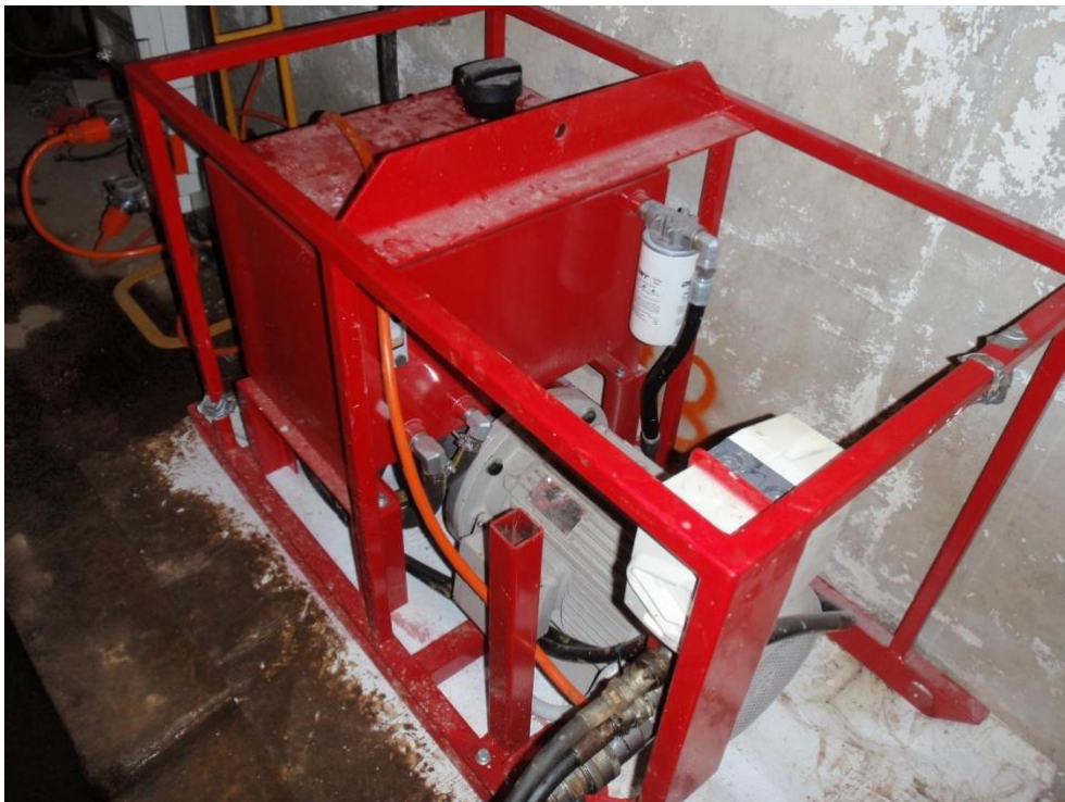
Figur 15. Elektrisk hydraulpump för drivning av borrhöggar. Denna placerades i vissa fall 100 m från borrhögen (Bild: Mulligan Geotechnical).
