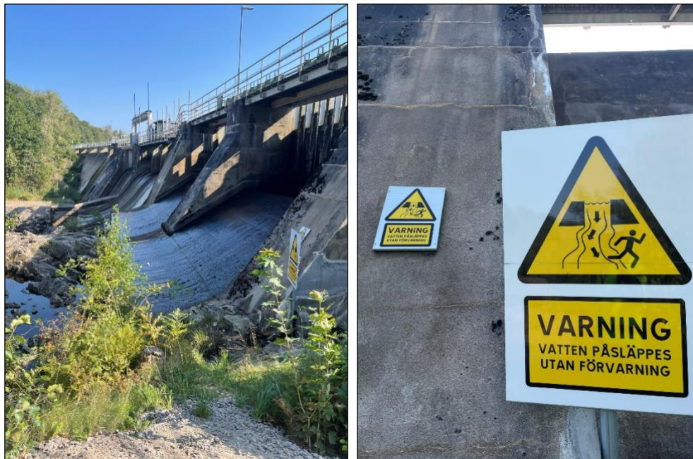
Figur 3. Exempel på otillfredsställande skyltning. Både skyltarnas storlek och placering lockar människor till det farliga området precis nedströms utskovsluckorna. Foto: Lisa Carlsson, Sweco.
