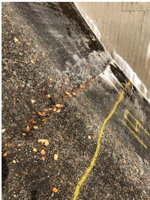
Figur 4 – Eroderad skibordsyta kring gjutfog med synliga armeringsstänger.
