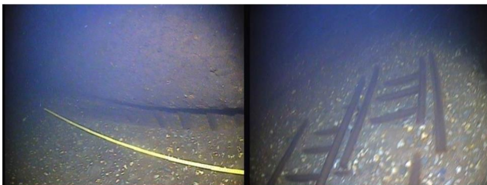
Figur 10 – Eroderad betongyta i energiomvandlingsbassängens botten. Den vänstra bilden visar bassängens botten vid utskovets vänstra vägg. Den högra bilden visar bottenytan i mitten av energiomvandlaren.
