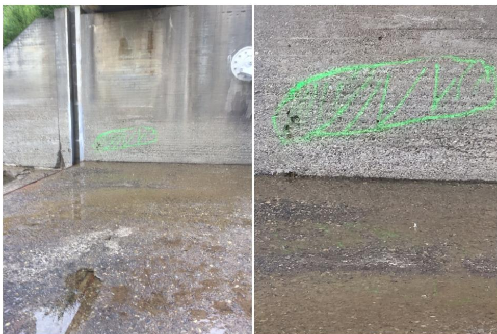
Figur 7 – Eroderad skibordsyta och anslutande pelare.
