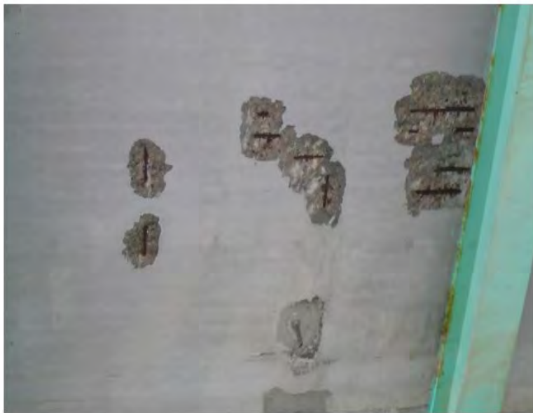
Figur 1. Partiella betongskador undersida brobaneplatta orsakade av armeringskorrosion, Älvsborgsbron.
