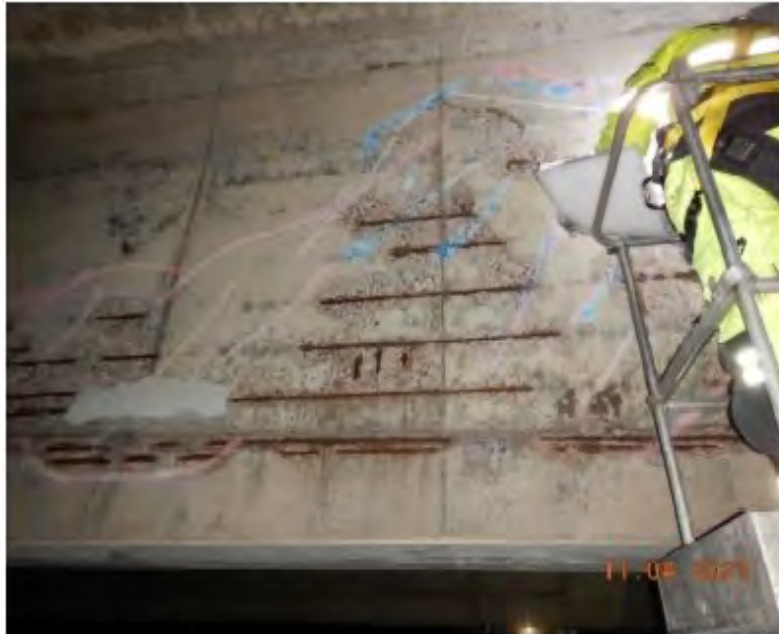
Figur 2. Partiella betongskador på huvudbalk orsakad av armeringskorrosion och karbonatisering, Ölandsbron.
