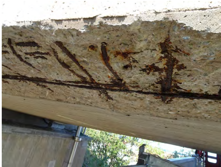
Figur 56. Betongskador på brolåda orsakad av kloridinditerad armeringskorrosion i karbonatiserad betong med ett tunt täckande betongskikt.
