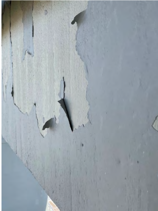
Figur 60. Färgen hade flagat i stora sjok på nordvästra sidan av brolådan
