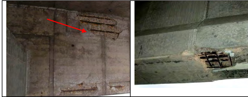
Figur 47. Exempel på partiella betongskador (spjälkning) på grund av korrosions-angrepp på armeringsstål i kombination med för tunna täckande betongskikt (se röd pil).
