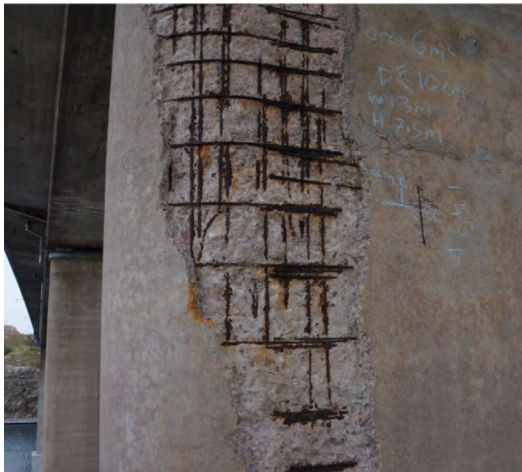
Figur 57. Betongskador på bropelare orsakad av kloridinditerad armeringskorrosion i karbonatiserad betong med ett tunt täckande betongskikt.
