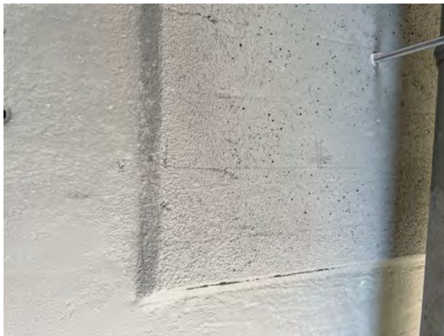
Figur 61. Partiellt reparerad betongskada med en djuphydrofobering och applicerat färgskikt. Inget färgsläpp har konstaterats vid den okulära besiktningen.
