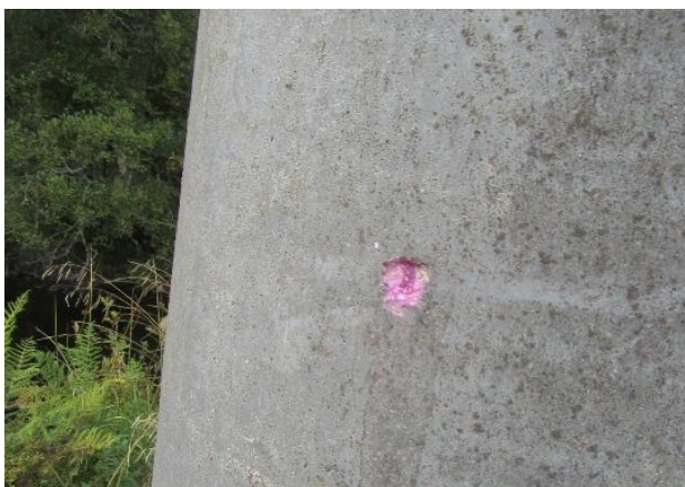
BILD 10. Mätning av karbonatisering i stolpens nedre del. Den rosa färgen tyder på att karbonatiseringsdjupet från ytan är ca 2 mm.
