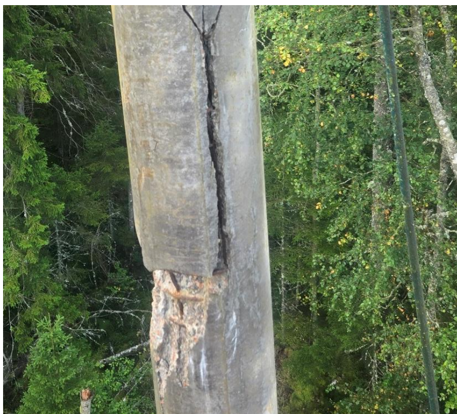
Figur 3. Stolpe med pågående armeringskorrosion (skadegrad = 4)
