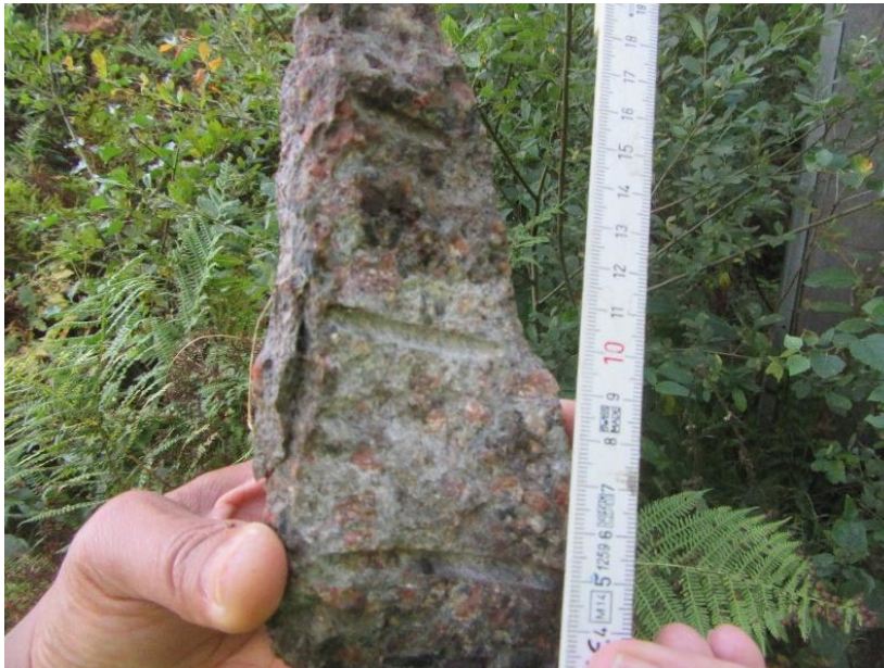
BILD 5. Spjälkad betongbit från stolpens övre del.
