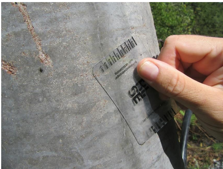
BILD 2. Mindre sprickor ca 0,2 mm bredd i stolpens nedre del.
