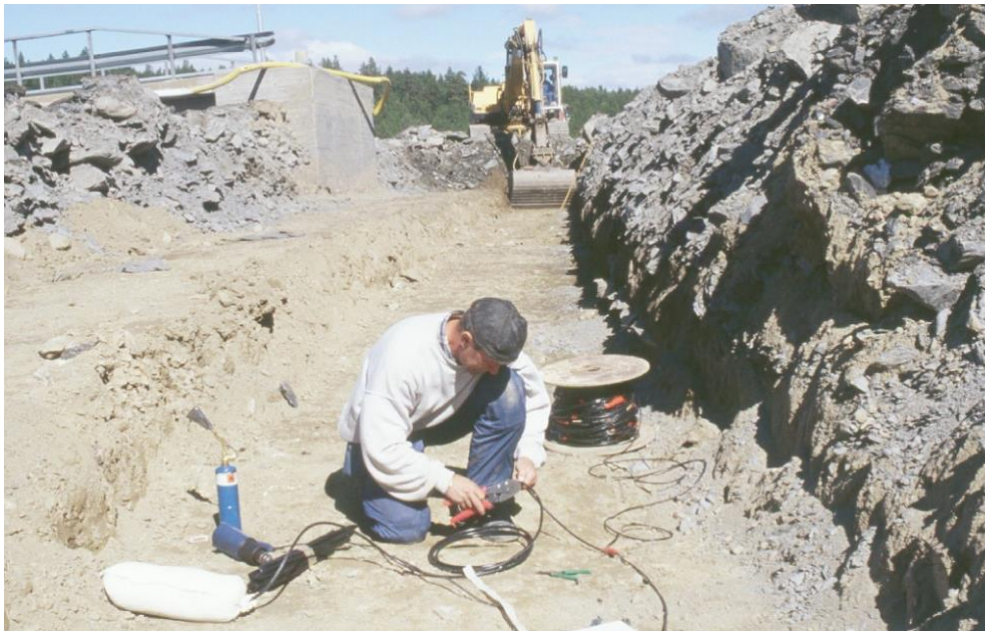
Figur 21. Elektrodupplägg i övre delen av Tåtkärnan i samband med höjning av dammkrönet för Dam 1 (foto: Torleif Dahlin).
