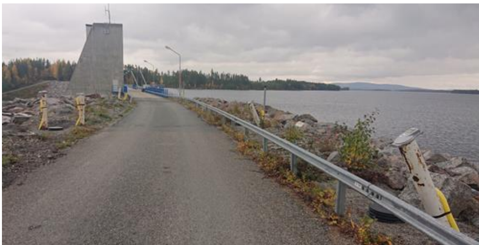
Figur 39. Exempel på grundvattenobservationsrör som har installerats i dammfilter, där röret som används för mätningarna är placerat inuti det synliga skyddsröret. Elektroder för ERT/DCIP torde kunna installeras med en teknik som bygger på samma typ av borrhning.
