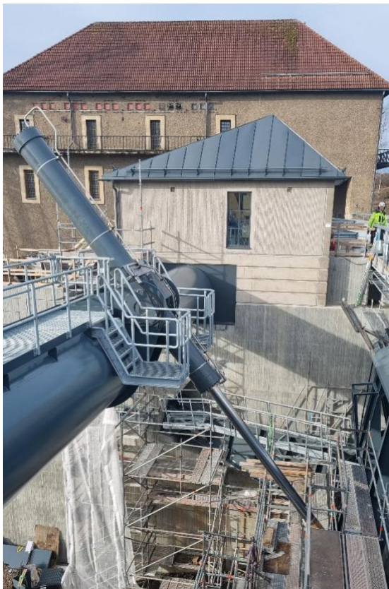
Figur 23. Exempel på centralt placerad hydraulcylinder för manövrering av en segmentlucka.
