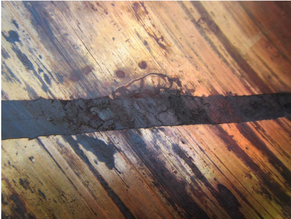
Figur 10. Detalj av lucklager med torkat smörjfett och skador i lagerytan.
