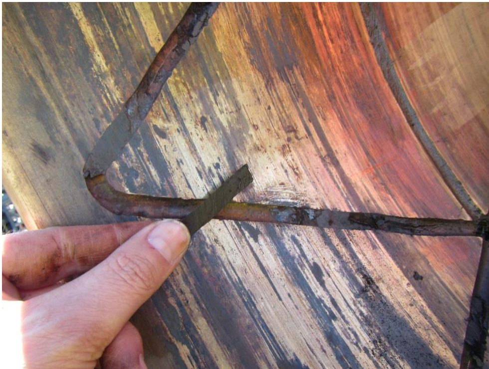
Figur 9. Exempel på ett lucklager med torkat smörjfett som blockerar smörjspåren i ett lucklager.
